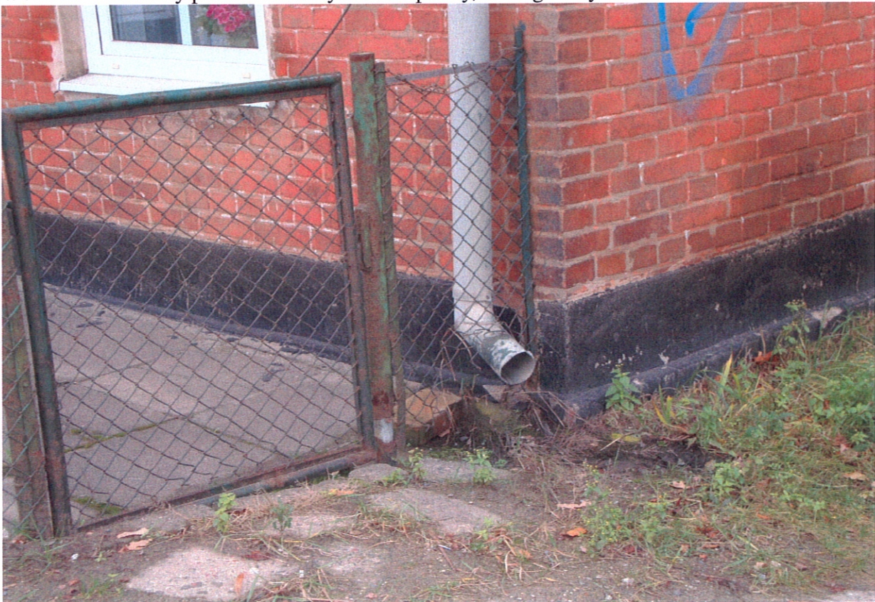
Fot. 8 Cokół przy lokalu nr 1 otynkowany i zabezpieczony masą bitumiczną, brak koryta u wylotu rury spustowej.
