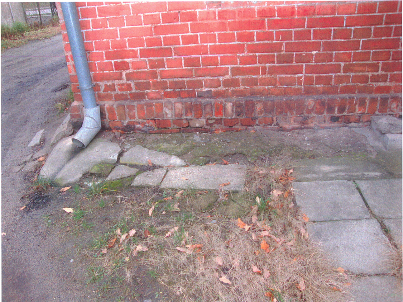
Fot. 7 Cokół od strony podwórza z ubytkami zaprawy, zawilgocony.
