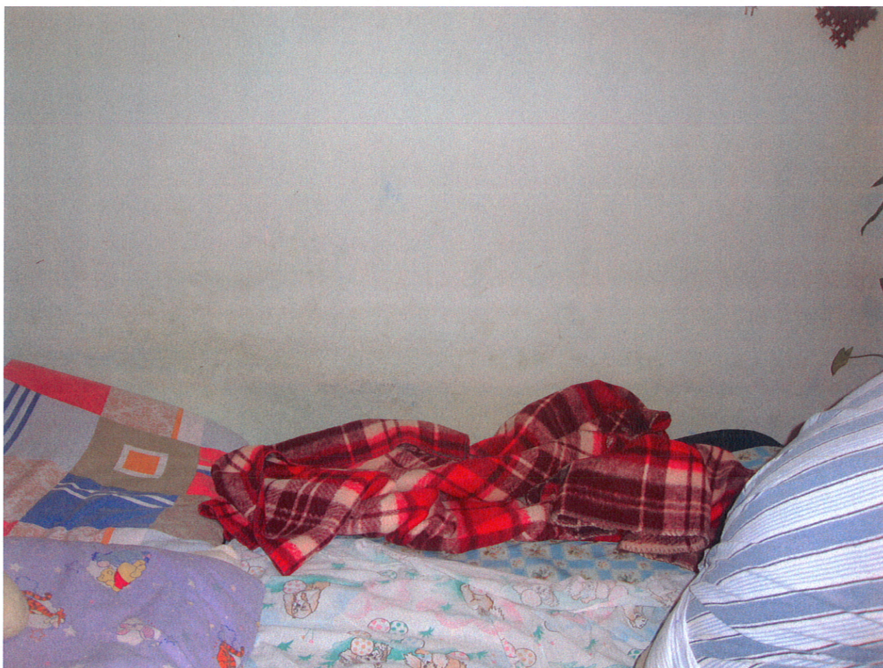
Fot. 11 Zawilgocenie na ścianie szczytowej w lokalu nr 2.
