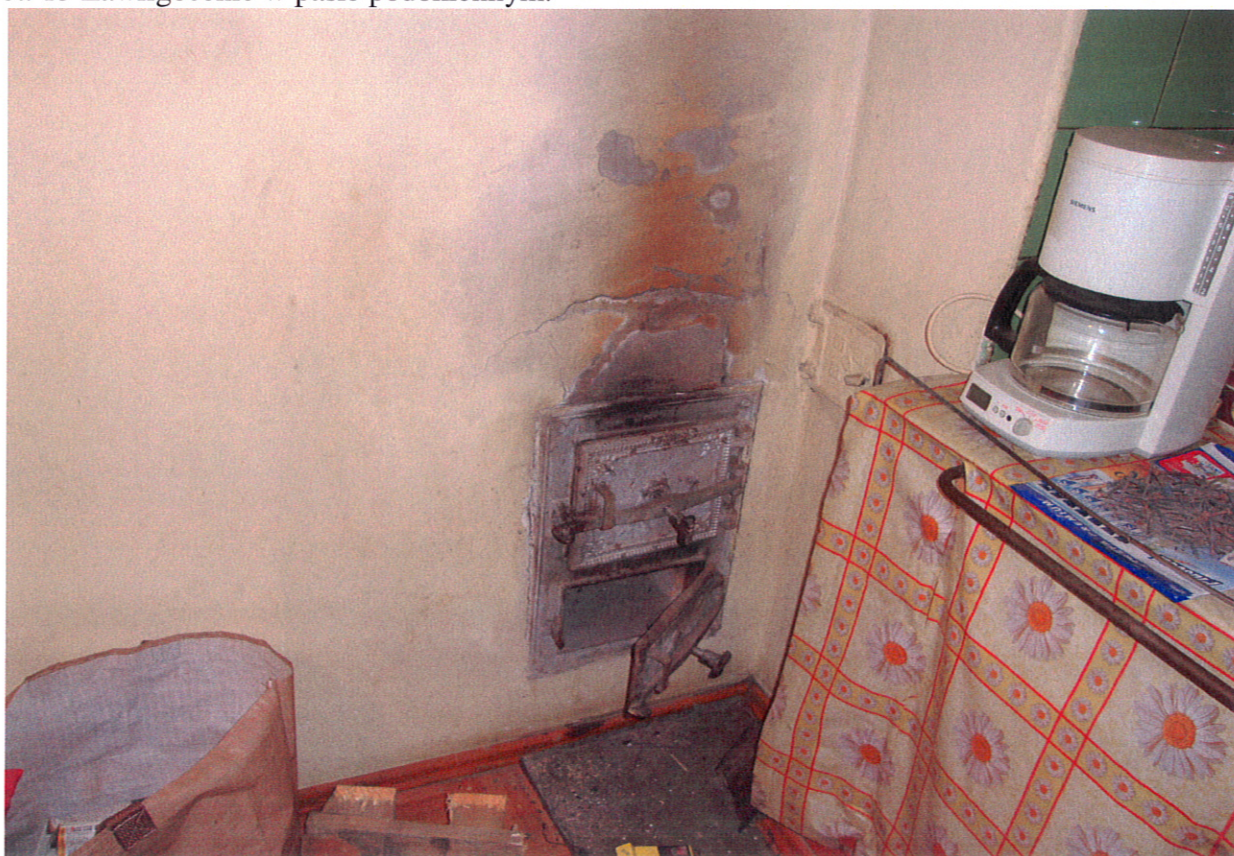
Fot. 14 Kuchnia w lokalu nr 4 – pęknięcia ściany nad drzwiczkami.
