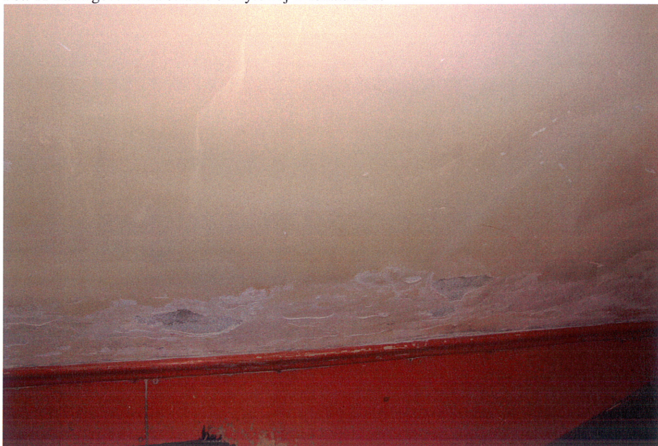
Fot. 12 Zawilgocenie na ścianie szczytowej w lokalu nr 4.
