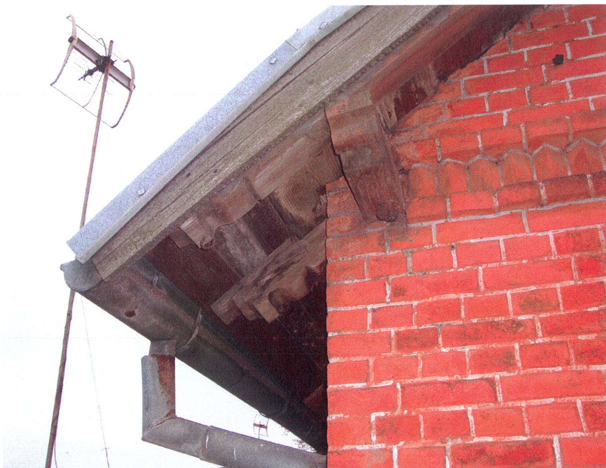
Fot. 5 Wieżba – widoczne zawilgocenie krokwi i murlaty, źle wykonane obróbki blacharskie.
