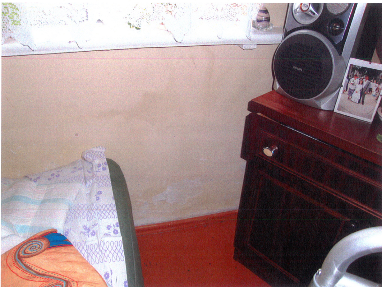
Fot. 13 Zawilgocenie w pasie podokiennym.
