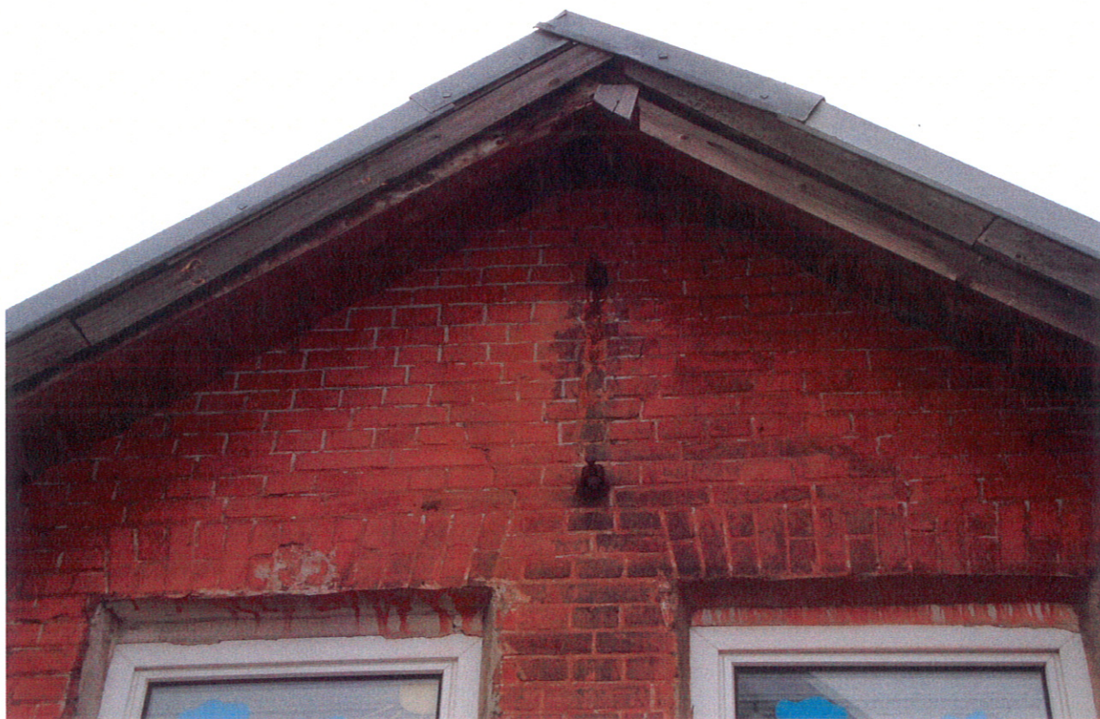
Fot. 6 Wieżba – uszkodzenie skrajne krokwi w kalenicy.
