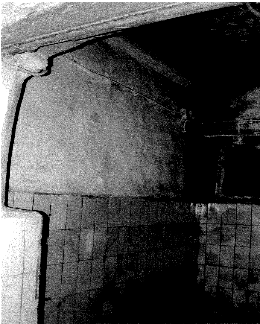
Fot. 16 Parter – zagrzybienie ścian i stropu.
