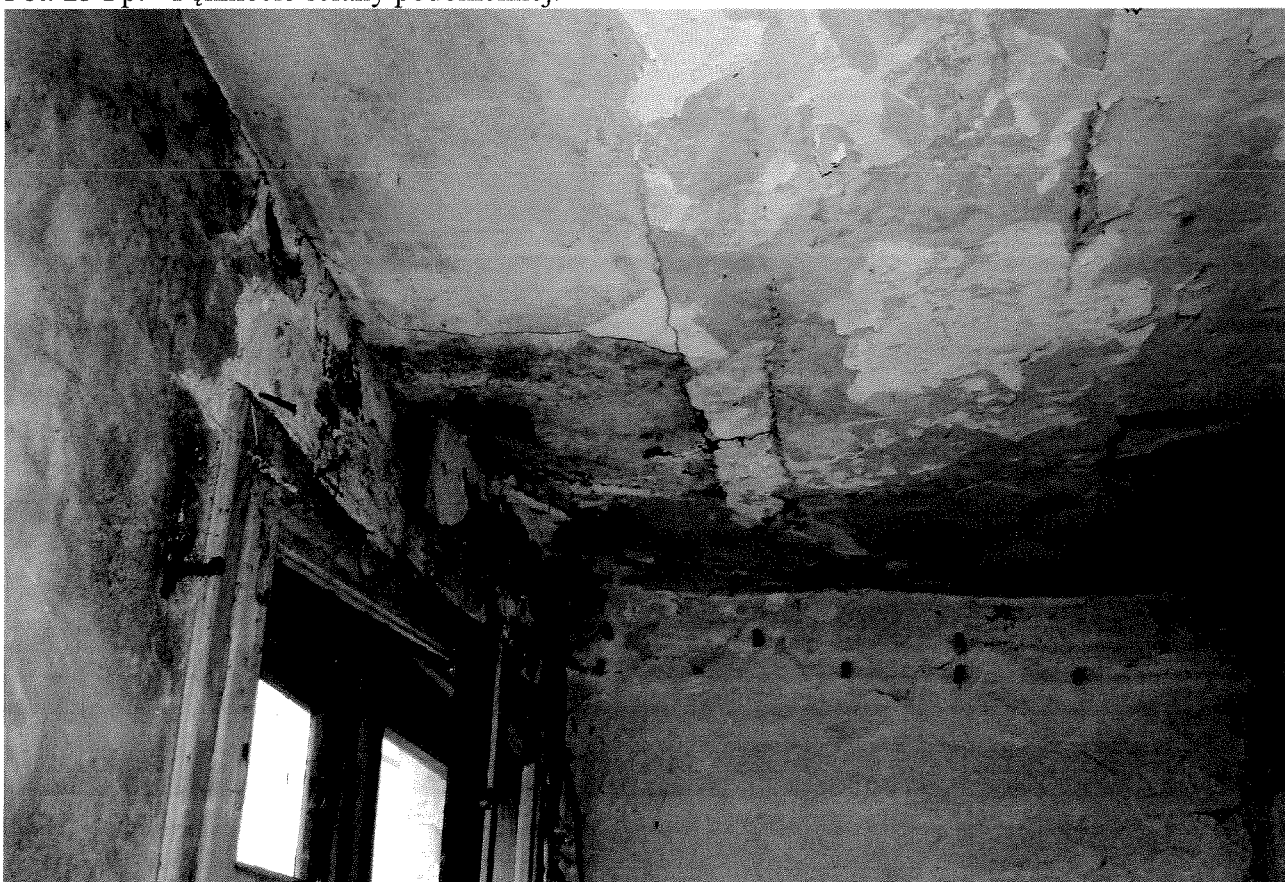
Fot. 24 I p. - Ugięcie i pęknięcie stropodachu.
