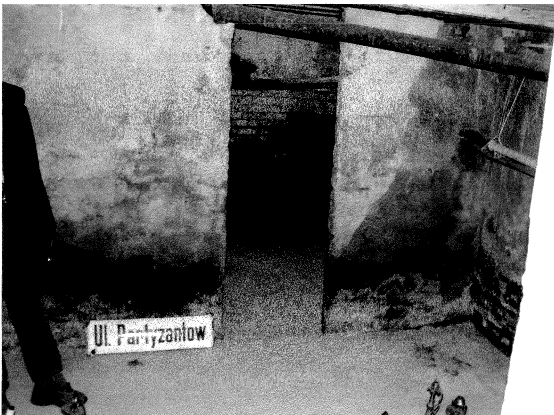
Fot. 9 Piwnica – ściany zagrzybione.
