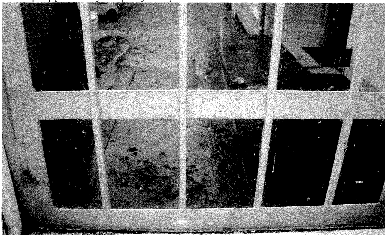
Fot. 7 Stropodach nad częścią parterową – nierówności i uszkodzenia papy.
