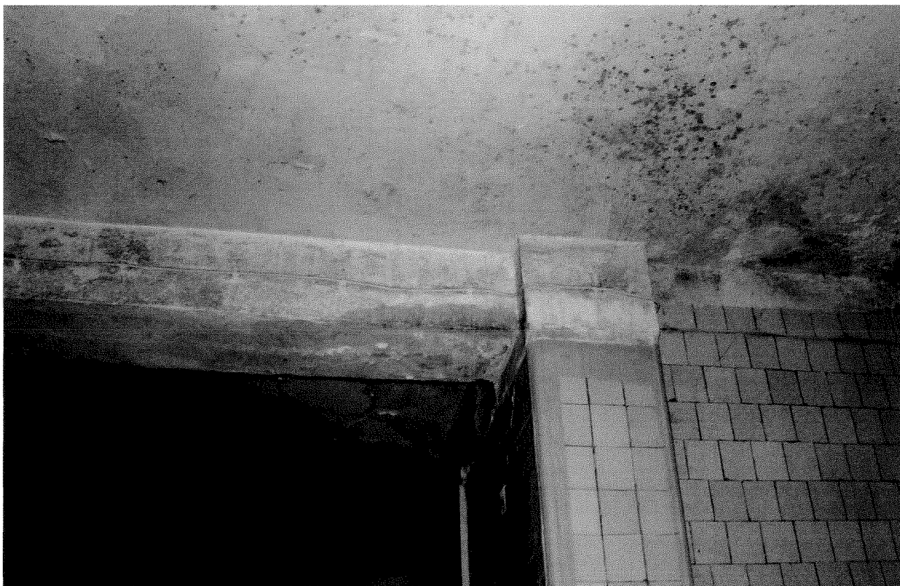
Fot. 12 Parter – zagrzybienie i zacieki na stropie, pęknięcie ściany i podciągu
