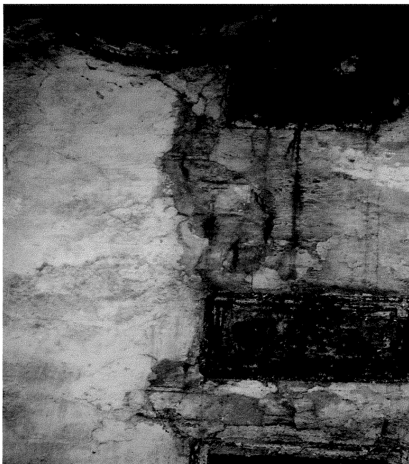
Fot. 21 Parter – pęknięcie komina.
