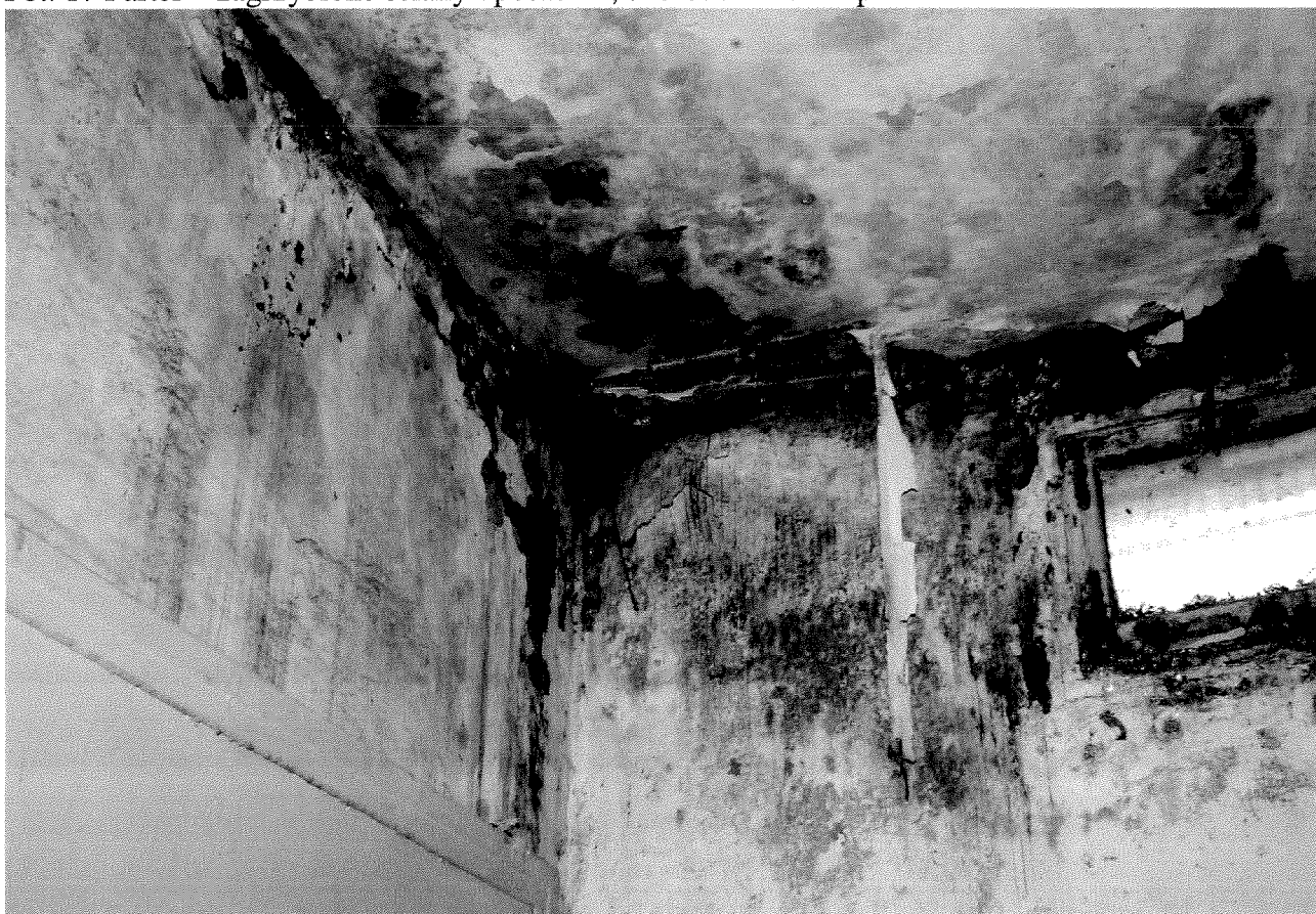
Fot. 18 Parter – ugięcie i zagrzybienie stropu, zagrzybienie ścian.
