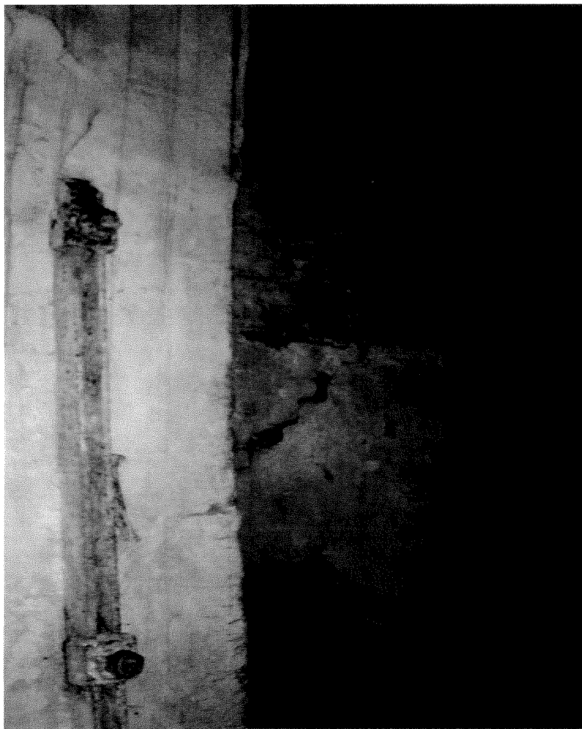
Fot. 14 Parter – pęknięcie ściany.
