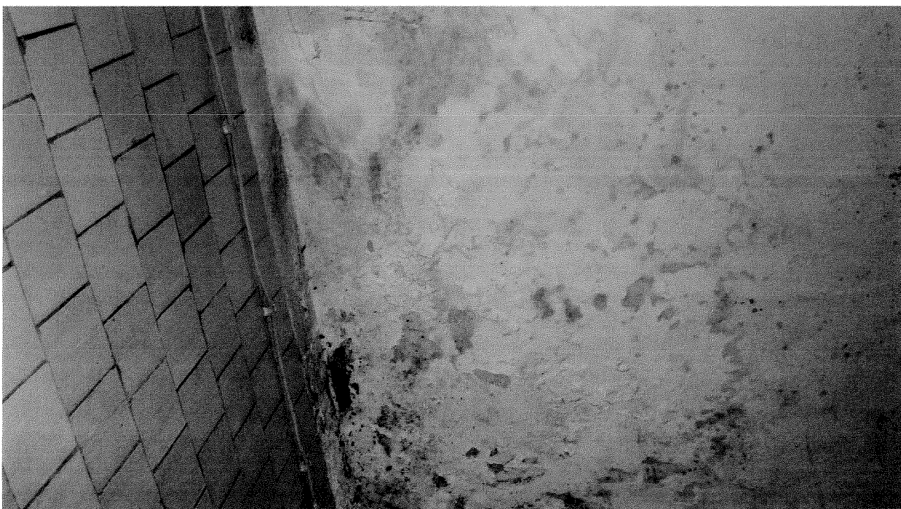
Fot. 13 Parter – zagrzybienie i zacieki na stropie.
