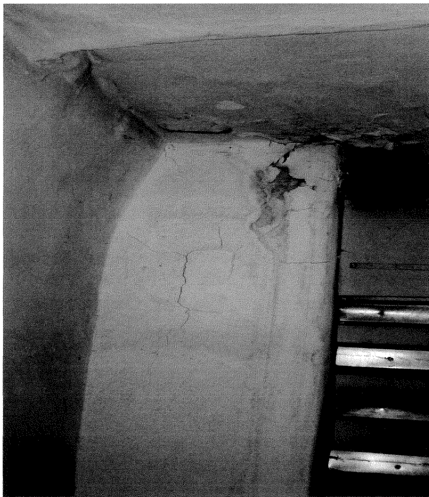
Fot. 25 I p – pęknięcie filara, zacieki ze stropodachu.
