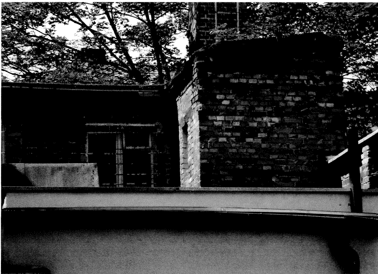
Fot. 6 I p.- spękanie i ubytki zaprawy w wiązaniu muru.
