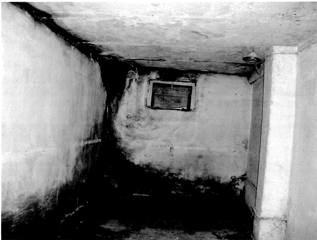
Fot. 19 Parter – ugięcie stropu, zagrzybione pomieszczenie.
