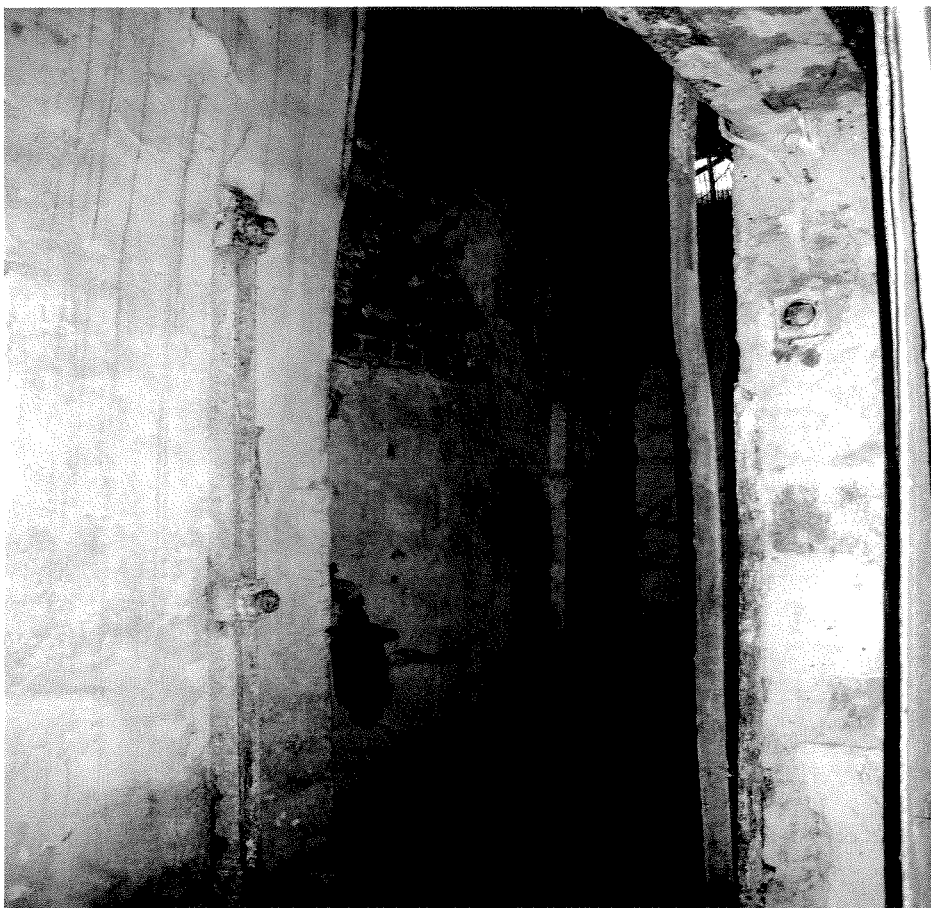
Fot. 17 Parter – zagrzybione ściany i posadzki, skorodowane nadproże.
