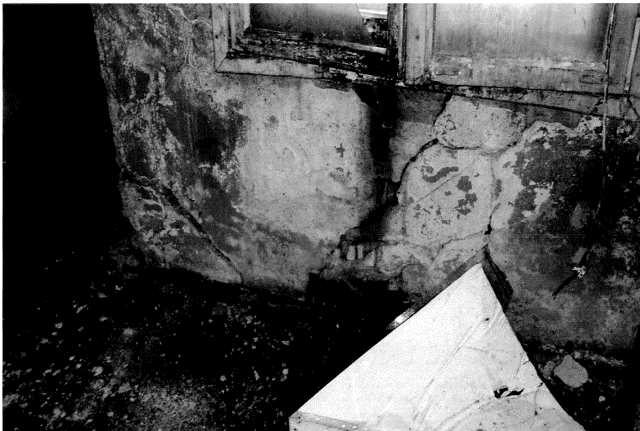
Fot. 23 I p. - Pęknięcie ściany podokiennej.
