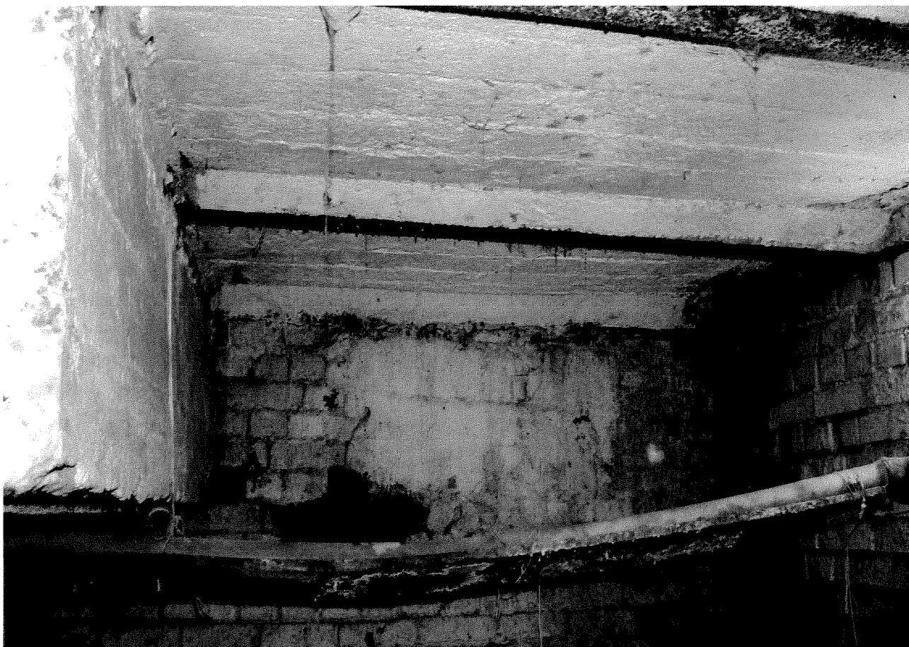
Fot. 8 Piwnica – strop na belkach stalowych, skorodowanych
