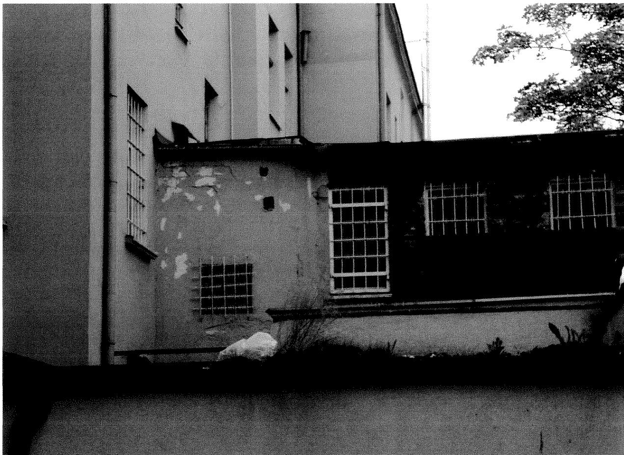
Fot. 5 I p. - widoczne spękanie muru.
