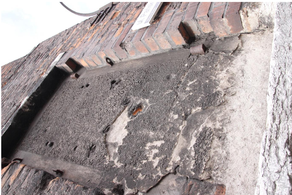
fot. 19 Wnęka okienna. Widoczne uszkodzenia tynku oraz czarne nawarstwienia powierzchniowe pochodzenia atmosferycznego.
