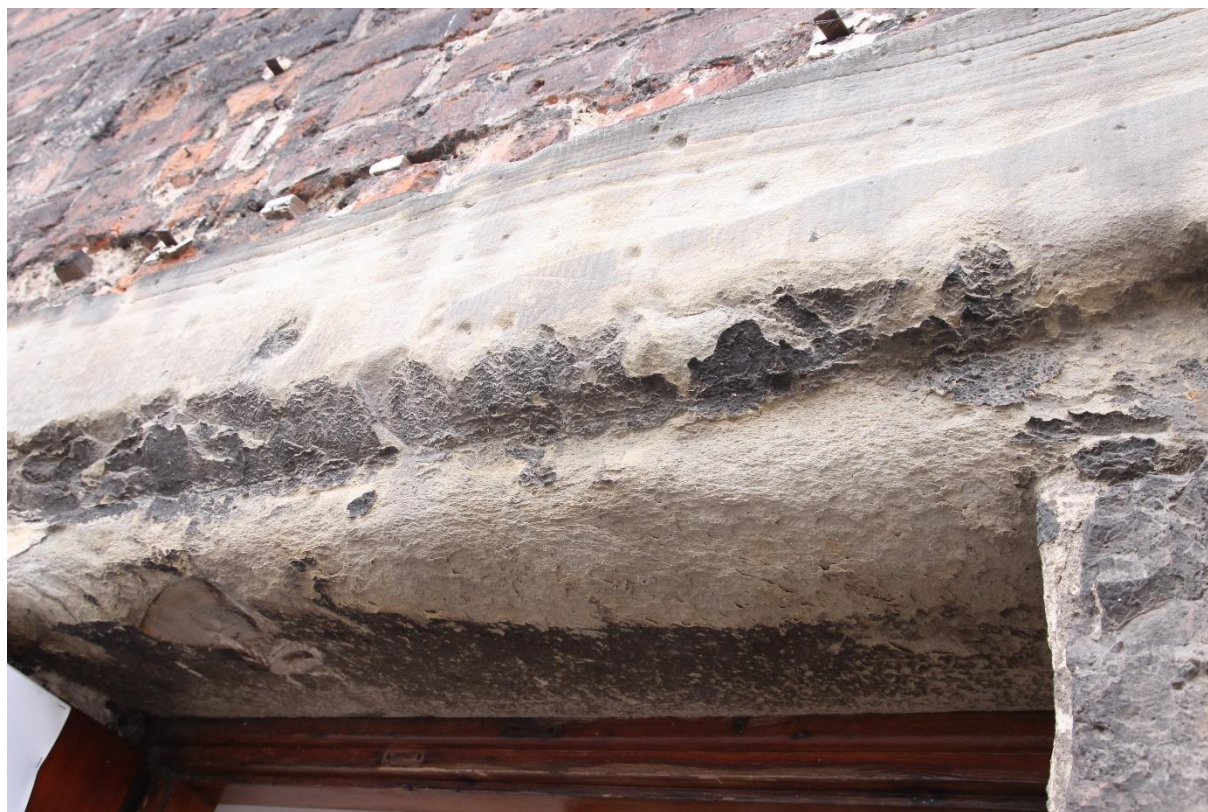
fot. 16 Widoczne zniszczenia elementów kamiennych portalu.
