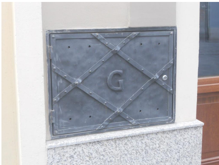
fot. 34 Przykład wykonania skrzynki energetycznej współgrającej z charakterem budowli zabytkowej.
