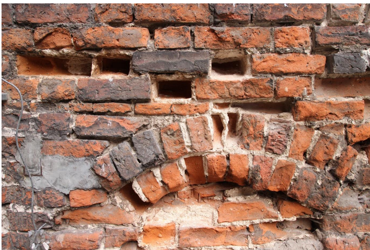
fot. 8 Widoczne zniszczenia muru: czarne nawarstwienia i zniszczenia cegły oraz zapraw spoinujących; głębokie ubytki cegieł przy jednoczesnym zachowaniu spoin, świadczącym o większej wytrzymałości spoin; wtórne naprawy zaprawami o spoiwie cementowym.
