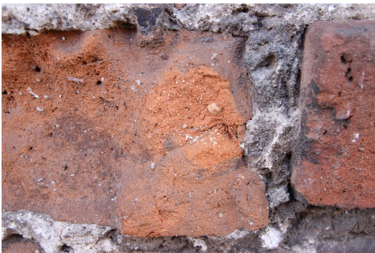
fot. 10 Widoczne białe wykwity soli w porach kamienia powodujące dezintegrację struktury cegły i w efekcie jej osypywanie.
