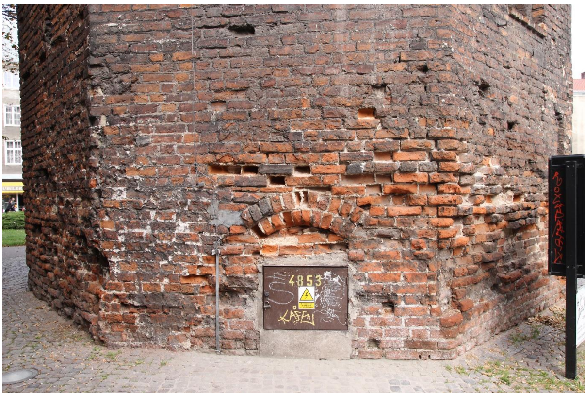
fot. 7 Widok na ścianę południową, stan obecny, widoczna nieestetyczna skrzynka energetyczna oraz zniszczenia lica muru.
