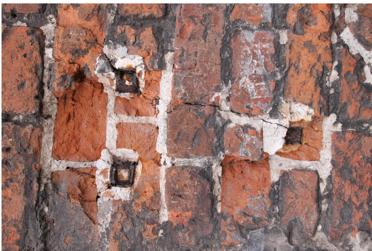
fot. 12 Widoczne pęknięcie muru powstałe na skutek rozsadzania materiału wywołanego przez korodujące elementy w murze.
