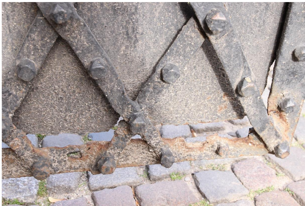
fot. 18 Zniszczenia metalowej konstrukcji kutych drzwi wejściowych: widoczna korozja wżerowa do 100% przekroju materiału.
