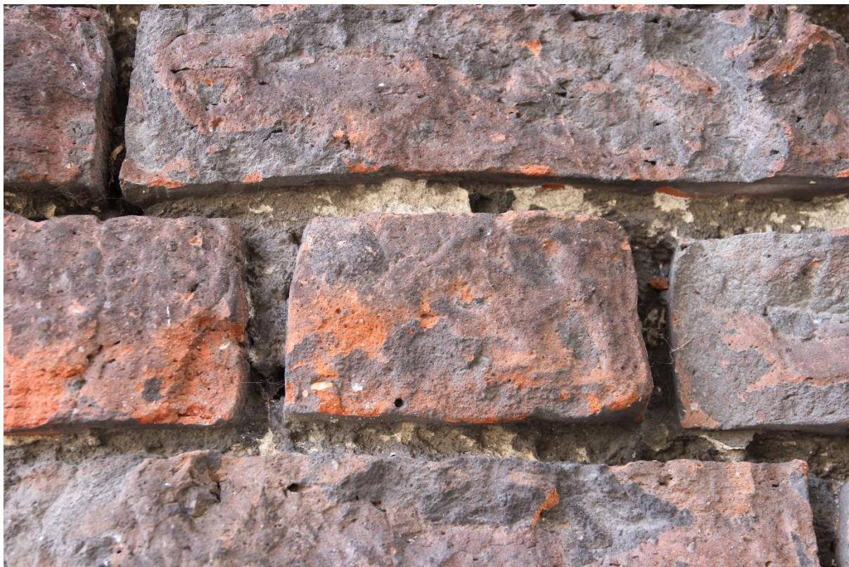
fot. 9 Widoczne czarne nawarstwienia na powierzchni muru ceglanego oraz ubytki cegły i spoin.
