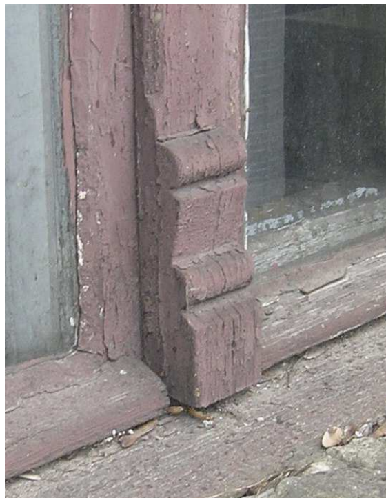
Fot. Kształt bazy i śłemia słupka okiennego
