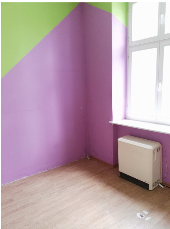
Pokój – ogrzewanie elektr.
