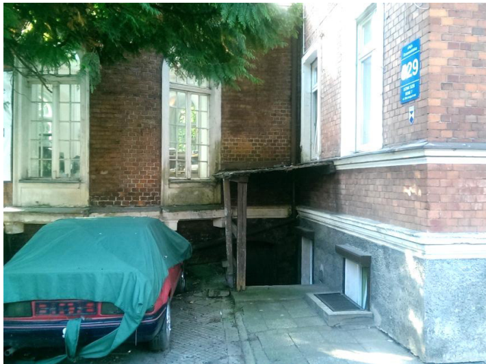
Fot. 2 Nieużytkowane wejście do piwnicy od strony wschodniej elewacji południowej
