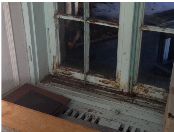
Fot. nr 78: Okno rotundy w widoku od wewnątrz pomieszczenia. Zniszczenia parapetu i konstrukcji skrzydeł spowodowane zalewaniem od zewnątrz
