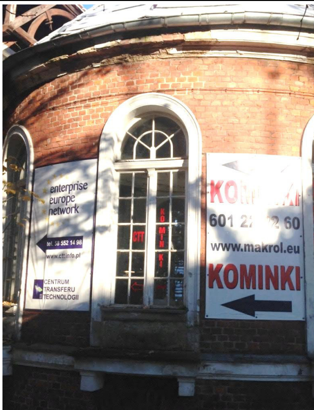
Fot. nr 40: Ściana rotundy. Widoczne są uszkodzenia gzymsu, cegieł muru oraz opaski okiennej i parapetu spowodowane przez wylewanie się wody opadowej z rozszczelnionej rynny bezpośrednio na mur
