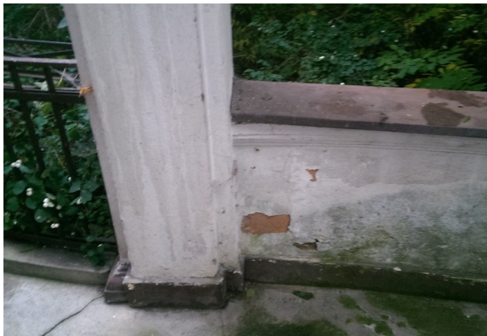
Fot. 58 Zawilgocenie i ubytki tynku – balustrada tarasu
