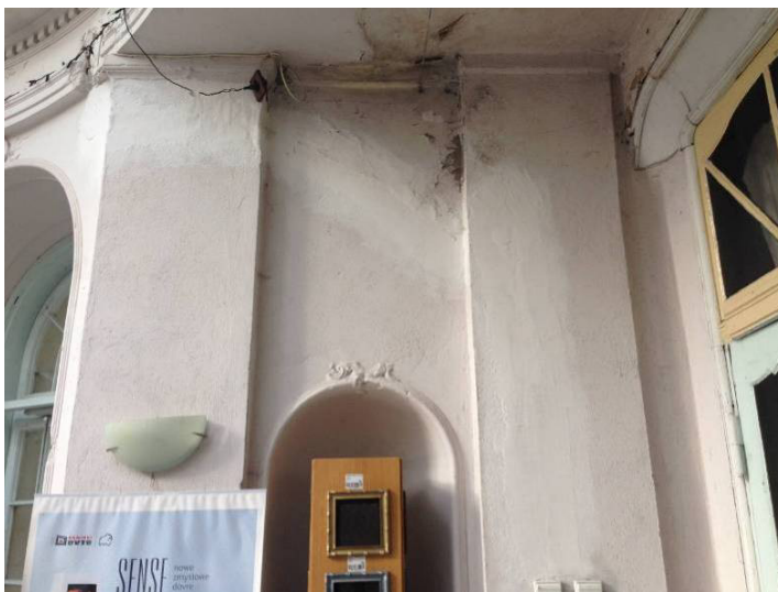
Fot. nr 38-39: Ściany boczne łącznika – widoczne ślady po zalewaniu stropu
