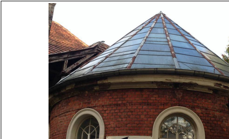
Fot. nr 26: Widok z zewnątrz na zadaszenie nad rotundą, widoczne są uszkodzenia gzymsu zewnętrznego spowodowane nieszczelnością opierzenia i rynny
