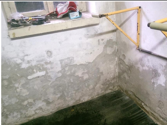
Fot. 65 Zawilgocenie ścian wewnętrznych w piwnicy
