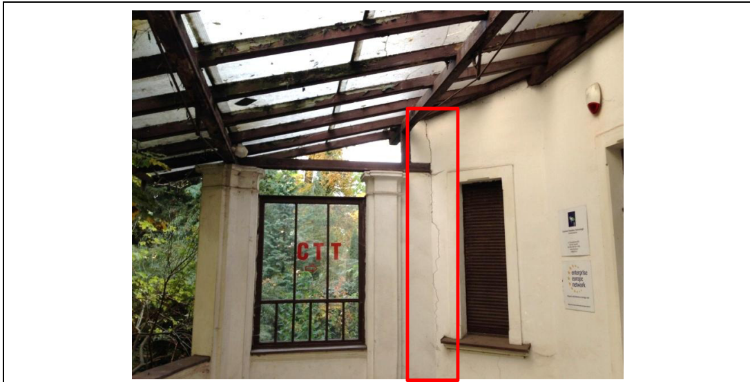
Fot. 60 Taras – widoczne pęknięcie (odspojenie) ściany dostawionej do budynku
