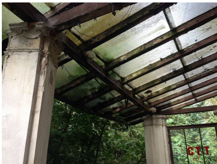
Fot. nr 52: Widok zniszczonych słupów wsporczych i mokrej konstrukcji drewnianej
