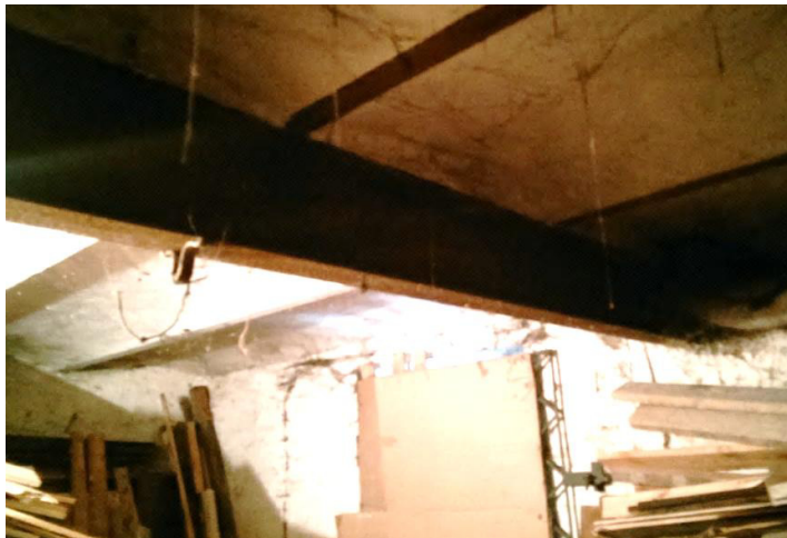
Fot. 61 Piwnica – strop typu Kleina- korozja powierzchniowa belek stalowych
