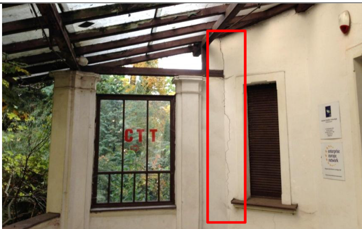
Fot. 16 Elewacja zachodnia. Rysa między dostawionym murem a budynkiem głównym (odspojenie)
