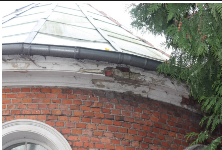
Fot. 6 Ubytki w gzymsie rotundy spowodowane nieuszczelnnością rynien
