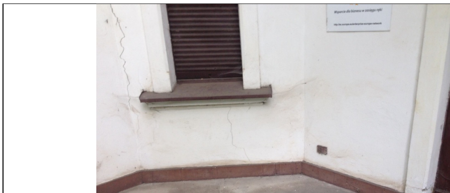
Fot. 17 Elewacja zachodnia. Rysy w strefie okiennej
