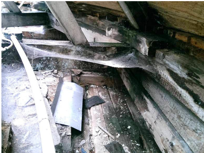
Fot. nr 36: Przestrzeń dachu nad łącznikiem. Widoczna jest zawilgocona więźba. Fragmenty opierzenia, kawałki papy mogą świadczyć o próbach naprawy tego fragmentu dachu, jednak bez powodzenia. Mokre jest drewniane poszycie stropu nad łącznikiem. Prawdopodobne są także zniszczenia biologiczne, o czym świadczyć mogą liczne pajęczyny. Zniszczenia w tynku stropu spowodowane zalewaniem widoczne są na fot. nr 66
