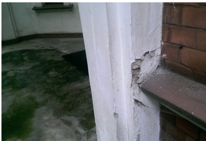
Fot. 59 Ubytki tynku – elewacja przy tarasie
