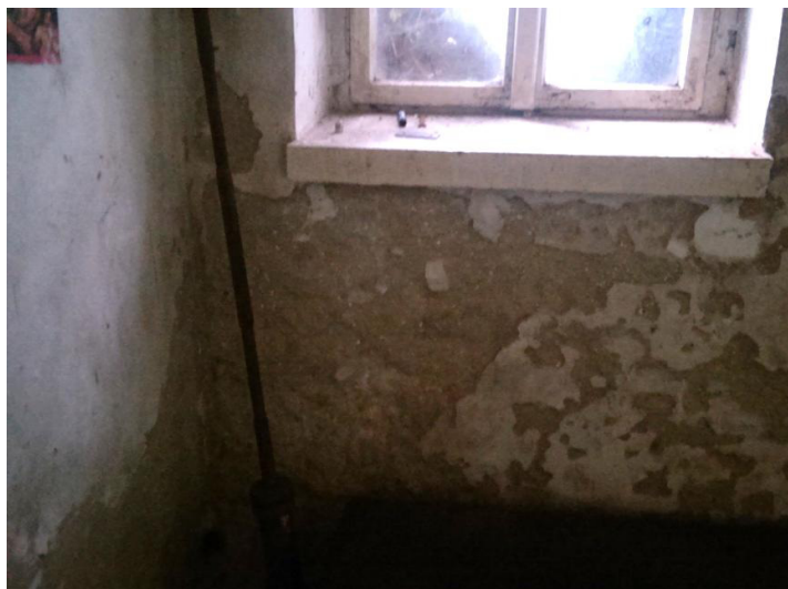
Fot. 67 Zawilgocenie ścian wewnętrznych w piwnicy
