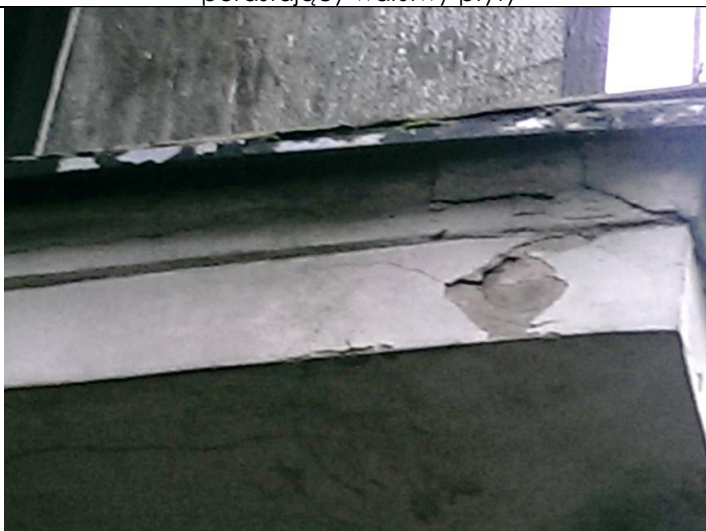
Fot. 15 Uszkodzony narożnik płyty balkonowej
