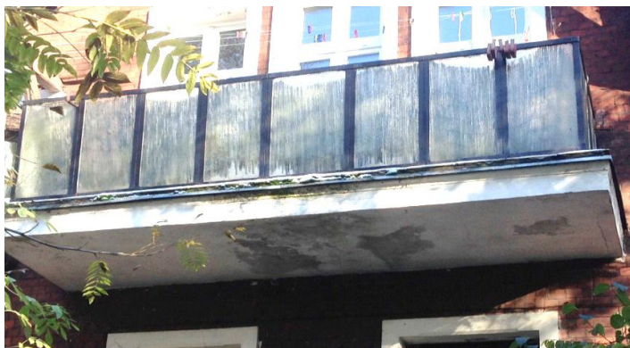
Fot. 14 Elewacja zachodnia – ubytki wyprawy na płycie balkonowej, widoczny mech porastający warstwę płyty
