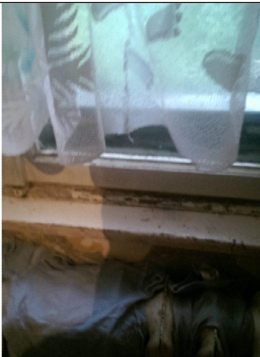
Fot. 81 Stan stolarki okiennej w mieszkaniu nr 3
