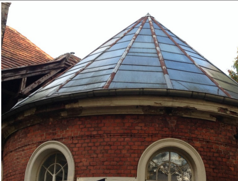
Fot. nr 41: Ściana rotundy. Widoczne są liczne uszkodzenia gzymsu i cegieł muru spowodowane nieszczelnością opierzenia i rynny
