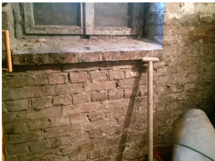
Fot. 68 Dobry stan techniczny konstrukcji ceglanej ścian pomimo ich zawilgocenia
