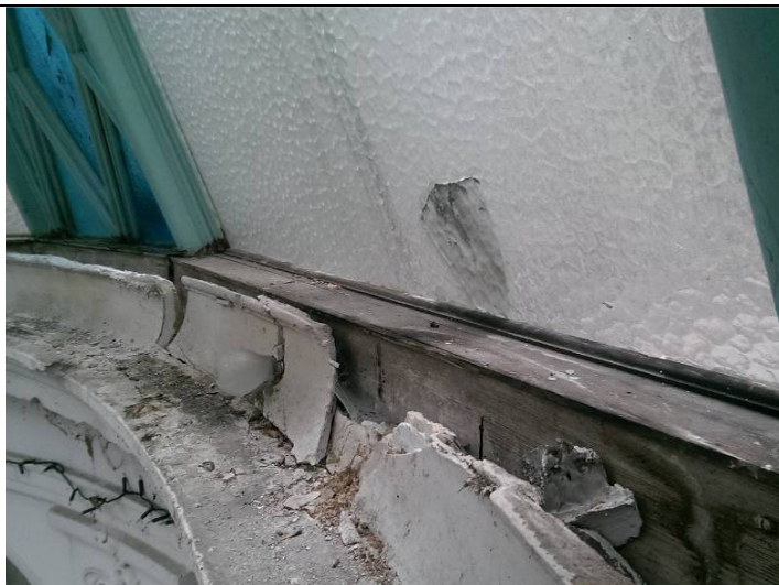
Fot. nr 30: Górna płaszczyzna półki gzymsu. Widoczna jest degradacja ozdobnej blendy wykonanej z gipsu wzmocnionego warstwą juty oraz zniszczenia pierwszej, wewnętrznej murłaty spowodowane nieszczelnością pokrycia zewnętrznej warstwy dachu i opierzenia
