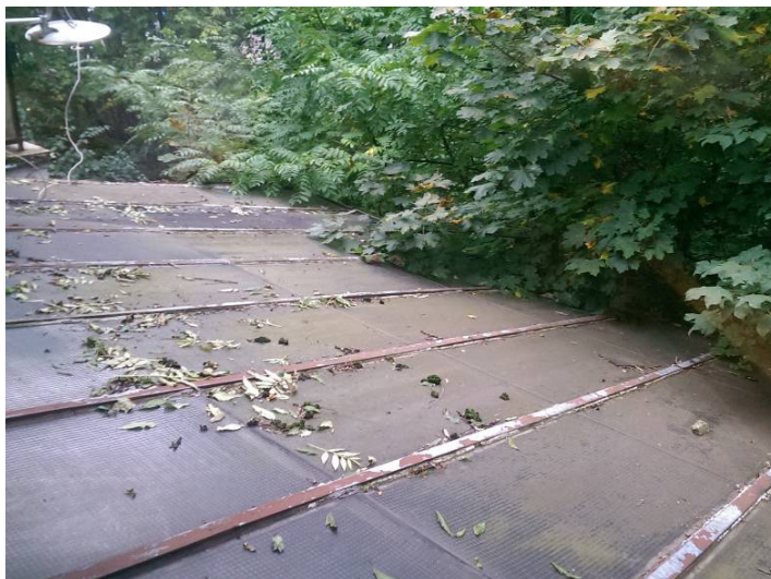
Fot. nr 54: Góra dachu nad tarasem. Widoczne nieszczelne maskownice połączenia tafli szklanych oraz roślinność wspinająca się po dachu
