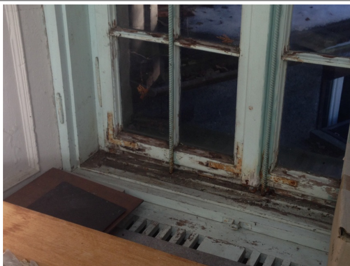
Fot. nr 45: Okno rotundy z fot. nr 43 i 44 w widoku od wewnątrz pomieszczenia. Zniszczenia parapetu i konstrukcji skrzydeł spowodowane zamakaniem od zewnątrz
