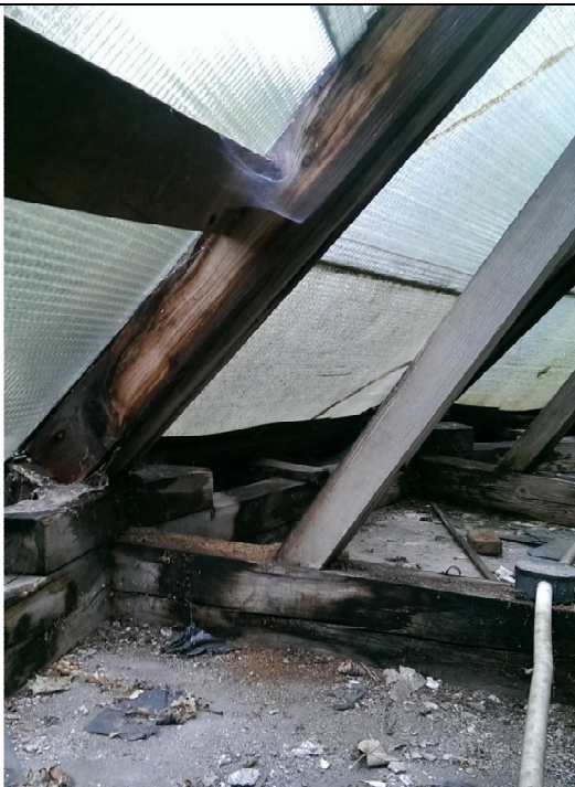
Fot. 29 Konstrukcja dachu rotundy – zmurzałe elementy więźby dachowej. Widoczna jest zawilgocona więźba – krokiew, murłata, podwaliny. Resztki papy stanowiącej izolację poziomą nie chronią drewna przed zniszczeniem powodowanym nieszczelnością pokrycia zewnętrznej warstwy dachu i opierzenia
