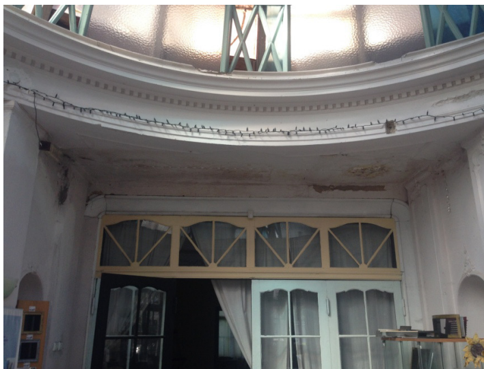
Fot. nr 37: Strop nad łącznikiem, poniżej przestrzeni widocznej na zdjęciach 63-65. Wg informacji użytkownika – po każdym mocniejszym lub długotrwałym opadzie deszczu woda spływa poprzez strop do wnętrza rotundy.
