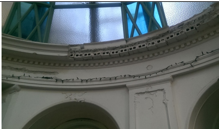
Fot. 28 Wewnętrzna ozdobna kopuła w rotundzie – ubytki w gzymsie
