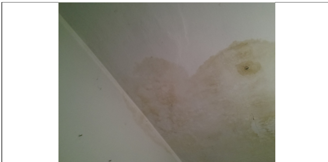
Fot. 24 Zacieki spowodowane nieszczelnością pokrycie hełmu na ryzalicy – pokój 5/1
