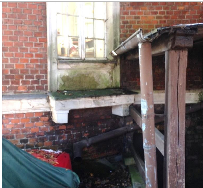
Fot. nr 43: Ściana i okno rotundy. Widoczne jest permanentne zamoczenie muru spowodowane nieprawidłowym odprowadzeniem wody z dachu głównego i z nad łącznika. Wody spływają po murze łącznika na daszek nad zejściem do piwnicy, następnie z impetem wpadają do rynny wzdłuż tego daszka. Rynna ta jest nieprawidłowo nachylona, skutkiem tego jest woda wylewająca się z niej tuż przy opasce okiennej. Widoczne jest zniszczenie opaski i ściany podparapetowej wraz z parapetem i murem pod gzymsiem dolnym. Dodatkowo wody z rury spustowej wylwane są na grunt zbyt blisko ściany rotundy i to powoduje jej zamakanie od dołu.
