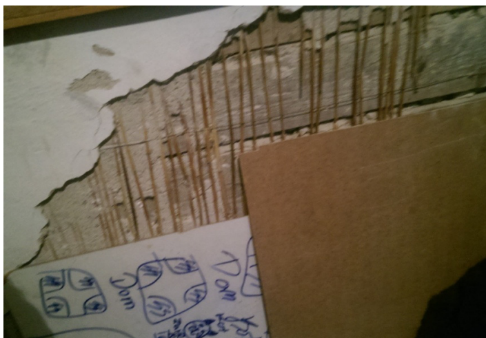
Fot. 75 Ubytki w tynku w pomieszczeniach mieszkania nr 4
