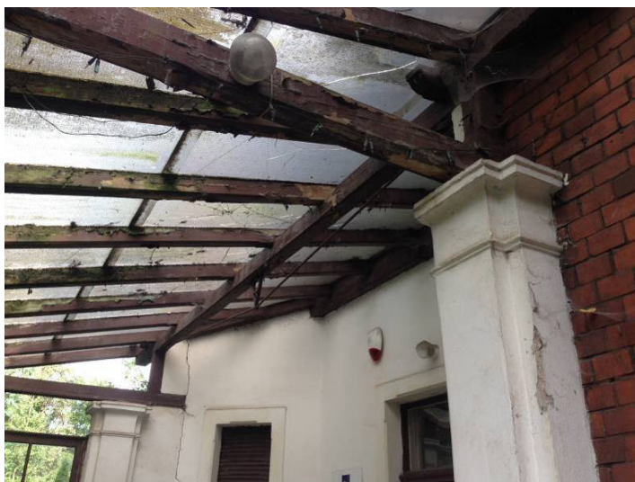
Fot. nr 50-51. Widoczne mokre i zniszczone belki konstrukcji wsporczej dachu oraz spękaną tafle szkła
