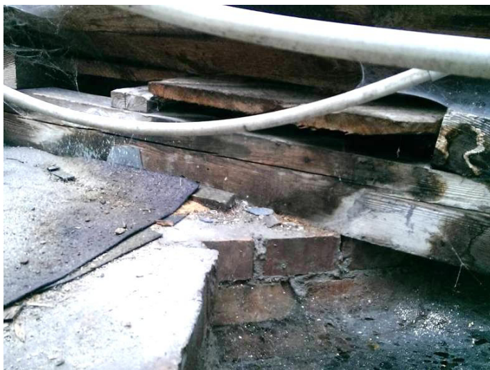
Fot. 34-35. Konstrukcja dachu rotundą – zmurzałe elementy więźby dachowej – strefa łącznika. Przestrzeń między dwoma dachami w miejscu łączenia płaskiego zadaszenia nad łącznikiem i dachu nad rotundą. Widoczna jest zawilgocona więźba – krokwie, murłaty, podwaliny i inne drewniane elementy. Mokre jest także drewniane poszycie stropu nad łącznikiem. Woda poprzez nieszczelności pokrycia papowego wnika do wnętrza tej przestrzeni i dalej przenika przez warstwy wykończeniowe stropu nad łącznikiem. Zniszczenia w tynku widoczne są na fot. nr 38-39
