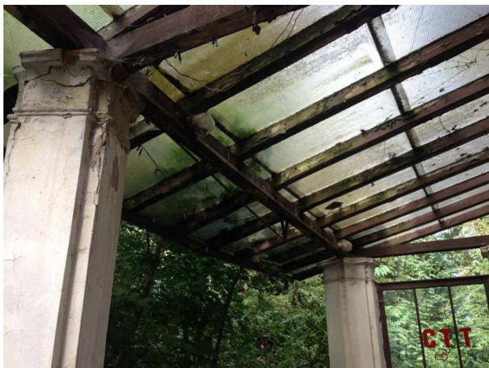
Widok zniszczonych słupów wsporczych i mokrej konstrukcji drewnianej
