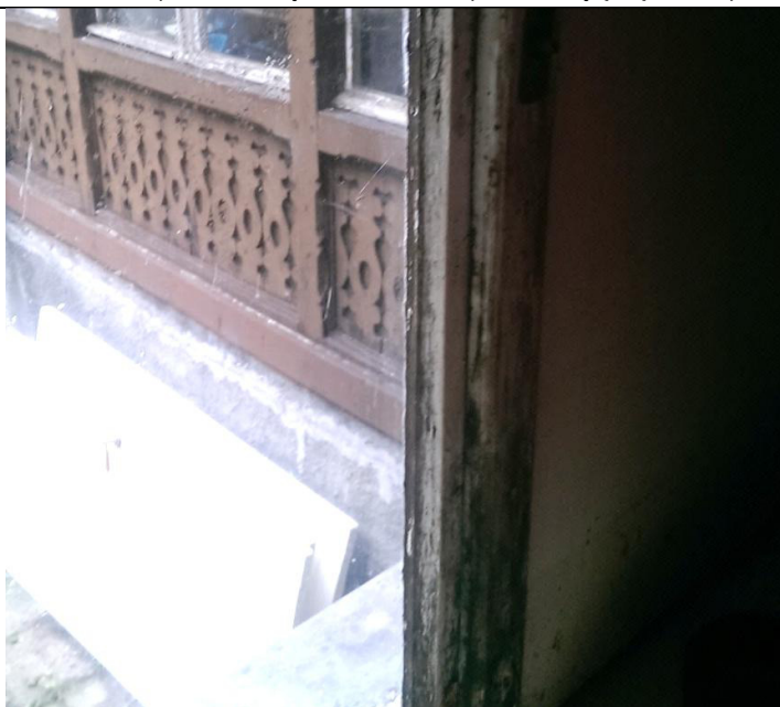
Fot. 80 Stan stolarki okiennej w mieszkaniu nr 1
