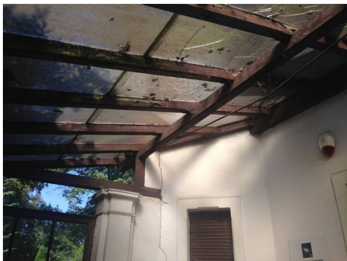
Fot. nr 49: Widoczne odspojenie muru i spękane, nieszczelne tafle szkła zbrojonego
