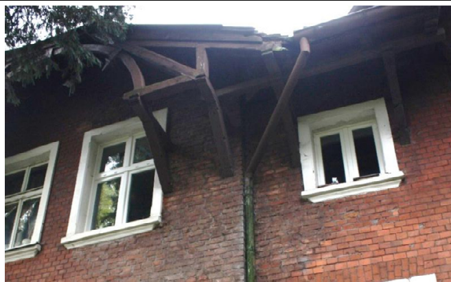
Fot. 11 Elewacja północna- zniszczenia więźby dachowej, korozja rury spustowej
