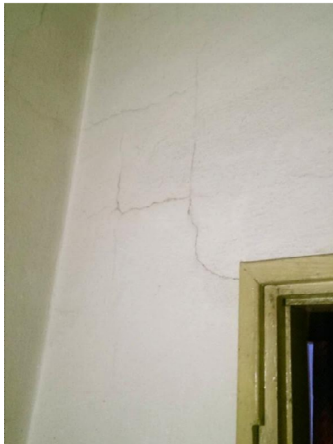
Fot. 69 Rysy na tynkach ścian parteru
