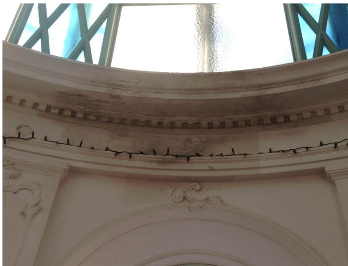
Fot. nr 42: Widok na zawilgocony gzyms po dniu intensywnych opadów, na zdjęciu powyżej widoczne jest samo miejsce od zewnątrz. Nieszczelność orynnowania, woda lejąca się poprzez pęknięte połączenia poszczególnych elementów rynny wnika w ścianę oraz spływa po murze zewnętrznym powodując zniszczenia zewnętrznego gzymsu i dalej półki i ściany podparapetowej.
