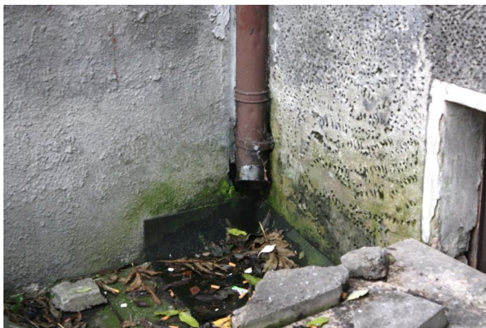
Fot. 9. Uszkodzony spust rynny za werandą - woda odprowadzana na ścianę budynku
