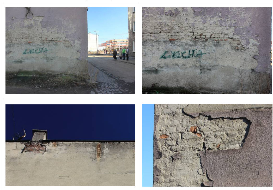
FOT. 13, 14, 15 i 16. Widoczne zniszczenia ścian będące wynikiem ich przemarzania oraz zawilgocenia.
