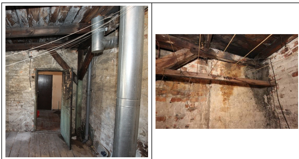
FOT. 45 i 46. Zniszczenia konstrukcji więźby dachowej i poszycia dachu spowodowane nieszczelnością pokrycia dachu.
