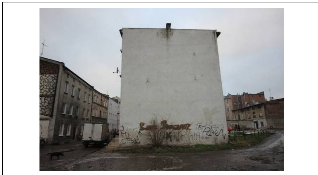
FOT. 17. Elewacja szczytowa od torów została naprawiona w roku 2010 – brak prawidłowej izolacji termicznej komina (odpadanie zawilgoconego), przemarzanie kotew.
