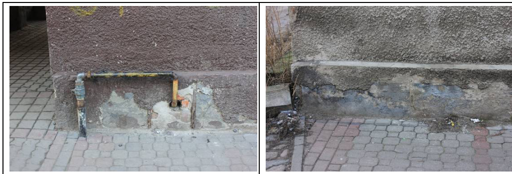
FOT. 6 i 7. Widoczne uszkodzenie tynku w okolicy cokołowej, co może świadczyć o zawilgoceniu ściany fundamentowej.
