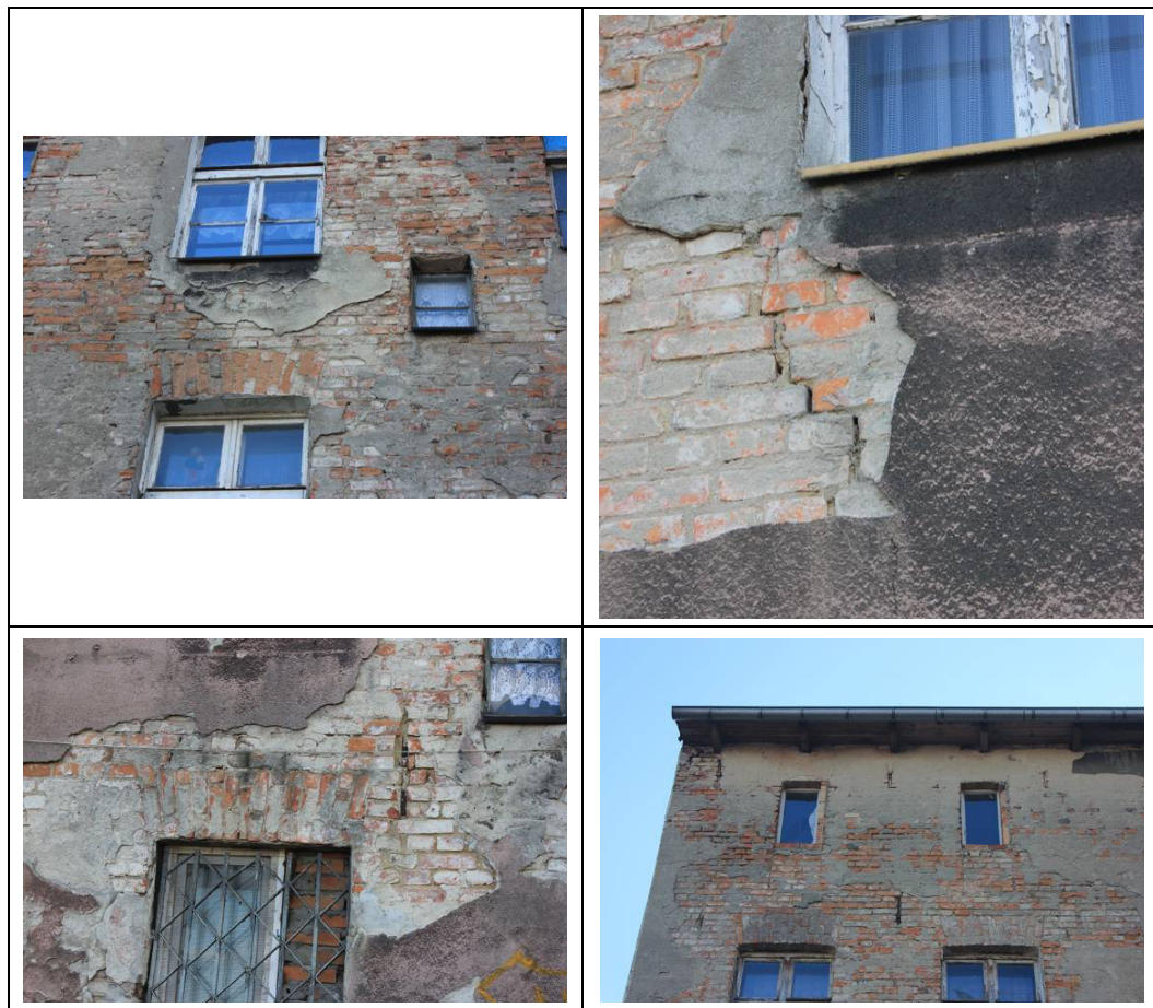
FOT. 24, 25, 26 i 27. Widoczne zniszczenia ściany, tynków, stolarki okiennej i muru pod okapem.
