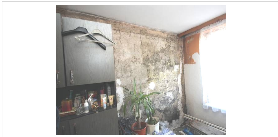
FOT. 39. Grzyb na ścianie zewnętrznej mieszkania na 02 piętrze spowodowany przemarzaniem ściany szczytowej.
