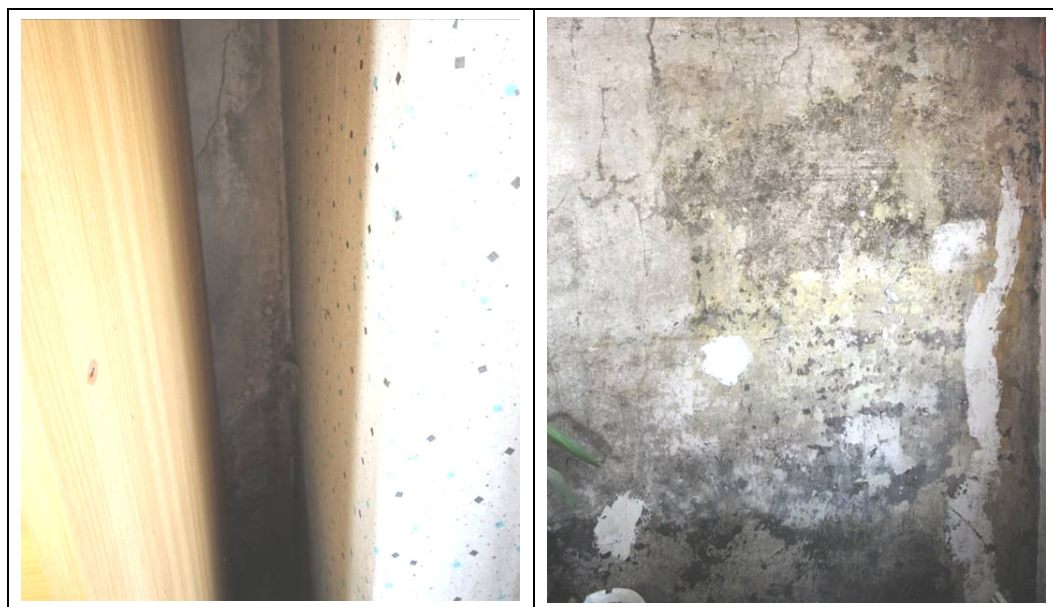
FOT. 40 i 41. Grzyb na ścianie zewnętrznej mieszkań na 01 i 02 piętrze spowodowany przemarzaniem ściany.
