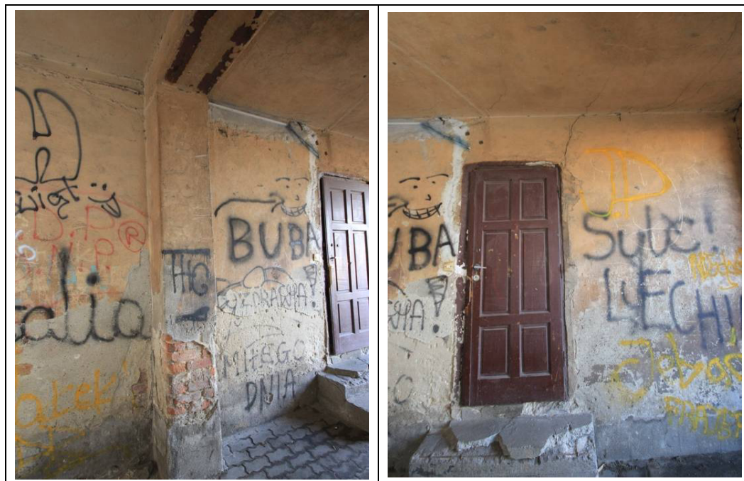
FOT. 30 i 31. Skorodowane stopki belki stropowej, spękanie murów, uszkodzenia stopni, zawilgocone ściany w dolnej partii spowodowane prawdopodobnie podsiąkaniem wody wpływającej do przejazdu.
