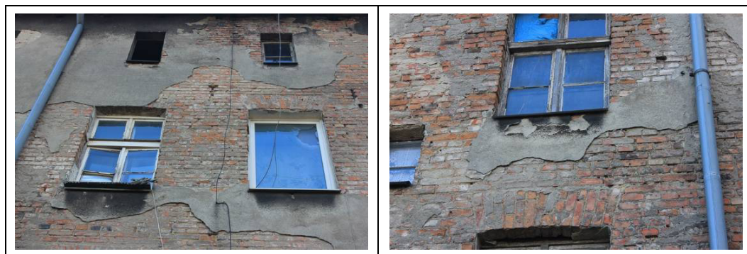
FOT. 22 i 23. Widoczne zniszczenia ściany, tynków, stolarki okiennej i muru pod okapem.
