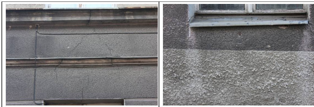
FOT. 8 i 9. Pęknięcia ściany i gzymsu w miejscu nadproża i pod oknem.
