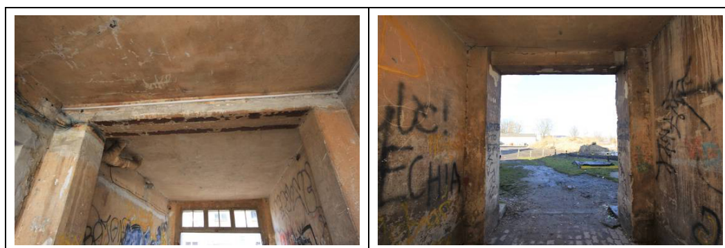
FOT. 32 i 33. Zniszczenia ścian i tynków, oraz stopek konstrukcji stalowej belek. Widoczny wyższy poziom gruntu w stosunku do posadzki przejazdu.
