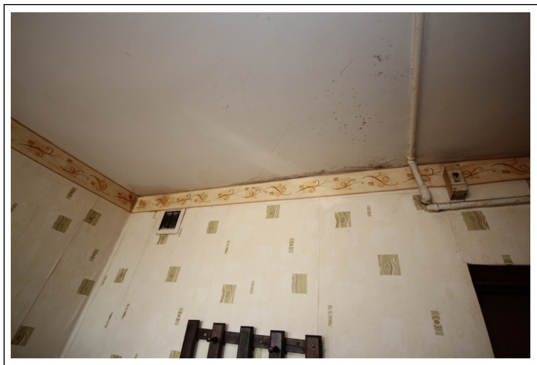
FOT. 48. Mieszkanie na poddaszu obok strychu - widoczne ślady zawilgocenia stropu spowodowane nieuszczelnością dachu.
