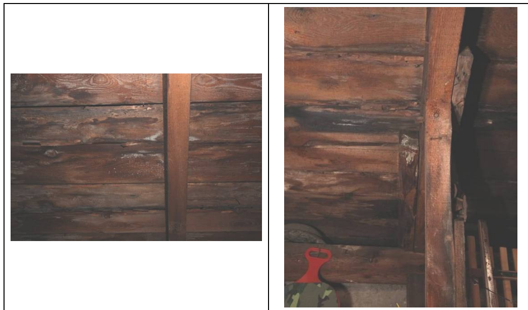
FOT. 46 i 47. Zniszczenia poszycia dachu spowodowane nieuszczelnością pokrycia dachu.
