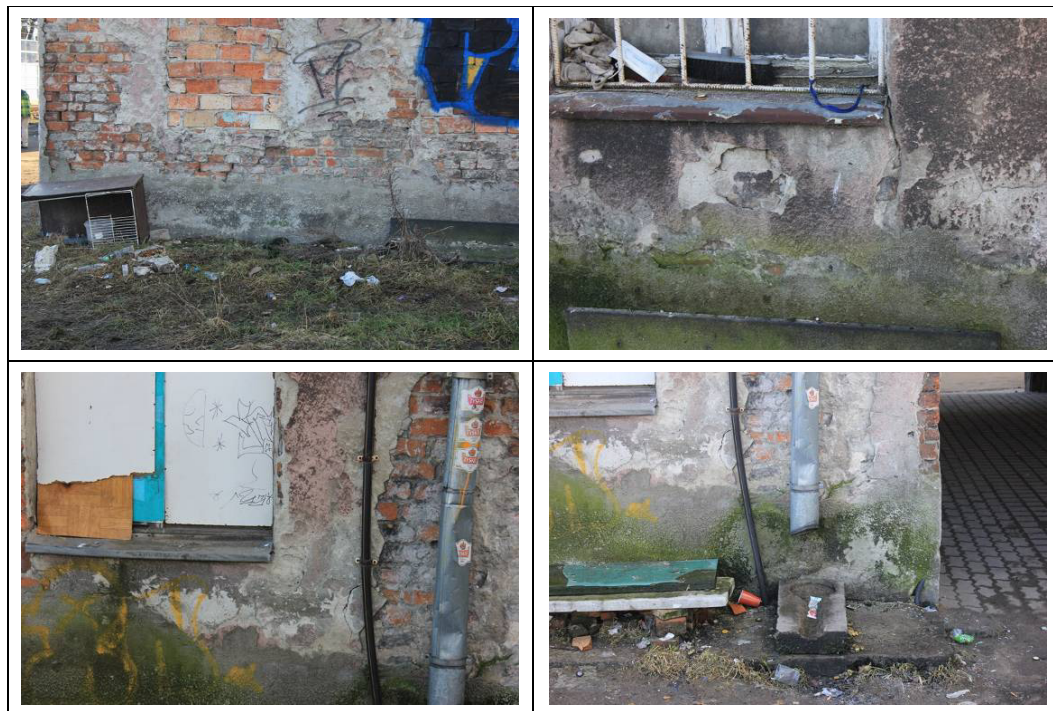
FOT. 18, 19, 20 i 21. Widoczne zniszczenia ścian będące wynikiem ich zawilgocenia spowodowanego nieprawidłowym odprowadzeniem wód opadowych, brakiem izolacji pionowej ścian oraz przemarzania ściany i jej licznych przebudów.
