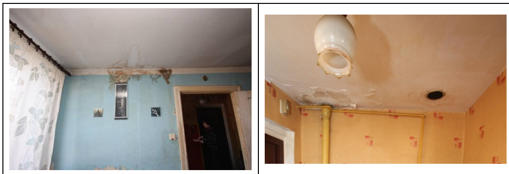
FOT. 42 i 43. Widoczne zawilgocenia stropu spowodowane nieszczelnością dachu i przesączaniem się wody opadowej przez podłogę poddasza.
