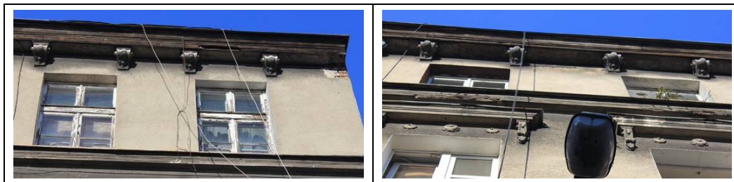
FOT. 11 i 12. Uszkodzenia gzymsu podokapowego.
