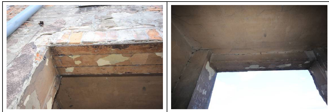
FOT. 28 i 29. Skorodowane stopki belek nadproży, spękane podniebienie stropu.
