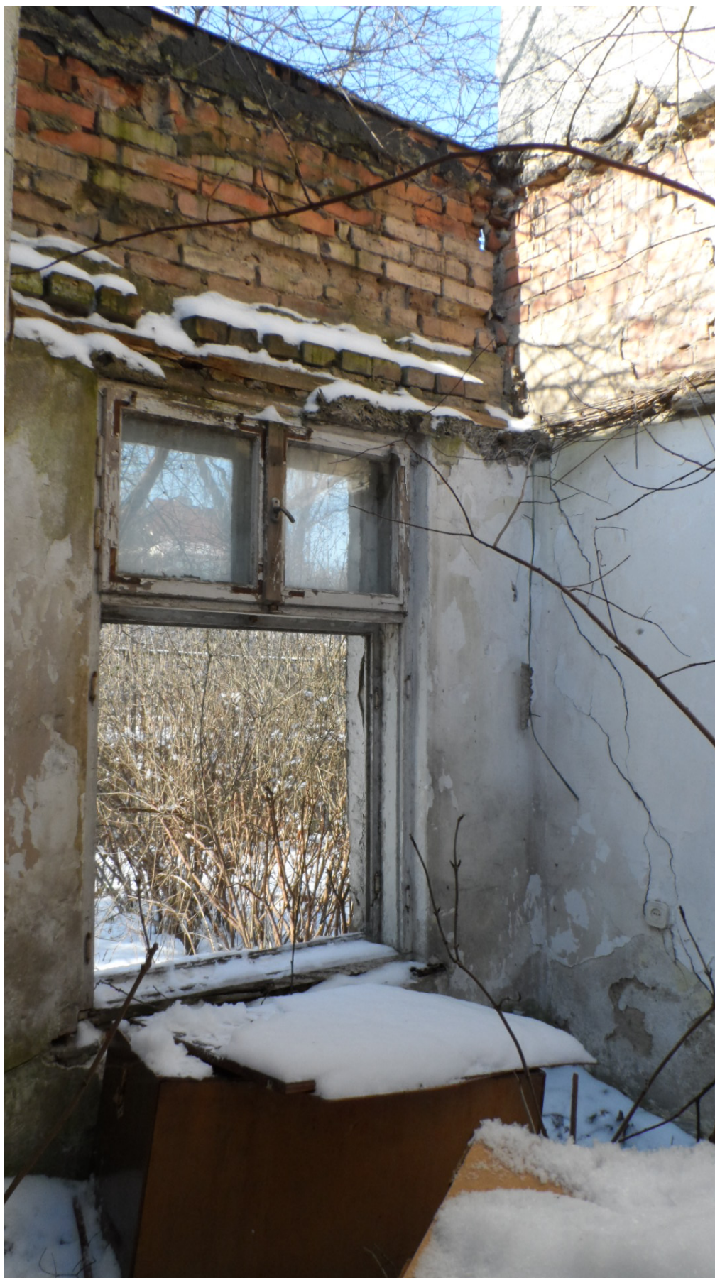
Wnętrze przybudówki (pom. 03)– widok na okno od strony zachodniej – widoczne ślady po nieistniejącym dachu i nieistniejącej podsufitce
