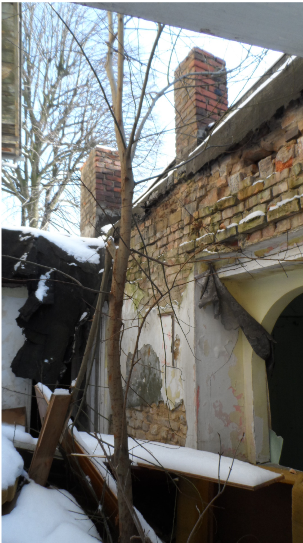
Widok wnętrza przybudówki (pom. 03, przez okno od strony zachodniej) – nie istniejący dach i nie istniejąca podsufitka)
