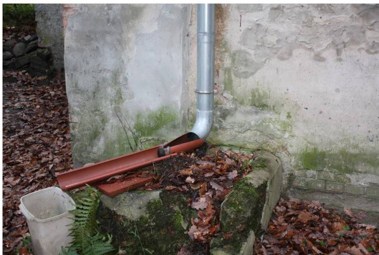
Fot. nr 5. Elewacja frontowa – północna – odprowadzenie wody z rynny
