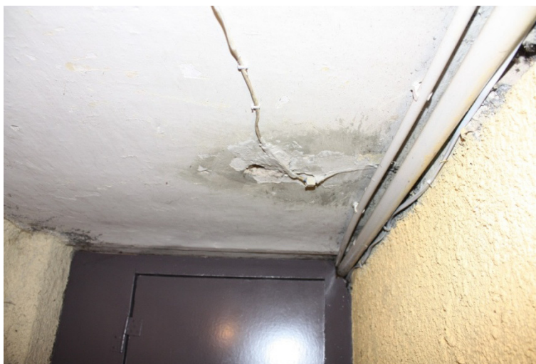
Fot. nr 61. Przykłady wadliwie wykonanych i użytkowanych instalacji elektrycznych
