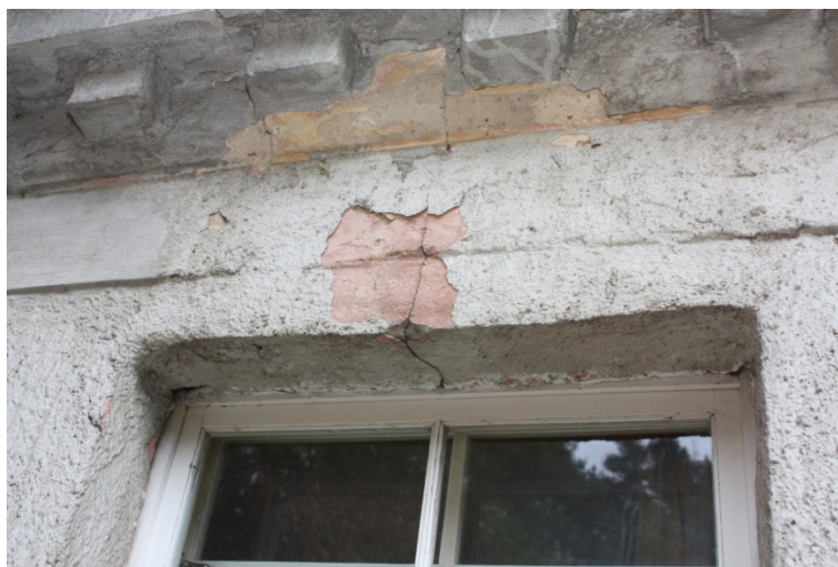
Fot. nr 52. Mieszkanie nr 2 – rysa na nadprożu okiennym
