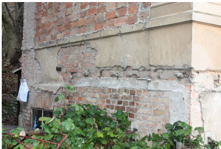
Fot. nr 7. Elewacja zachodnia – ubytki tynków
