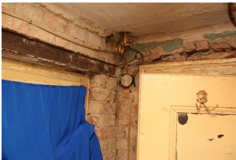
Fot. nr 62. Przykłady wadliwie wykonanych i użytkowanych instalacji elektrycznych
