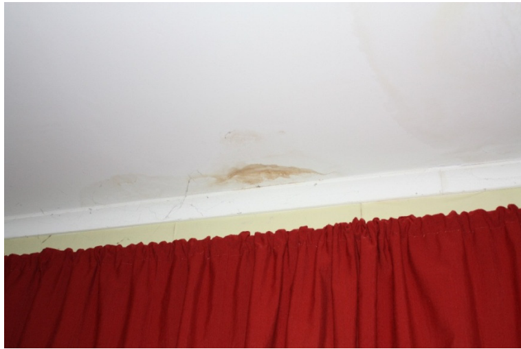
Fot. nr 53. Mieszkanie nr 3 – zaciek na suficie w pokoju
