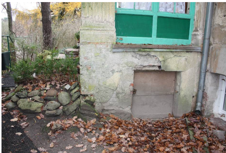
Fot. nr 13. Elewacja wschodnia – ubytki tynków na słupach ozdobnych, zarysowane nadproże wejścia do pomieszczenia pod gankiem
