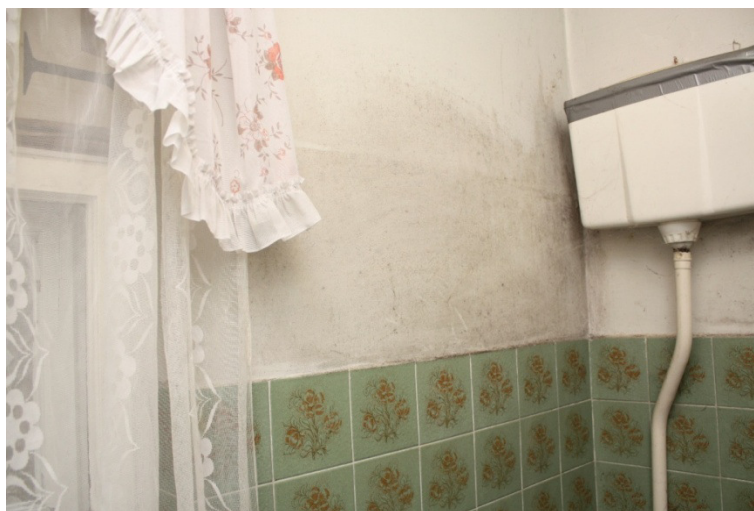
Fot. nr 55. Mieszkanie nr 3 – przemazanie ścian w toalecie
