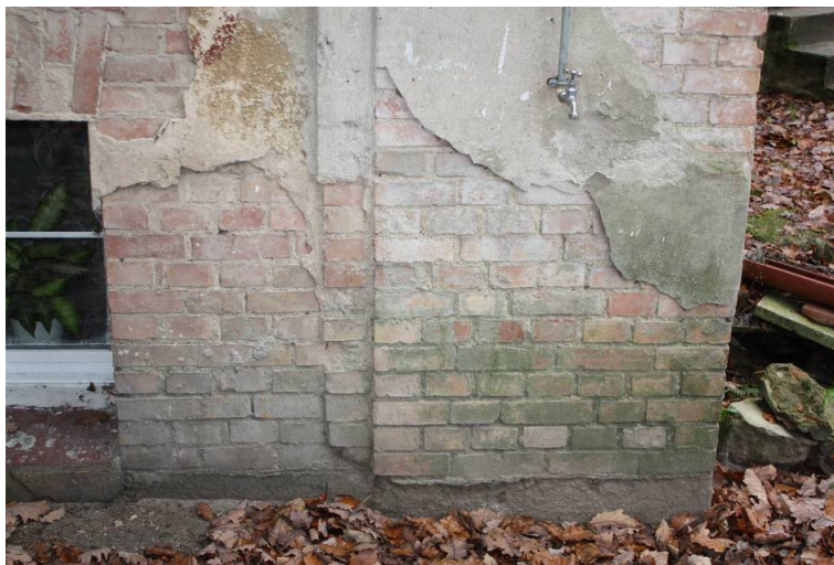
Fot. nr 12. Elewacja wschodnia – ubytki tynków
