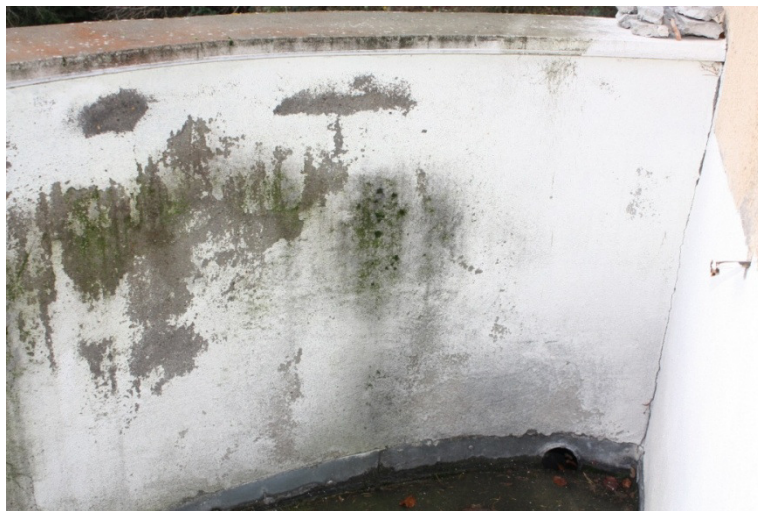
Fot. nr 54. Mieszkanie nr 3 – zawilgocone ściany tarasu
