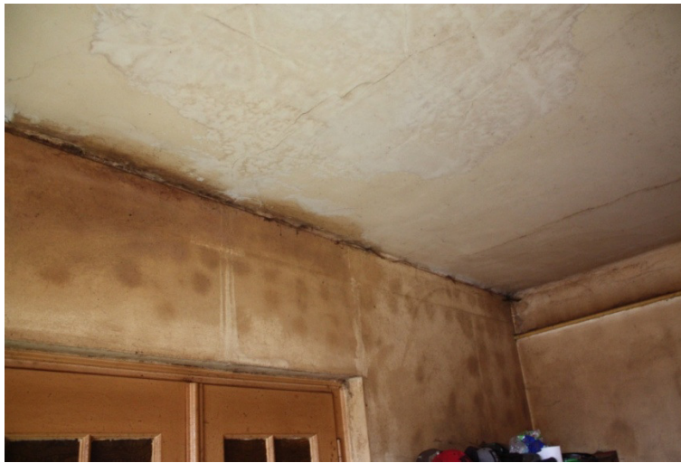
Fot. nr 45. Mieszkanie nr 1A – zacieki od tarasu powyżej
