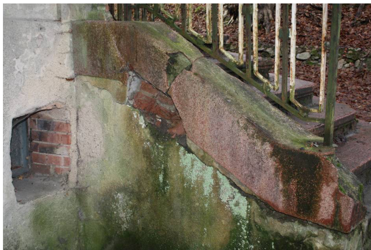
Fot. nr 21. Schody zewnętrzne frontowe od strony północnej – ubytki w okładzinach i zawilgocenie ścian
