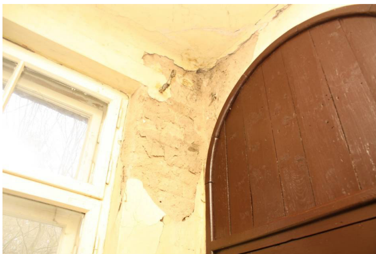
Fot. nr 29. Ubytki tynku na korytarzu
