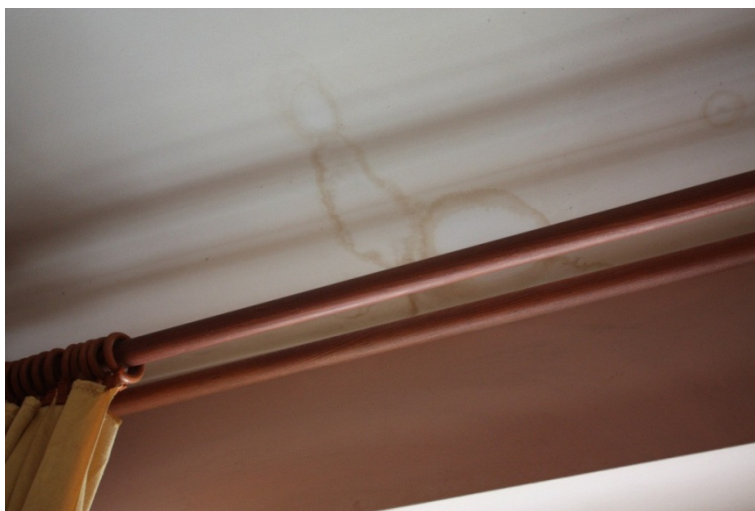
Fot. nr 50. Mieszkanie nr 2 – zaciek na suficie w małym pokoju
