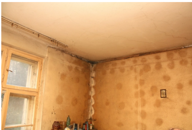
Fot. nr 43. Mieszkanie nr 1A – pokój - skrajne zaniedbania w użytkowaniu mieszkania. Widoczna ściana ocieplona od wewnątrz płytą g-k, przemarzanie w miejscu kładzenia kleju
