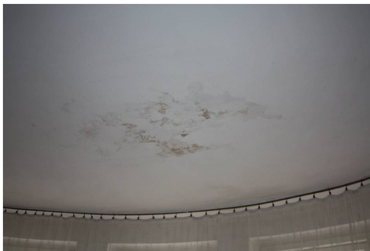
Fot. nr 38. Mieszkanie nr 1 – duży pokój– zacieki na suficie
