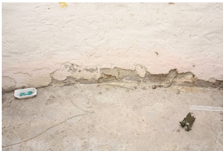
Fot. nr 28. Pomieszczenia piwniczne lokalne zawilgocenie ściany
