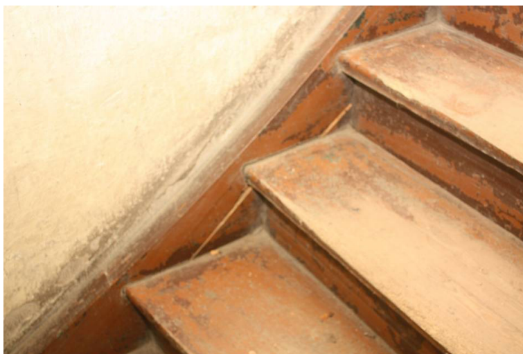
Fot. nr 23. Uszkodzenie policzka schodów wewnętrznych
