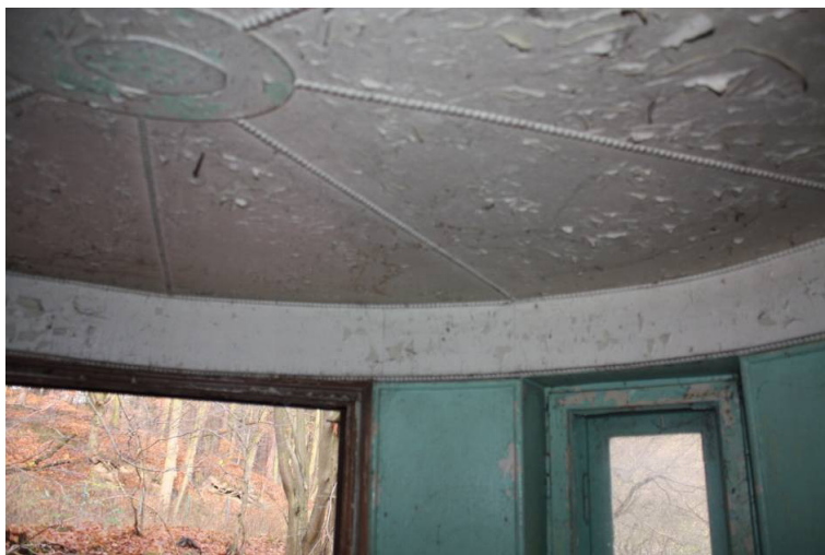
Fot. nr 30. Złuszczenie farby na ścianach i suficie sieni eliptycznej
