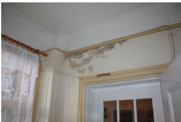
Fot. nr 41. Mieszkanie nr 1 – zalanie ściany na ganku
