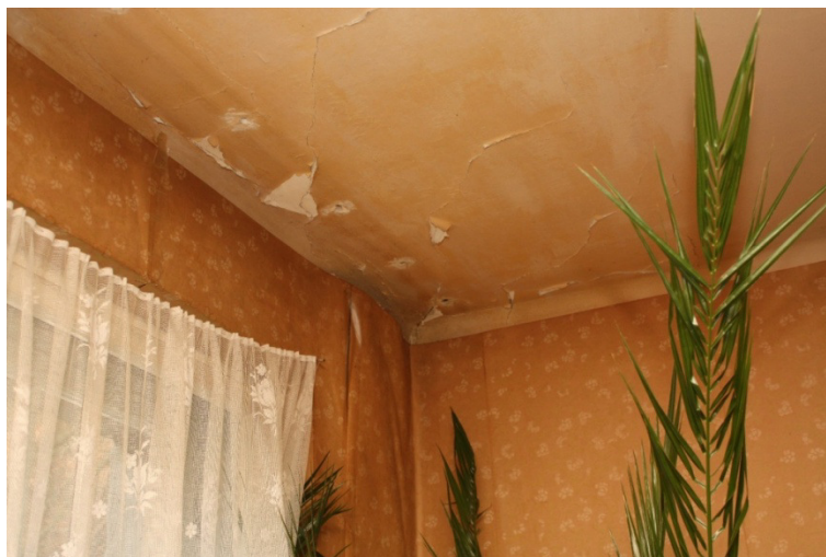
Fot. nr 48. Mieszkanie nr 2 – zacieki na suficie w dużym pokoju
