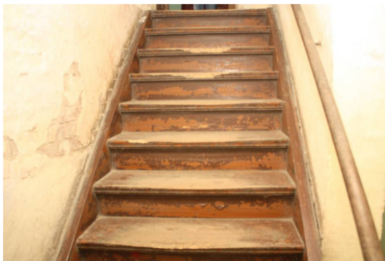
Fot. nr 24. Lokalne uszkodzenia stopni
