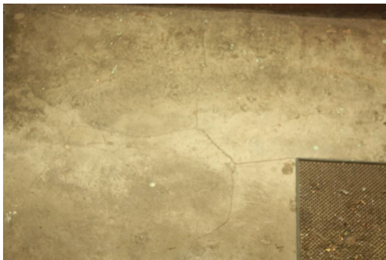
Fot. nr 32. Spękania posadzki na parterze – korytarz
