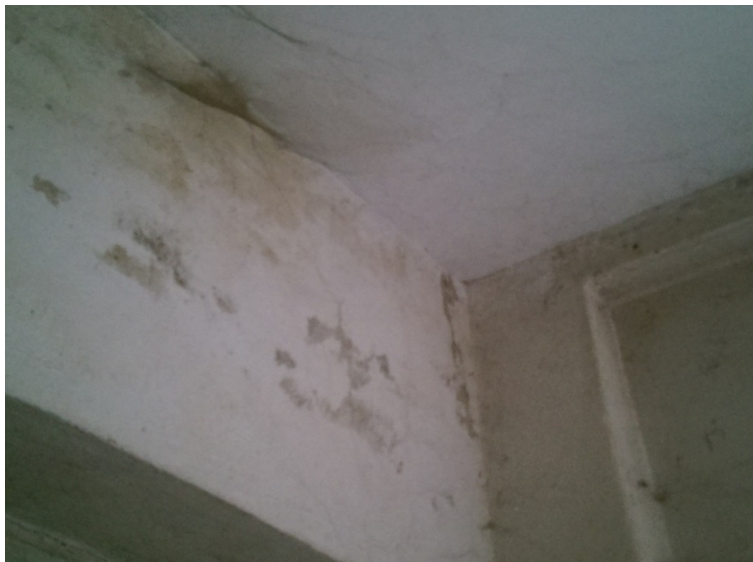
Fot. nr 46. Mieszkanie nr 1A – zacieki od tarasu powyżej – widok od strony werandy
