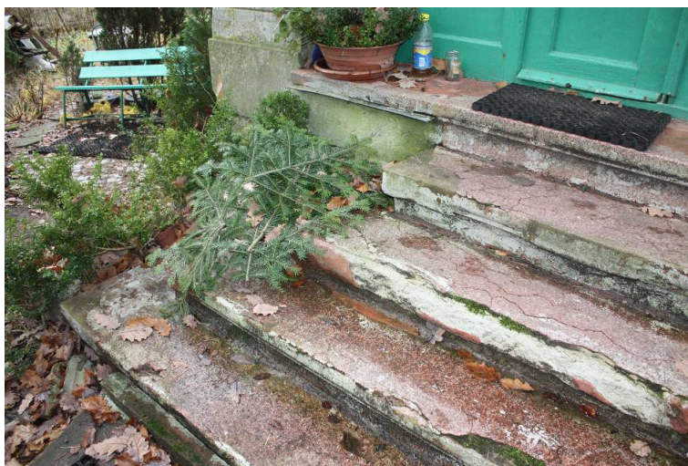
Fot. nr 22. Schody zewnętrzne od strony wschodniej – ubytki w okładzinach
