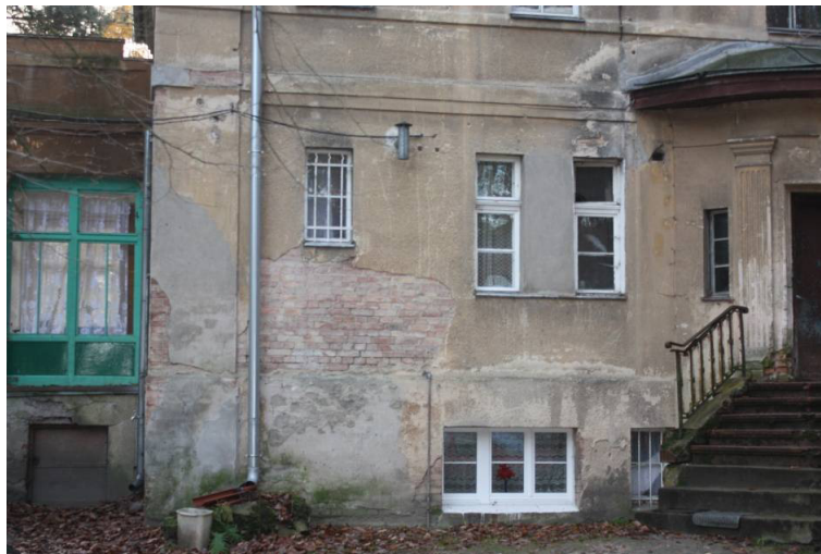
Fot. nr 3. Elewacja frontowa – północna – ubytki w tynkach
