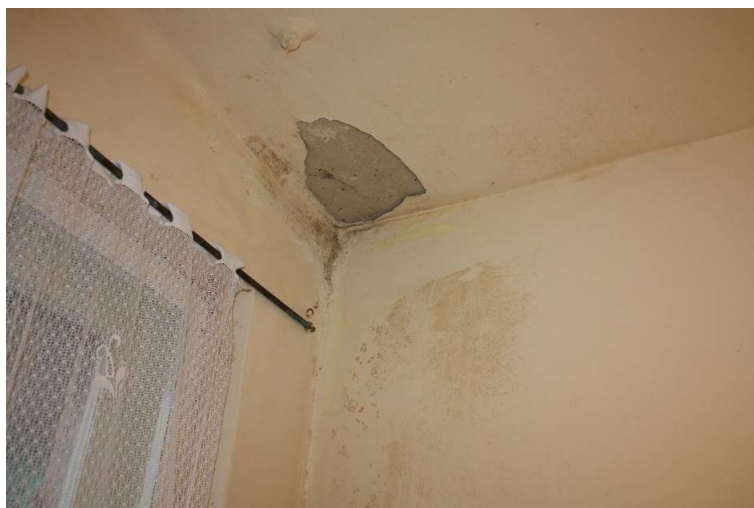
Fot. nr 39. Mieszkanie nr 1 – łazienka– ubytki tynku na suficie; przemarzanie ściany
