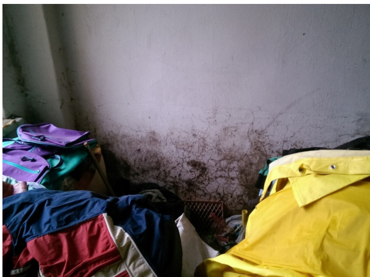
Fot. nr 44. Mieszkanie nr 1A – weranda - skrajne zaniedbania w użytkowaniu mieszkania, widoczne zagrzybenie ściany
