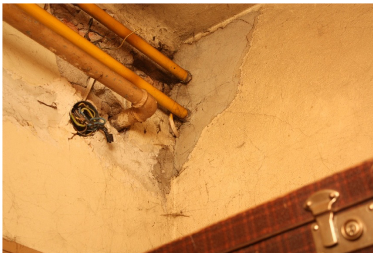
Fot. nr 60. Przykłady wadliwie wykonanych i użytkowanych instalacji elektrycznych
