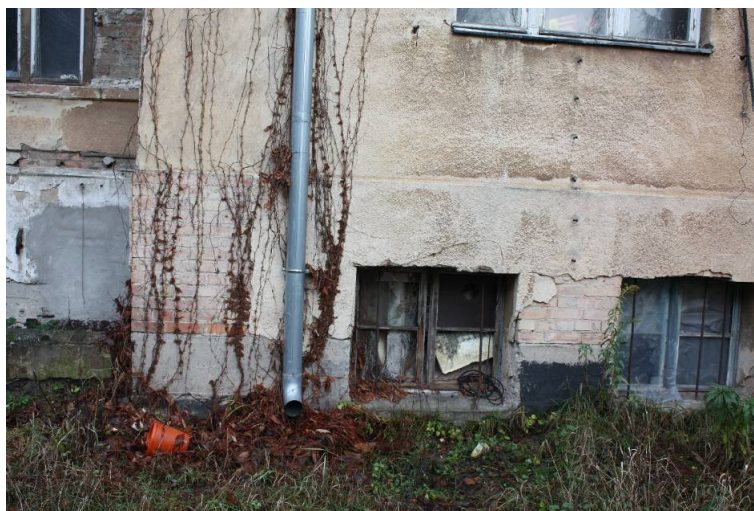
Fot. nr 10. Elewacja południowa – ubytki tynku
