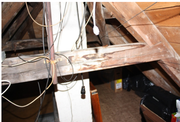
Fot. nr 17. Nieszczelność w miejscu masztu antenowego – zawilgocona jętką
