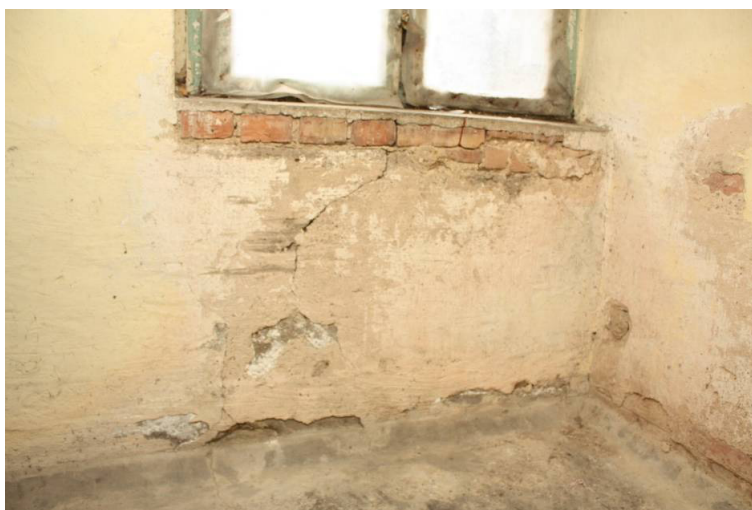
Fot. nr 27. Pomieszczenia piwniczne - zarysowanie ściany pod oknem
