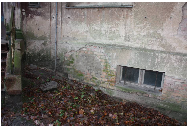
Fot. nr 4. Elewacja frontowa – północna – zawilgocenie ściany
