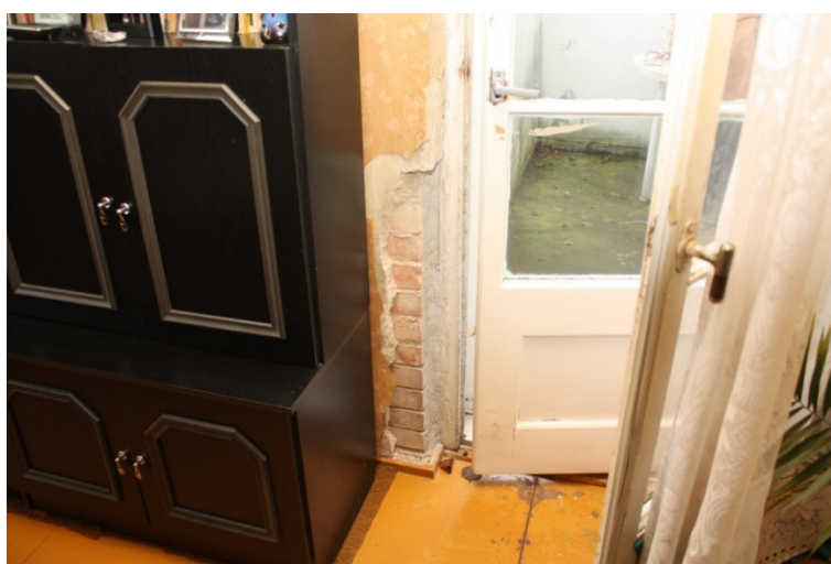
Fot. nr 49. Mieszkanie nr 2 – ubytki tynku przy wejściu na taras w dużym pokoju
