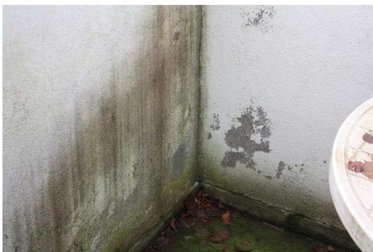
Fot. nr 51. Mieszkanie nr 2 – zawilgocone ściany tarasu
