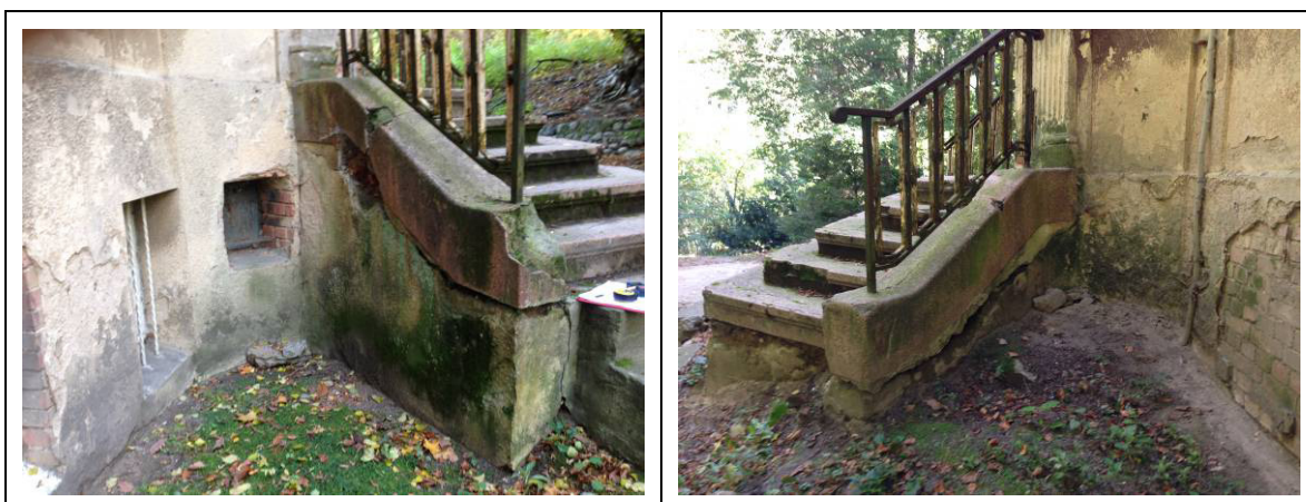
Widoczne zawilgocenie murów budynku i konstrukcji schodów.
