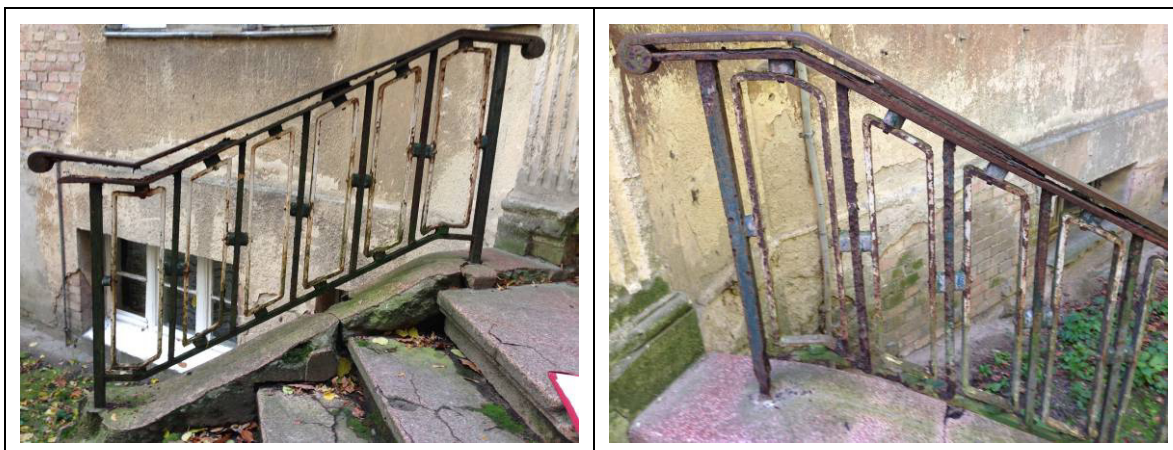
Zniszczona niekonserwowana oryginalna balustrada.
