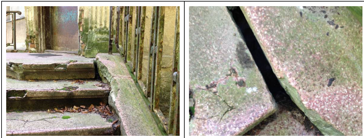
Widoczne odspojenia i szczeliny konstrukcji i warstw wykończeniowych z lastrika.
