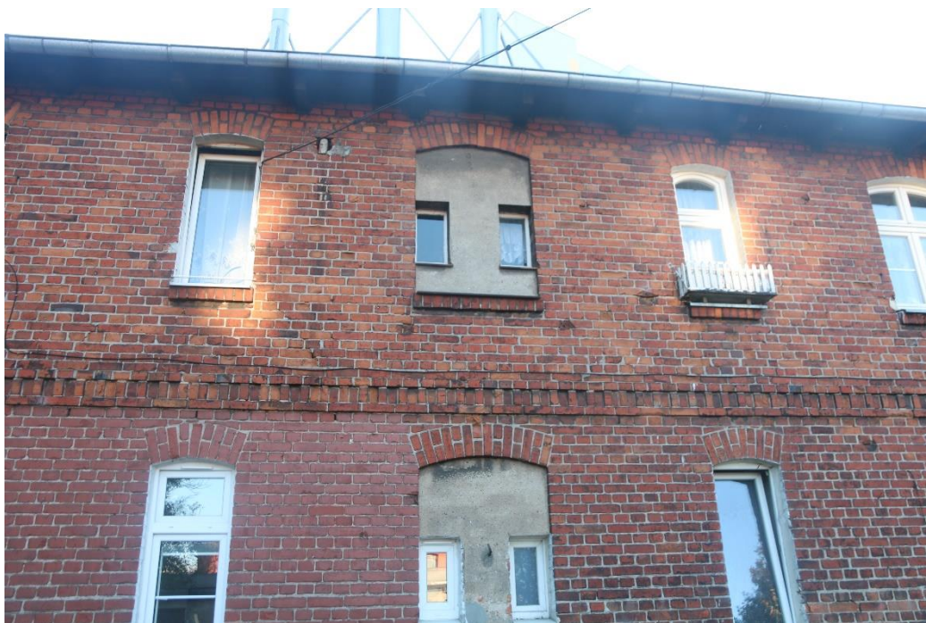
27. Gdańsk, ul. Karola Dickensa 2. Elewacja północno – wschodnia. Widok od podwórza. Widoczne w partii parteru wtórnie pomalowane lico muru, otynkowane otwory okienne.
