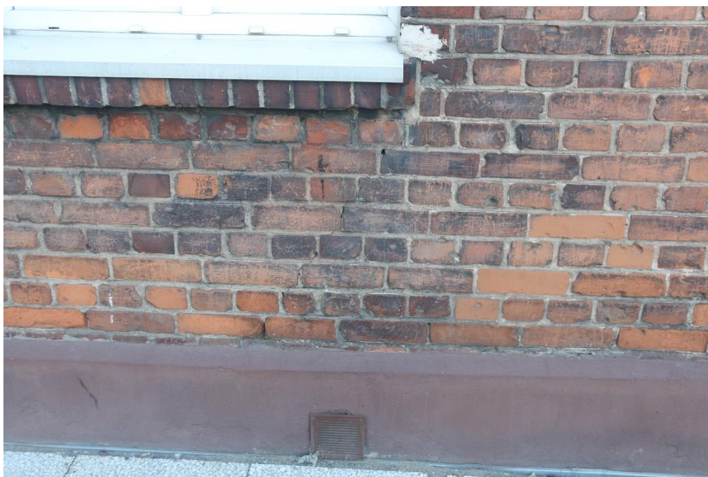
11. Gdańsk, ul. Dickensa 2. Elewacja południowo – zachodnia. Widoczne spękania struktury muru, przebiegające od parapetu do cokotu, czarne nawarstwienia na cegłach.
