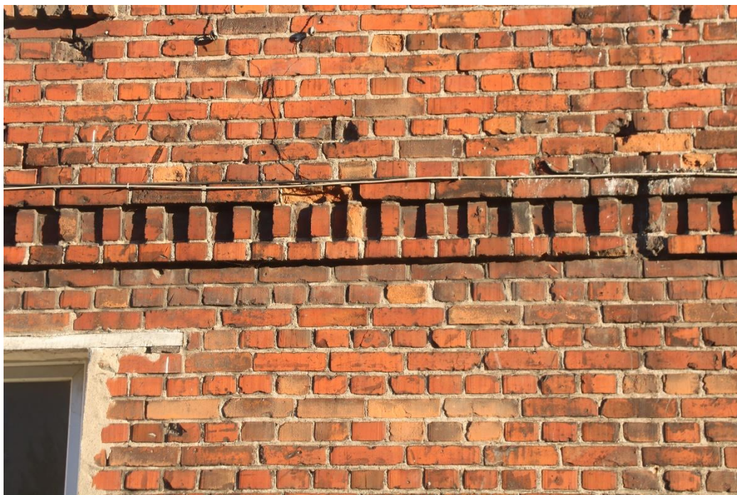
20. Gdańsk, ul. Karola Dickensa 2. Elewacja północno – zachodnia. Widoczne zniszczenia cegieł fryzu: głębokie ubytki cegieł.
