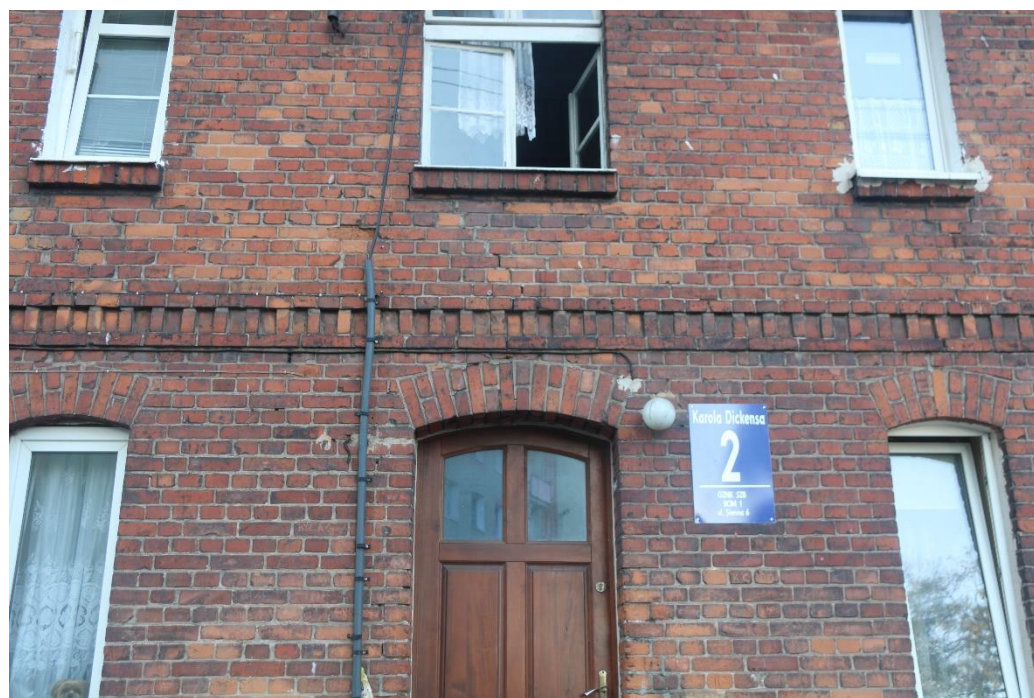
2. Gdańsk, ul. Karola Dickensa 2. Elewacja południowo – zachodnia. Widoczne zniszczenia elewacji: pionowo przebiegające nad otworem wejściowym spękanie, czarne nawarstwienia na powierzchni cegieł.
