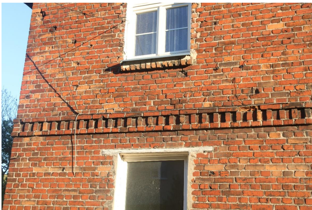
19. Gdańsk, ul. Karola Dickensa 2. Elewacja północno – zachodnia. Widoczne spękania konstrukcji muru przebiegające od parapetu okna, naprawa nadproża.
