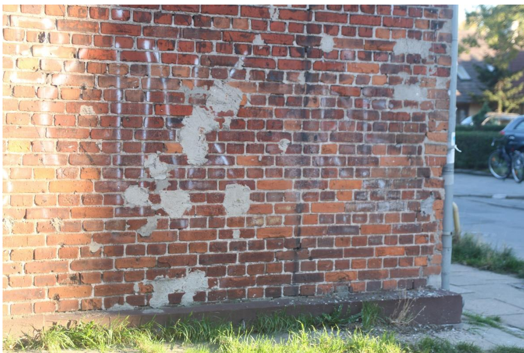
21. Gdańsk, ul. Karola Dickensa 2. Elewacja północno – zachodnia. Widoczne zniszczenia muru: nieestetycznie wykonane naprawy w szarej zaprawie.
