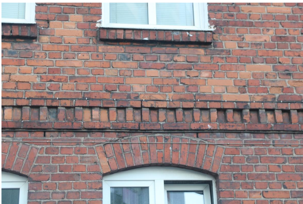
7. Gdańsk, ul. Karola Dickensa 2. Elewacja południowo – zachodnia. Widoczne spękania strukturalne nadproża okiennego.
