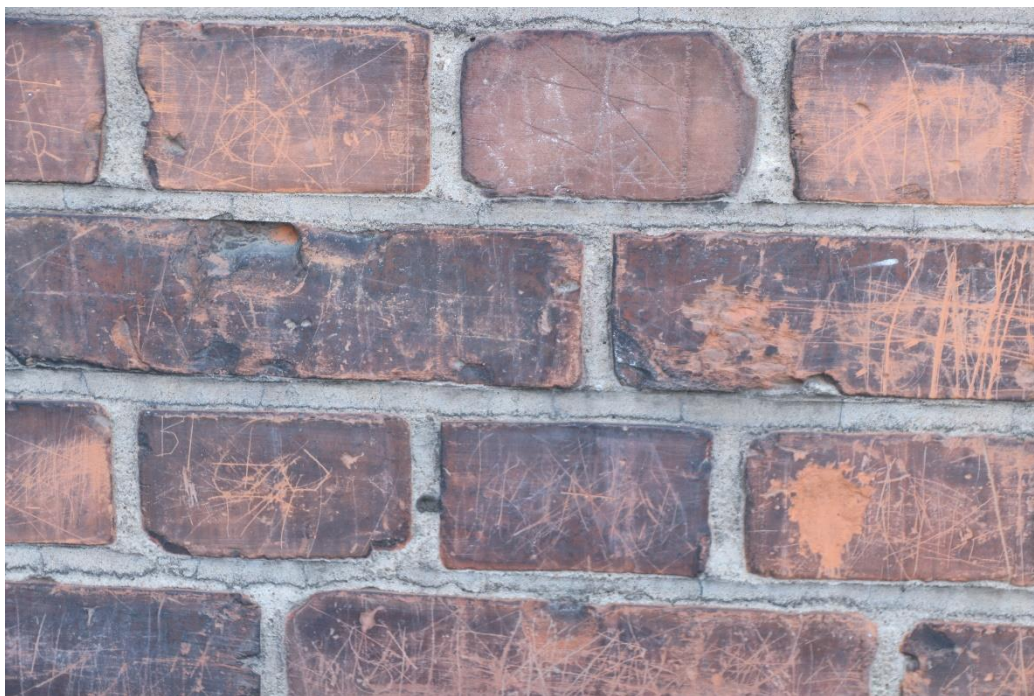
12. Gdańsk, ul. Dickensa 2. Elewacja południowo – zachodnia. Czarne nawarstwienia na powierzchni cegieł, powierzchniowe ubytki, szczelna spoina.
