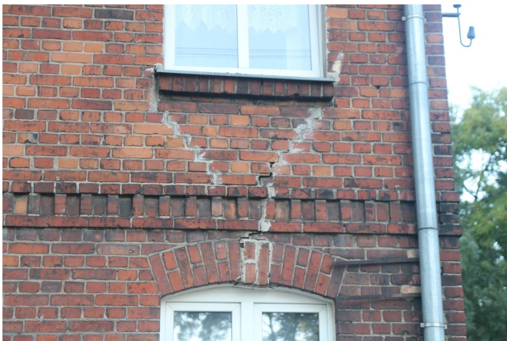
8. Gdańsk, ul. Karola Dickensa 2. Elewacja południowo – zachodnia. Widoczne zniszczenia struktury muru oraz nadproża okiennego.
