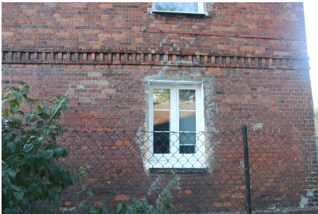
16. Gdańsk, ul. Karola Dickensa 2. Elewacja południowo – wschodnia. Widoczne nieestetycznie wykonane naprawy muru otworu okiennego.
