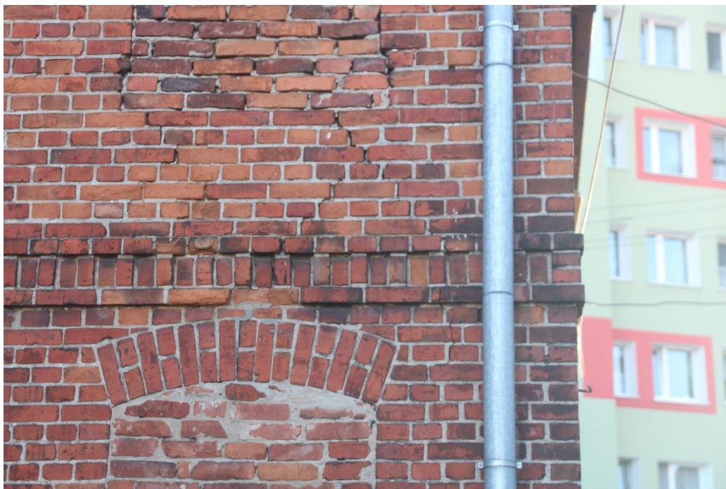
29. Gdańsk, ul. Karola Dickensa 2. Elewacja północno – wschodnia. Fragment elewacji z zamurowanymi otworami okiennymi. Widoczne przebiegające pionowo spękania struktury muru, ubytki cegieł fryzu, czarne nawarstwienia na powierzchni cegieł.
