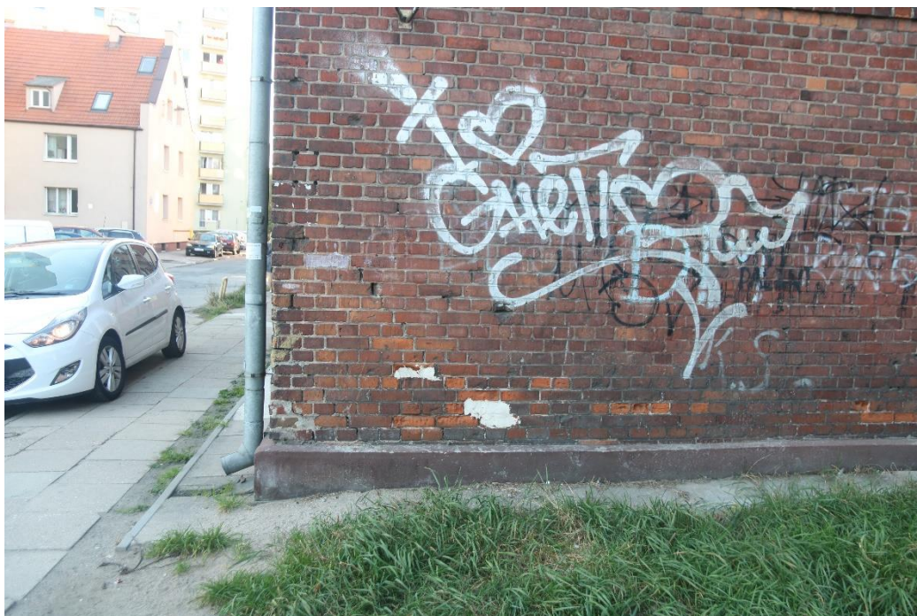
14. Gdańsk, ul. Karola Dickensa 2. Elewacja południowo – wschodnia. Widoczne spękanie konstrukcji muru, ubytki cegieł, czarne nawarstwienia na ceglach, napisy graffiti.
