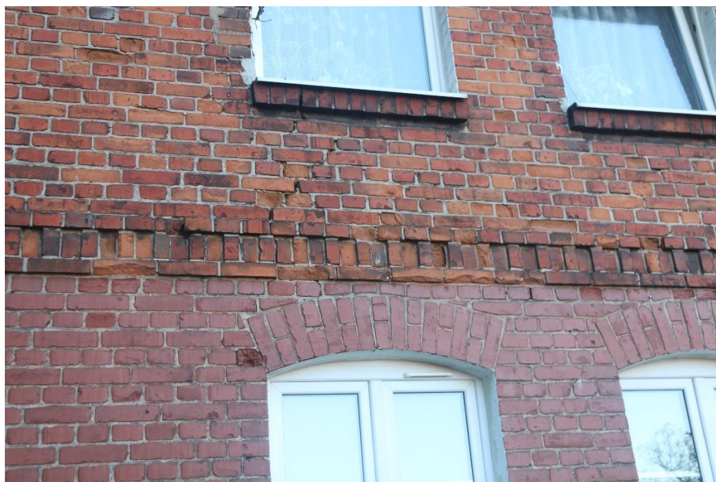
26. Gdańsk, ul. Karola Dickensa 2. Elewacja północno – wschodnia. Widoczne zniszczenia elewacji: pionowe spękania konstrukcji muru, głębokie ubytki cegieł fryzu, wtórnie pomalowane na ciemno-czerwony kolor lico, czarne nawarstwienia na powierzchni cegieł.
