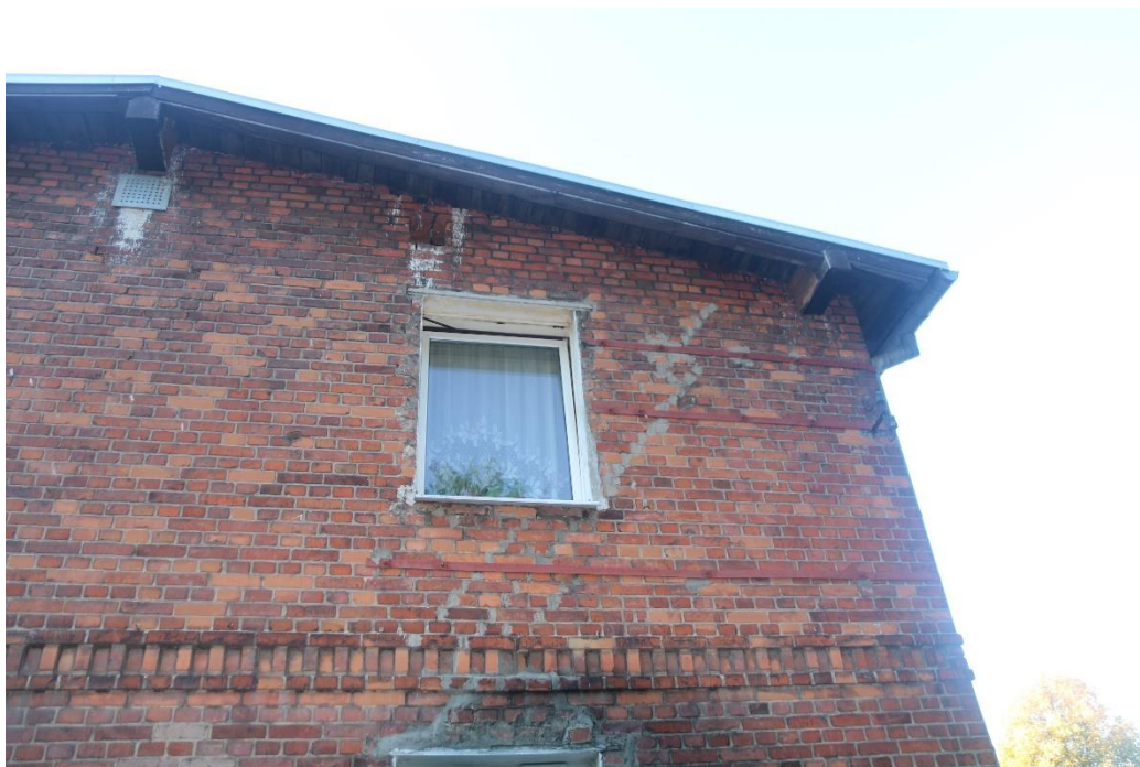
15. Gdańsk, ul. Karola Dickensa 2. Widoczne klamry spinające narożnik budynku na wysokości pierwszego piętra.
