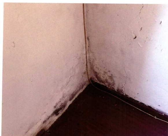
Fot.15 Zawilgocenie ściany w pomieszczeniu 3-4 na parterze
