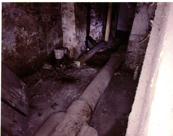
Fot.19 Widok na pozbawione tynku i zawilgocone mury fundamentowe w podpiwniczeniu
