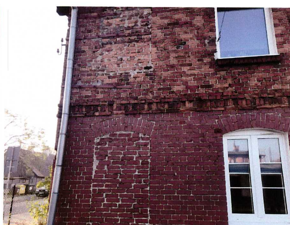
Fot.12 Zamurowania otworów dawnych okien i wzmocnienia kątownikami stalowymi muru elewacji tylnej północno-wschodniej Zarysowanie muru międzyokiennego
