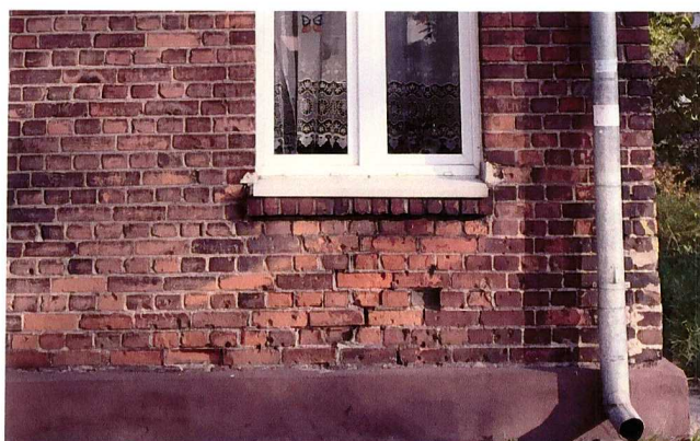
Fot.9 Zarysowanie i uszkodzenia cegieł muru podokiennego w narożniku południowym elewacji frontowej
