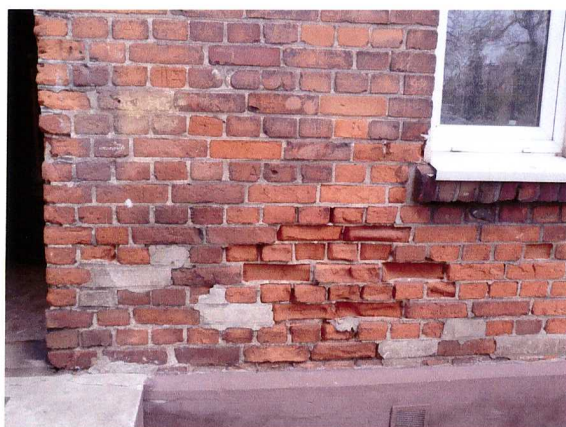
Fot.7 Korozja cegieł elewacji przy drzwiach wejściowych do budynku
