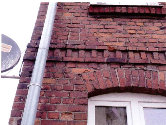
Fot.5 Zarysowanie muru międzyokiennego w narożniku zachodnim elewacji frontowej
