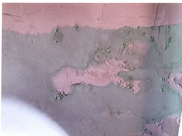
Fot.21 Złuszczenia tynku i powłoki z farby olejnej z wykwitami solnymi w korytarzu wejściowym
