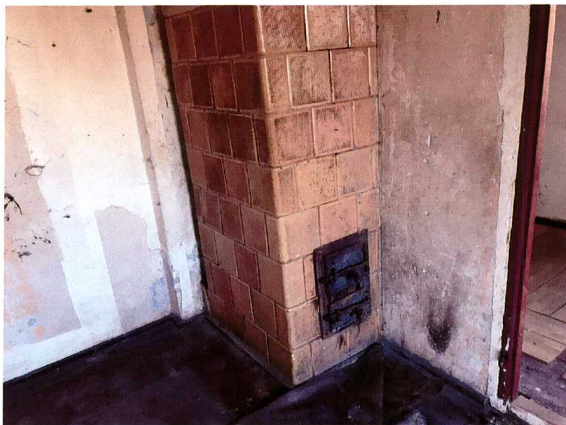
Fot.17 Piec grzewczy w pomieszczeniu 3 - 3
