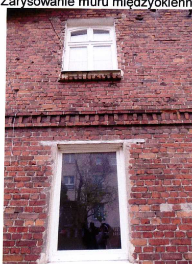
Fot.14 Zarysowania muru i nadproża drewniane w wykutych w okresie późniejszym okien w ścianie szczytowej północno-zachodniej.
