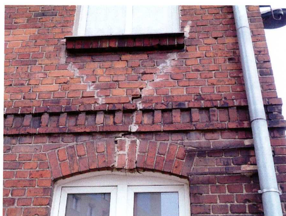
Fot.8 Zarysowanie muru międzyokiennego w narożniku południowym elewacji frontowej
