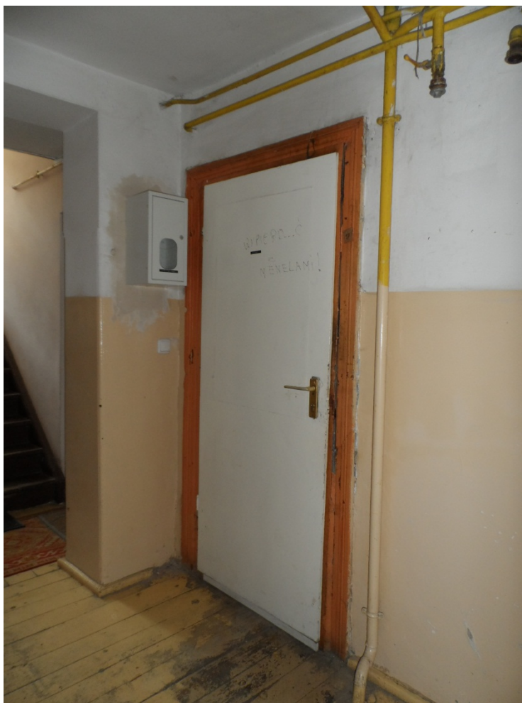
Fot. nr 1 -Drzwi wejściowe z klatki schodowej do mieszkania nr 17
