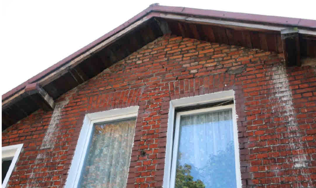
19. Gdańsk, ul. Wilków Morskich 5, elewacja północna. Widoczne zniszczenia partii szczytu: współcześnie pomalowane obramienia otworów okiennych, białe zacieki, spękania konstrukcji muru, przemurzenie z szarą spoiną.
