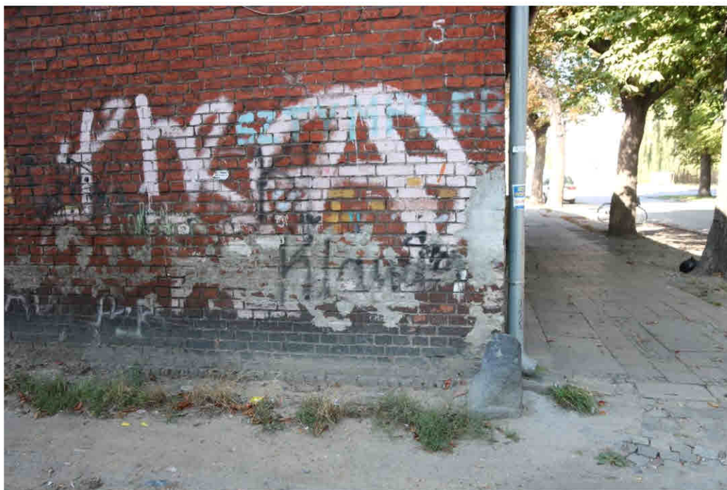
12. Gdańsk, ul. Wilków Morskich 5. Elewacja południowa. Widoczne zniszczenia elewacji południowej: naprawy wykonane w szarej zaprawie cementowej, napisy graffiti, cokół pokryty warstwą izolacyjną.
