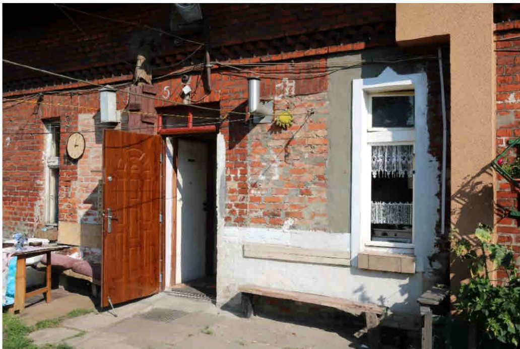
15. Gdańsk, ul. Wilków Morskich 5. Elewacja zachodnia. Widoczne zniszczenia elewacji: zamurowane otwory okienne, przewody i instalacje, współcześnie otynkowane lub pomalowane fragmenty muru, współcześnie wykonana opaska wokół okna, współcześnie wstawione drzwi.
