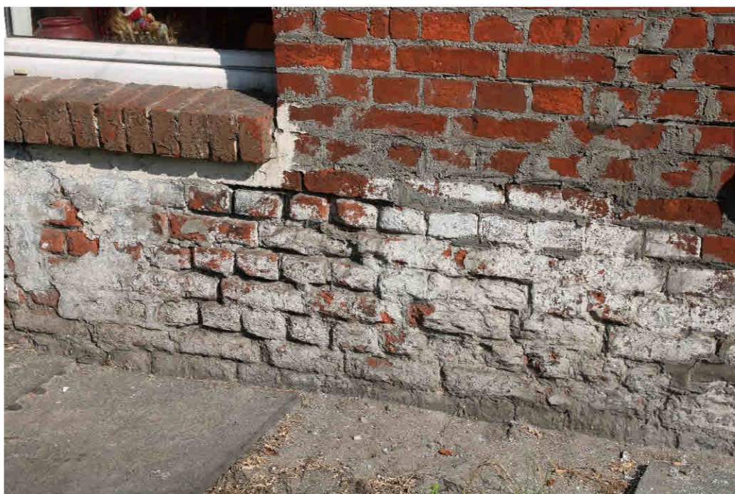
16. Gdańsk, ul. Wilków Morskich 5. Elewacja zachodnia. Widoczne zniszczenia partii przyziemia: ubytki spoin, ubytki cegieł, nieestetycznie wykonane spoinowanie w szarej, szczelnej zaprawie cementowej, osady na ceglach parapetu.
