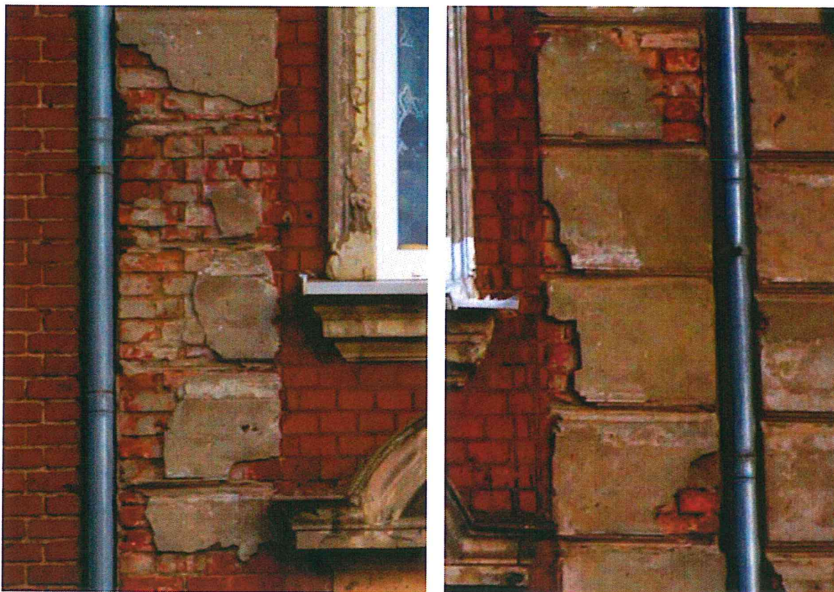
13, 14. Zniszczenia fragmentów dekoracyjnego tynkowania w formie boni
