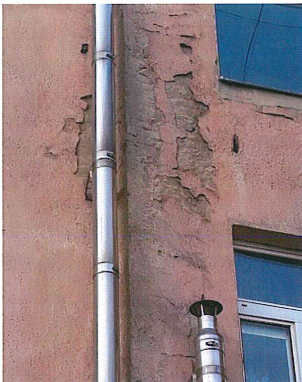
17. Odspojenia tynków w strefie przebiegu rury spustowej
