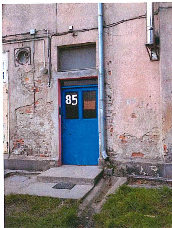
28. Wtórne, niestylowe drzwi prowadzące do klatki schodowej części mieszkalnej
