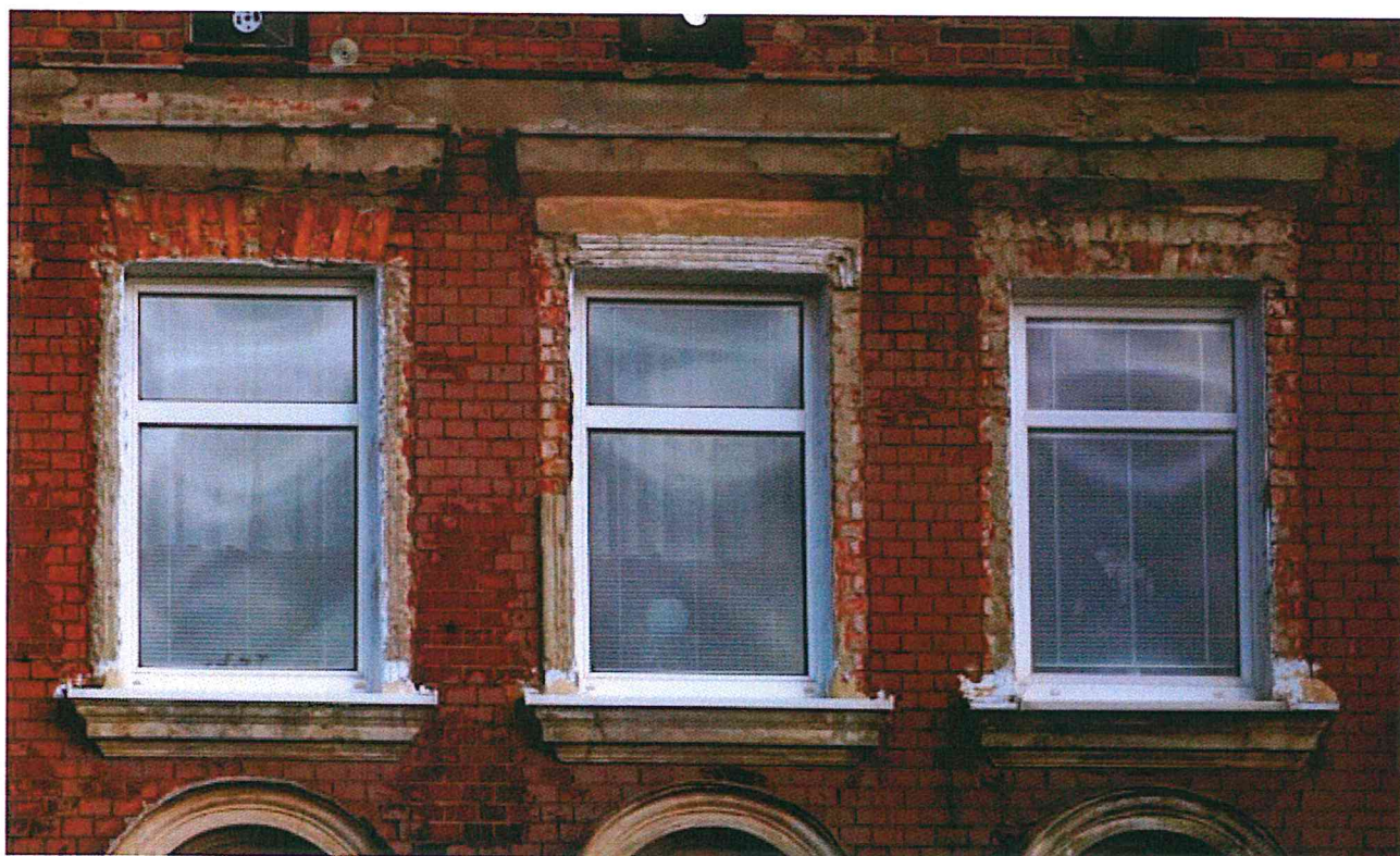
12. Zdegradowane opaski okienne kondygnacji trzeciego piętra
