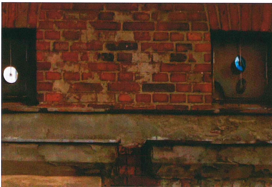
8. Elewacja ceglana poziomu poddasza w wątku krzyżykowym; widoczne ubytki lica i zdecydowanie mniej reprezentacyjny charakter
