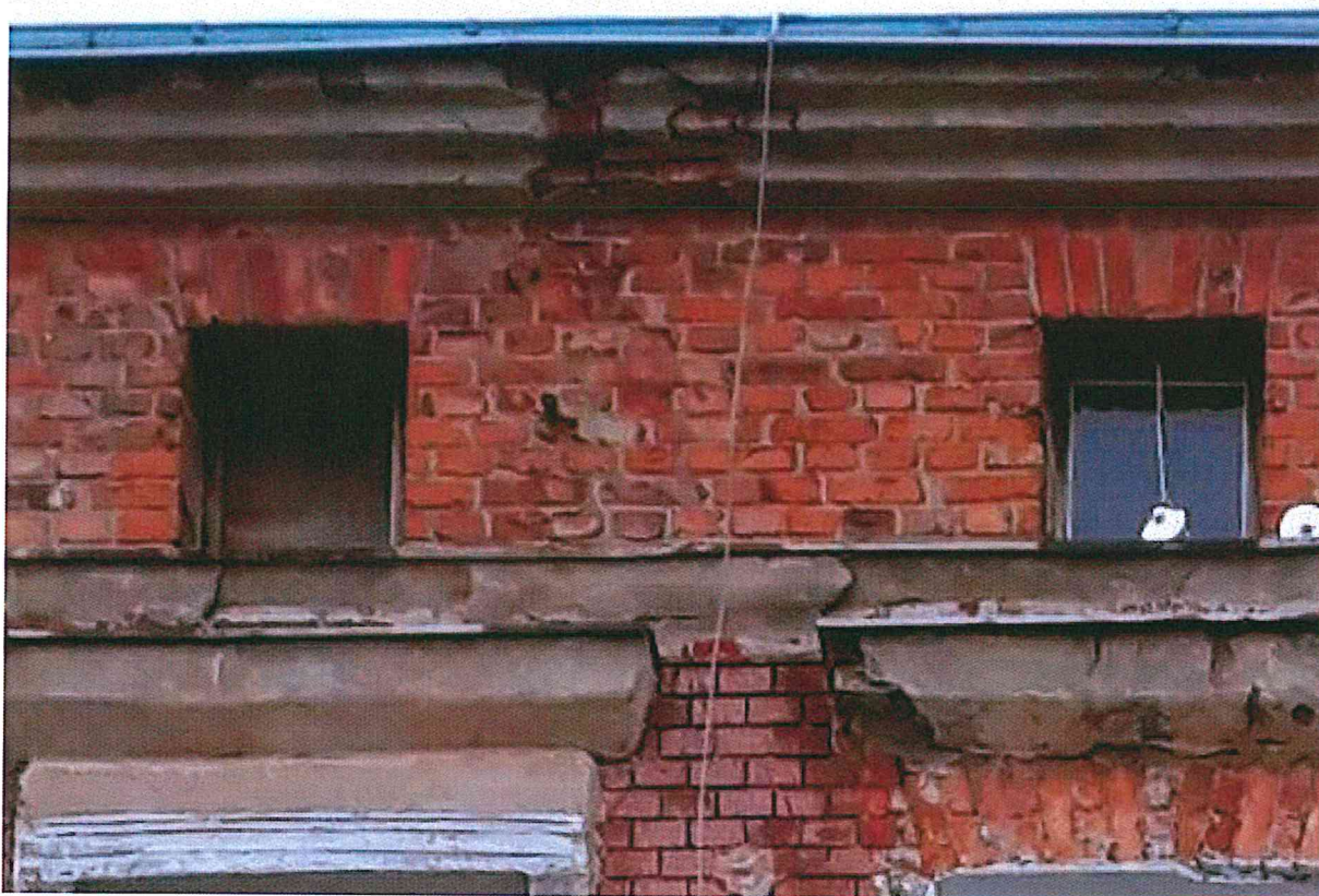
11. Ubytki występujące w gzymsie wieńczącym oraz płycinie i gzymsie nadokiennym kondygnacji trzeciego piętra
