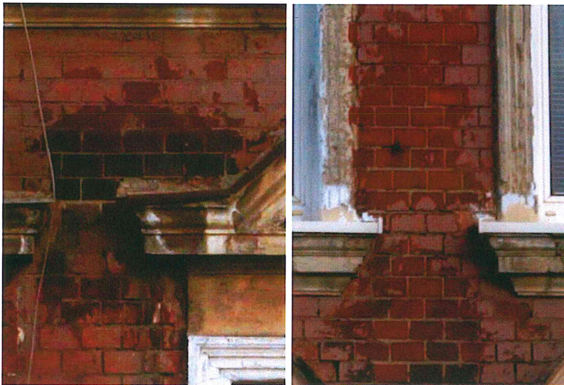
6,7. Elewacja frontowa wykończona cegłą licówką z widocznymi zabrudzeniami, odbarwieniami i sztuczną patyną; pierwotnie pokryta półprzezroczystym preparatem scalającym barwnie
