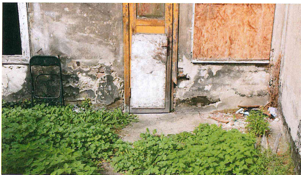
14. Gdańsk, Plac Wałowy 9, elewacja południowo-wschodnia. Widoczne zniszczenia partii przyziemia: zawilgocenie, czarne nawarstwienia.
