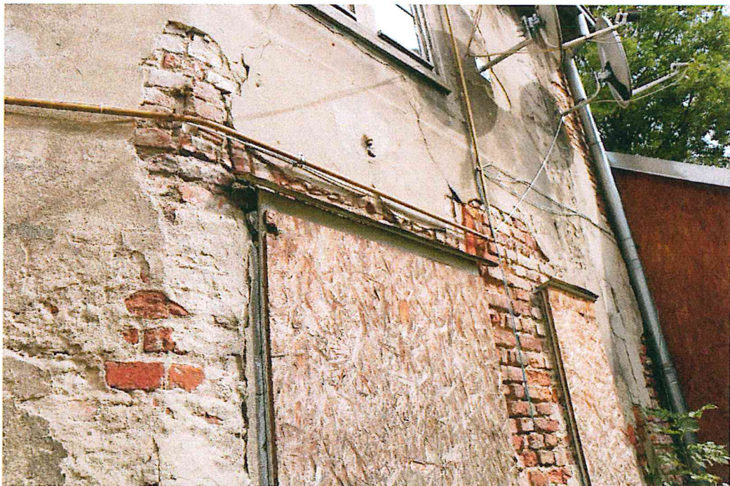
16. Gdańsk, Plac Wałowy 9, oficyna przylegająca do elewacji od podwórza. Zniszczenia zapraw tynku i zapraw spoinujących.
