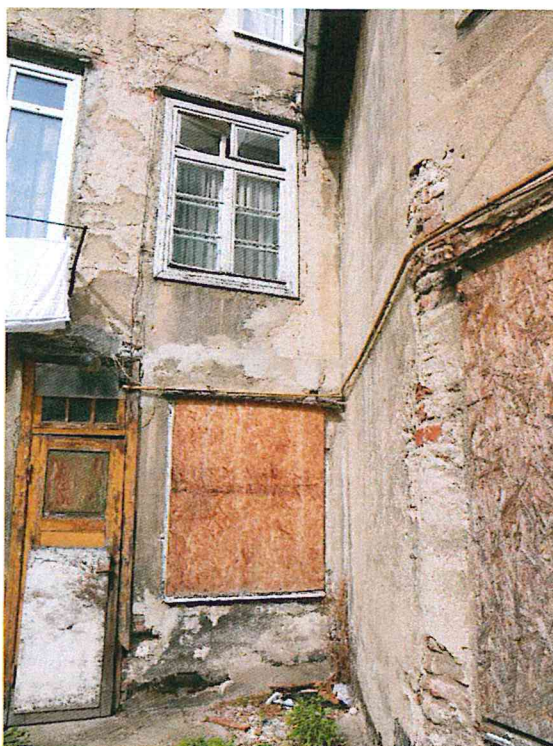
13. Gdańsk, Plac Wałowy 9, elewacja południowo – wschodnia. Widoczny stan zachowania elewacji tylnej i oficyny.
