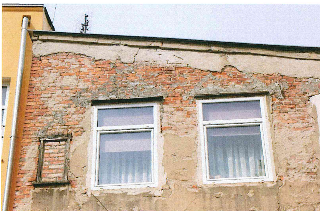
12. Gdańsk, Plac Wałowy 9, elewacja południowo-wschodnia. Widoczne ubytki tynku, zamurowany mały otwór okienny, współcześnie wstawione okna bez oryginalnych podziałów.
