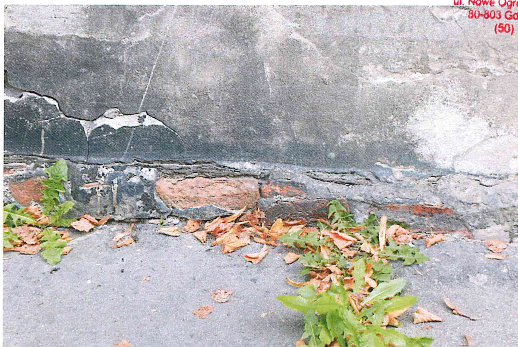
17. Gdańsk, Plac Wałowy 9, elewacja północno – zachodnia. Fragment partii przyziemia; ubytki tynku, ślady zawilgocenia oraz zniszczenia cegieł.
