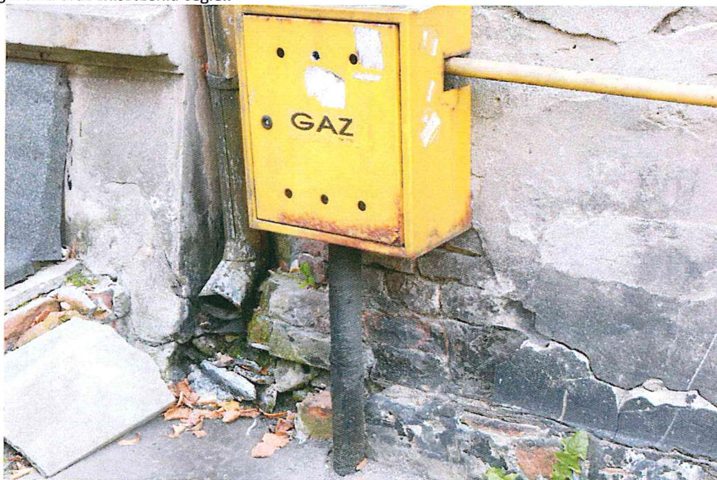
18. Gdańsk, ul. Plac Wałowy 9, elewacja północno-zachodnia. Zniszczenia przyziemia elewacji.
