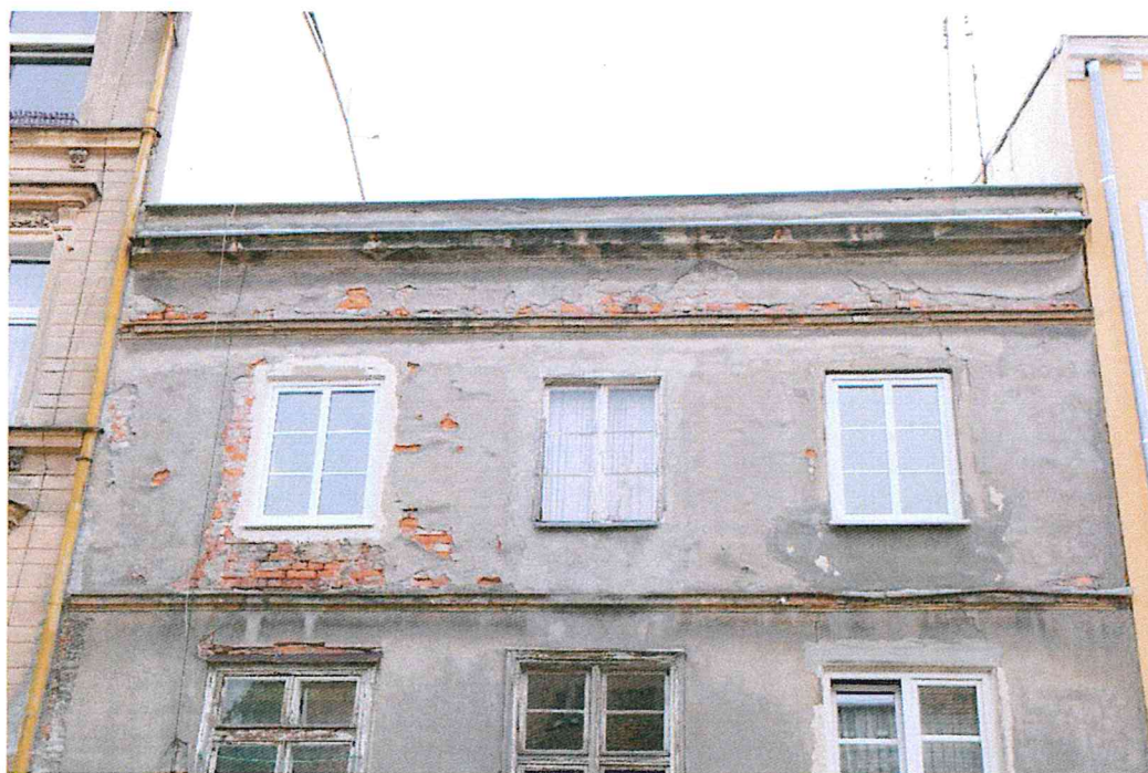
2. Gdańsk, Plac Wałowy 9, elewacja północno-zachodnia. Widoczne zniszczenia elewacji w kondygnacji drugiego piętra: ubytki tynku odsłaniające ceglany mur, naprawa tynku pod oknem wykonana w zaprawie cementowej.
