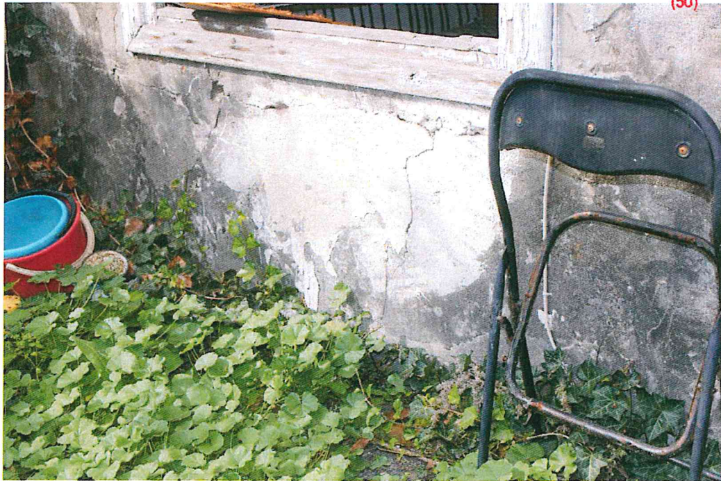
15. Gdańsk, Plac Wałowy 9, elewacja południowo-wschodnia. Widoczne zawilgocenie przyziemia.
