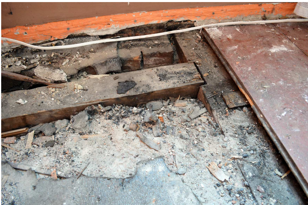
Strop między kondygnacyjny drewniany, pomiędzy belkami nośnymi widoczne przypadkowe wypełnienie gruzem, papą, odpadkami mogącymi negatywnie wpływać na zdrowie mieszkańców budynku – warstwy te nadają się do wymiany
