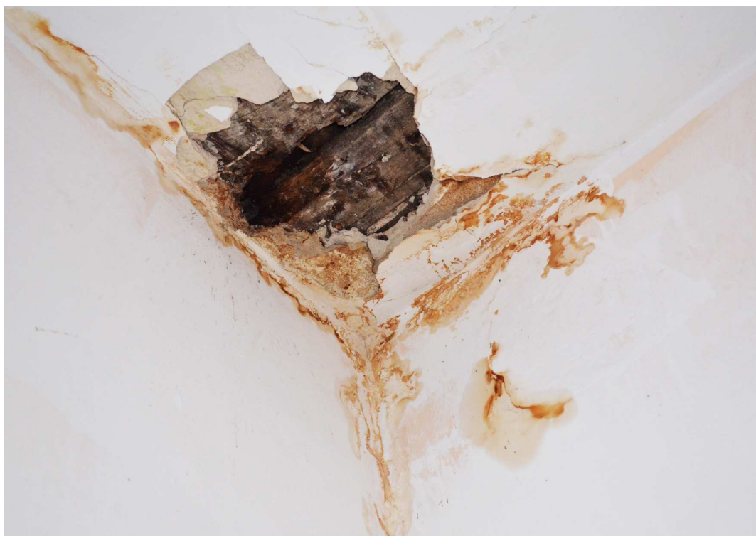
Widok stropu drewnianego od spodu – w miejscach toalet wykonanych samodzielnie przez lokatorów belki nośne stropów narażone na działanie wilgoci nadają się do wymiany
