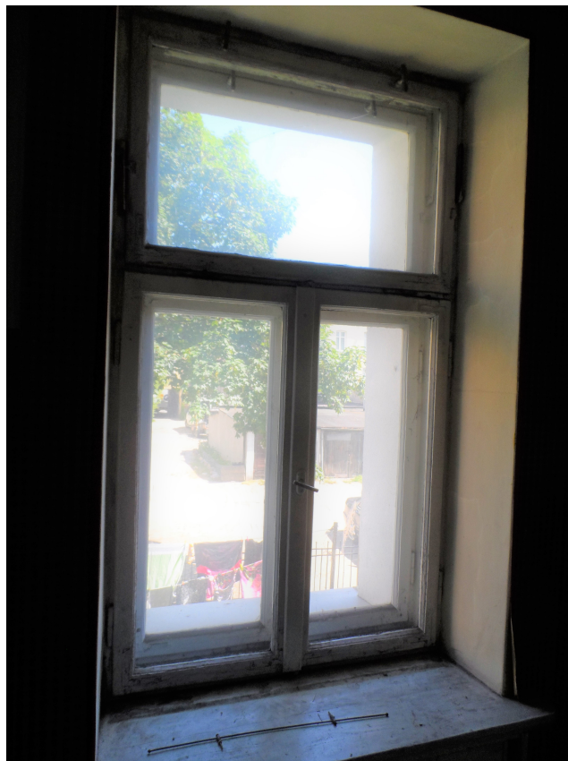
Jedno z okien skrzynkowych (do wymiany)
