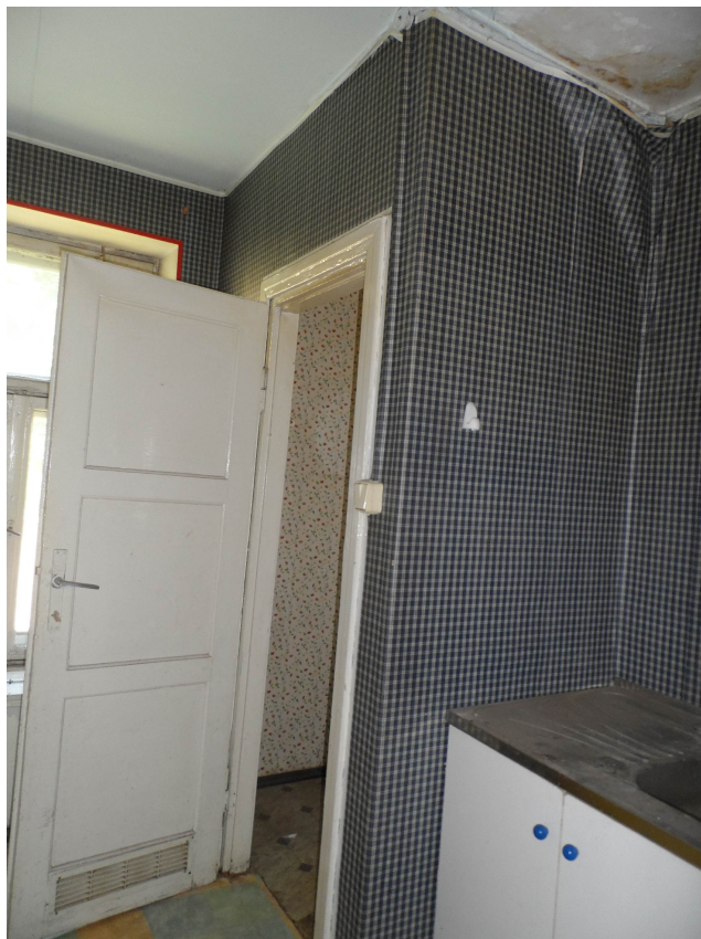
Kuchnia – wejście do łazienki, drzwi do wymiany po poszerzeniu otworu drzwiowego
