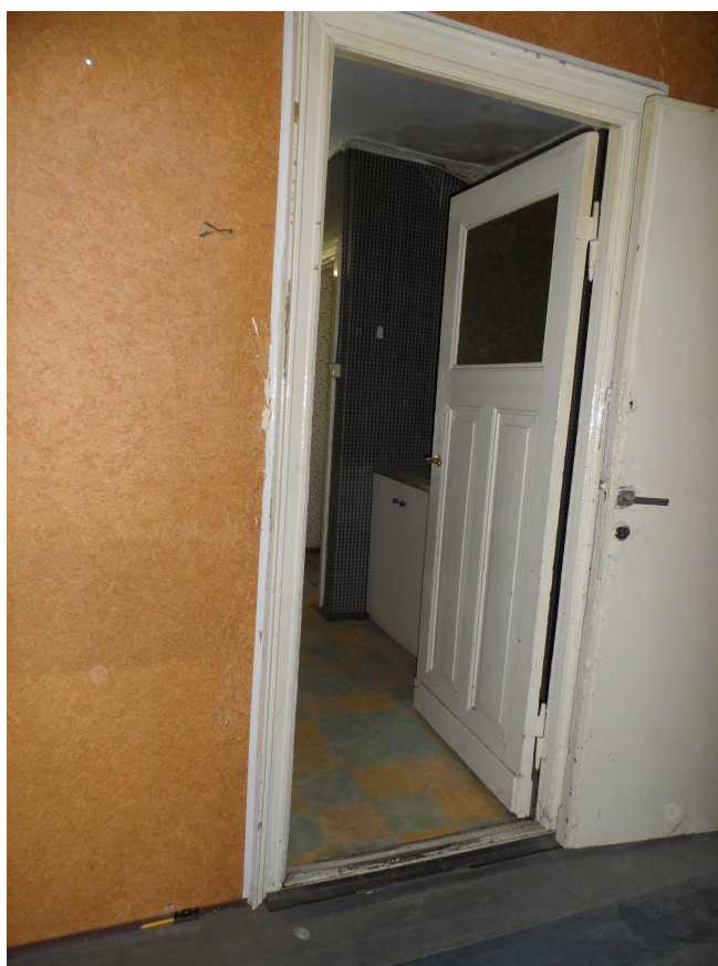
Drzwi z przedpokoju do kuchni – do renowacji
