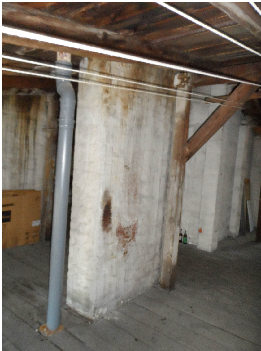
Poddasze - komin z przewodami m.in. mieszkań nr 4 i 11 oraz wywiewka pionu kanalizacyjnego
