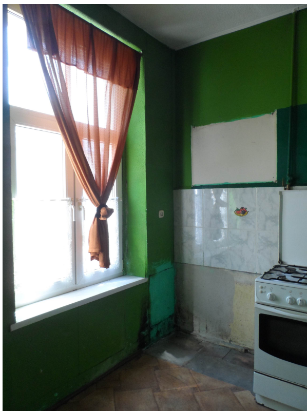
Kuchnia – okno PCV do wymiany na okno drewniane
