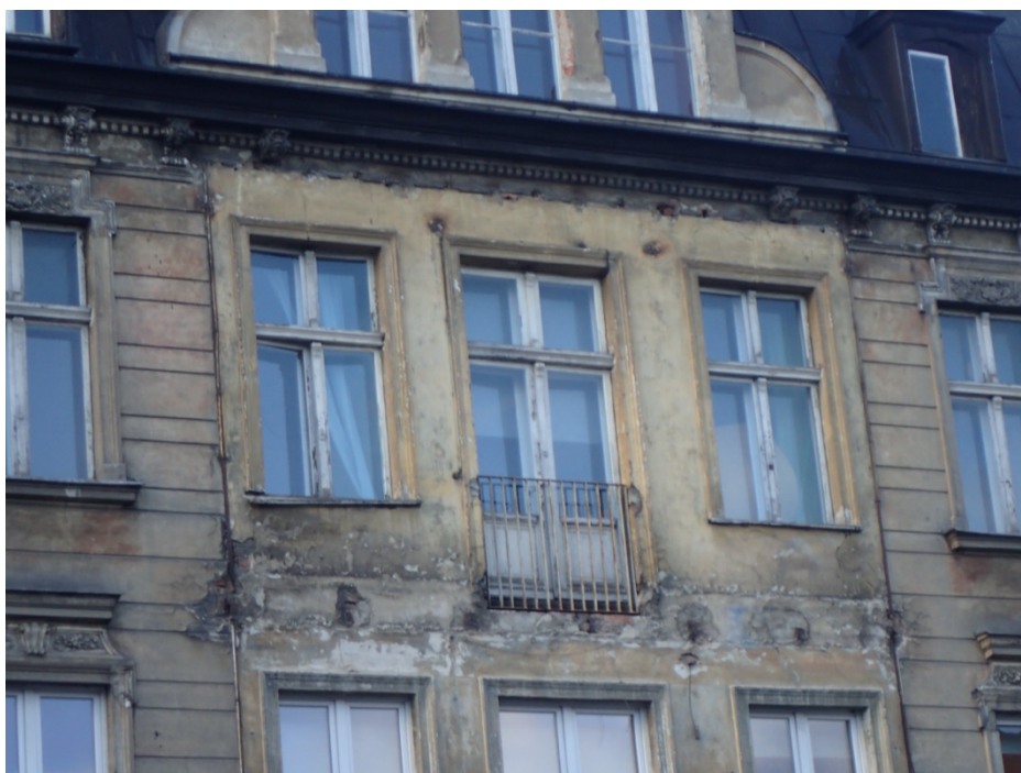
Fot. 4. Elewacja frontowa, widoczne ślady osadzenia w murze konstrukcji nieistniejącej już werandy. W lukarnie po lewej stronie wtórne, jednopodziałowe okno.
