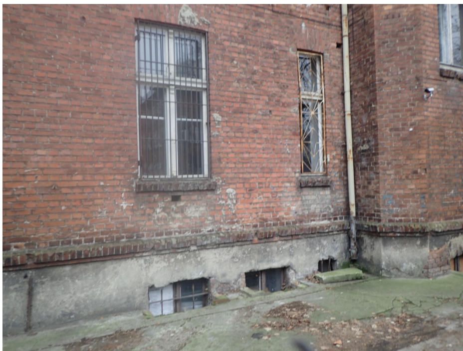
Fot. 41. Elewacja tylna, wtórne, cementowe tynki cokołu. Widoczne przekształcenia nadproży okienek okiennych. Wtórna, spękana wylewka pokryta mikroorganizmami.
