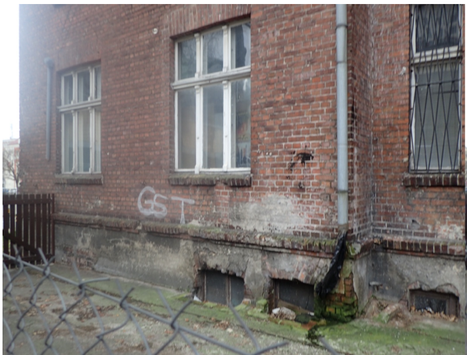
Fot. 37. Elewacja tylna, zniszczenia partii cokołowej oraz opaski cementowej wokół budynku.
