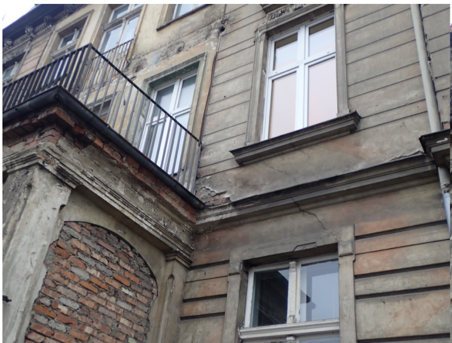
Fot. 15. Elewacja frontowa, przeprucie loggi w parterze zostało wtórnie zamurowane.
