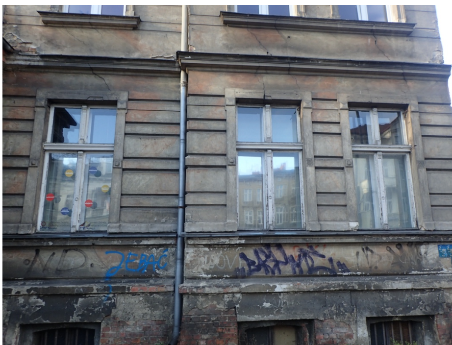
Fot. 8. Elewacja frontowa, stan zachowania przyziemia. Widoczne zabrudzone i zdegradowane tynki, postępująca dezintegracja murów obwodowych oraz grafitti.
