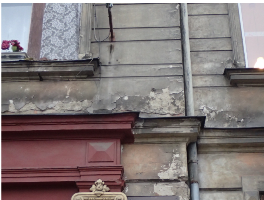
Fot. 16. Elewacja frontowa, widoczne zniszczenia wypraw tynkarskich i detalu architektonicznego. Portal o wtórnej kolorystyce.
