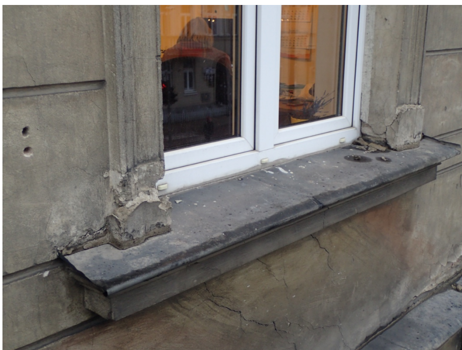
Fot. 14. Elewacja frontowa, stan zachowania opierzeń blacharskich.
