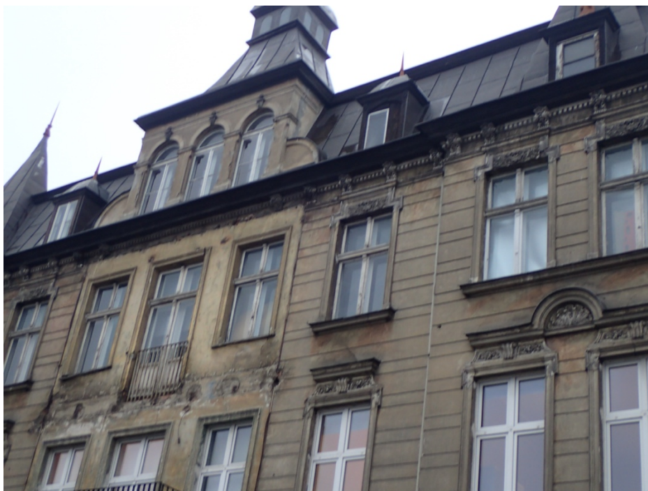
Fot. 3. Elewacja frontowa, w części centralnej widoczne ślady osadzenia w murze konstrukcji nieistniejącej już werandy.
