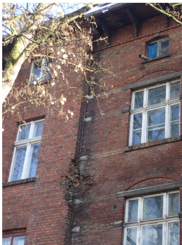
Fot. 35. Elewacja tylna, zniszczenia ryzalitu
