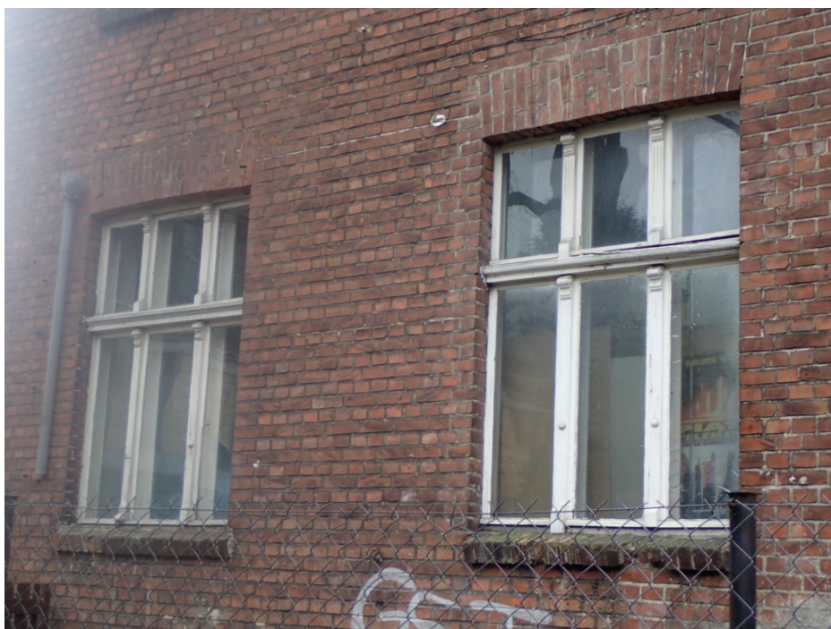
Fot. 40. Elewacja tylna, widoczne spękania murów ryzalitu, ubytki cegieł parapetu oraz mikroorganizmy porastające elewację na skutek silnego zawilgocenia murów obwodowych.
