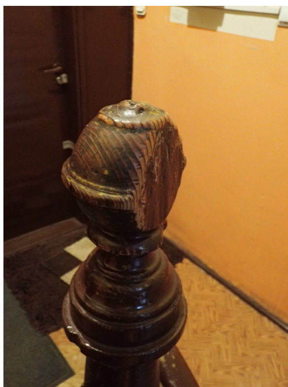
Fot. 50. Klatka schodowa, zwieńczenie słupka pośredniego balustrady. Widoczne uszkodzenie zwieńczenia i części tylnej.
