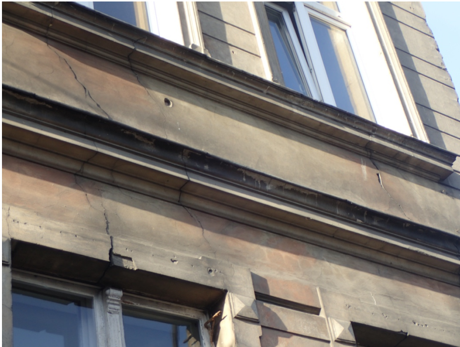
Fot. 11. Elewacja frontowa, widoczne spękania tynków oraz miejsca badań stanu zachowania konstrukcji budynku.
