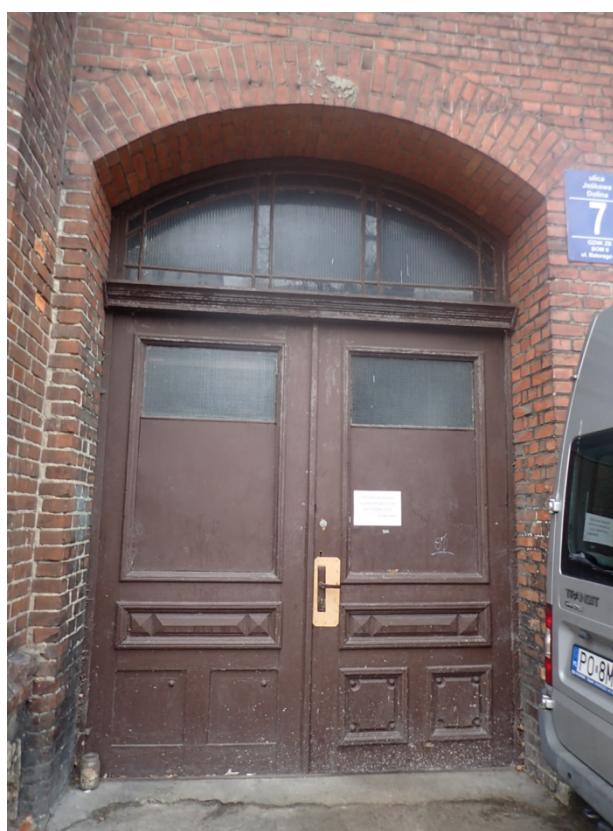
Fot. 34. Elewacja tylna – wejście. Spękana i porośnięta mikroorganizmami wylewka przed wejściem.
