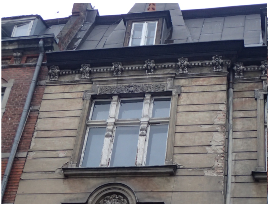
Fot. 5. Elewacja frontowa, oryginalne trójdzielne okno II piętra. Widoczne zniszczenia tynków elewacji.
