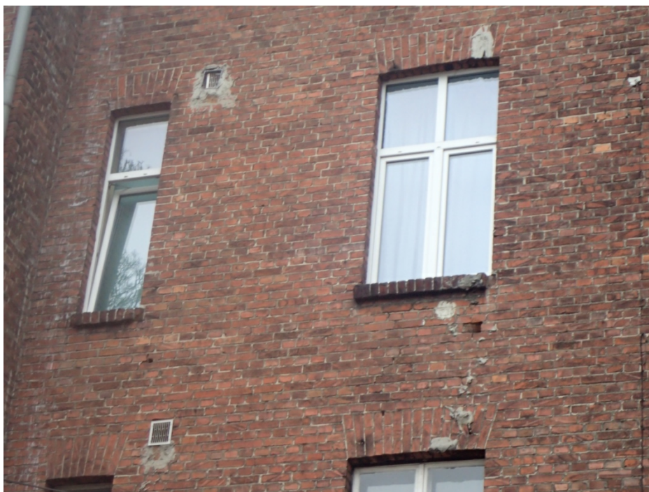
Fot. 39. Elewacja tylna, wtórne przekucia otworów na kratki wentylacyjne oraz współczesna, ahistoryczna stolarka okienna, wykonana z PCV.
