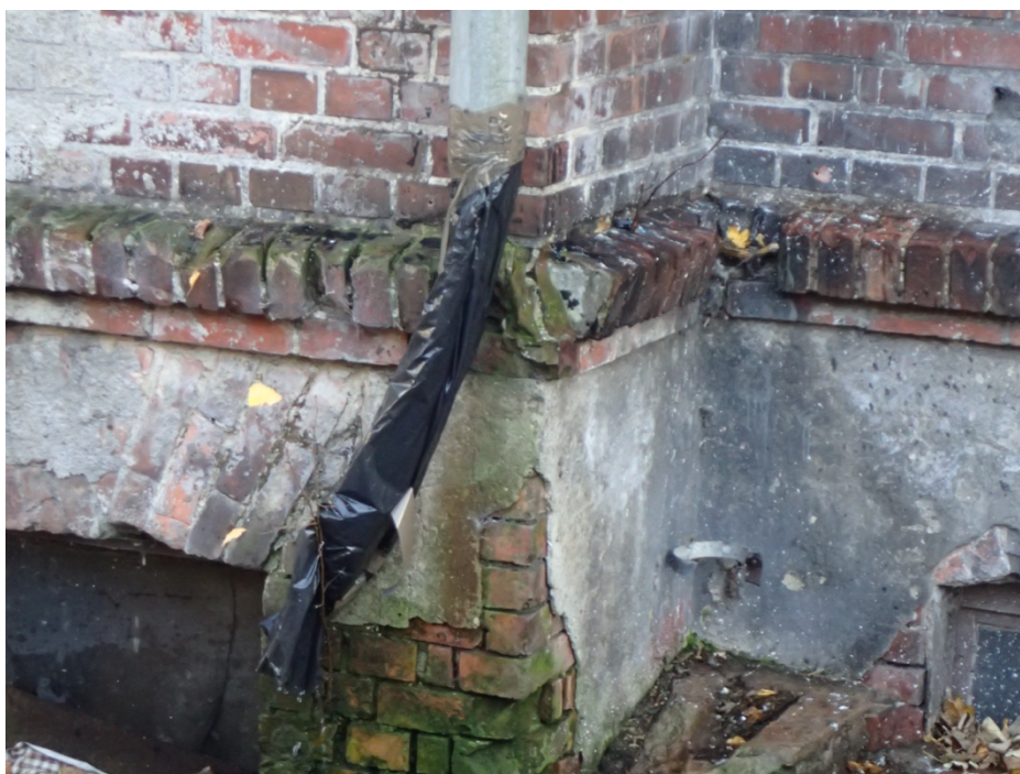
Fot. 38. Elewacja tylna, zniszczenia partii cokołowej oraz opaski cementowej wokół budynku. Urwana rura spustowa powoduje systematyczne zalewanie murów wodą opadową.
