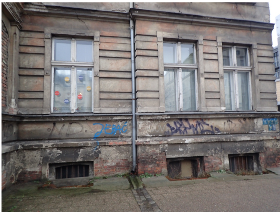
Fot. 25. Elewacja frontowa, stan zachowania partii przyziemia.
