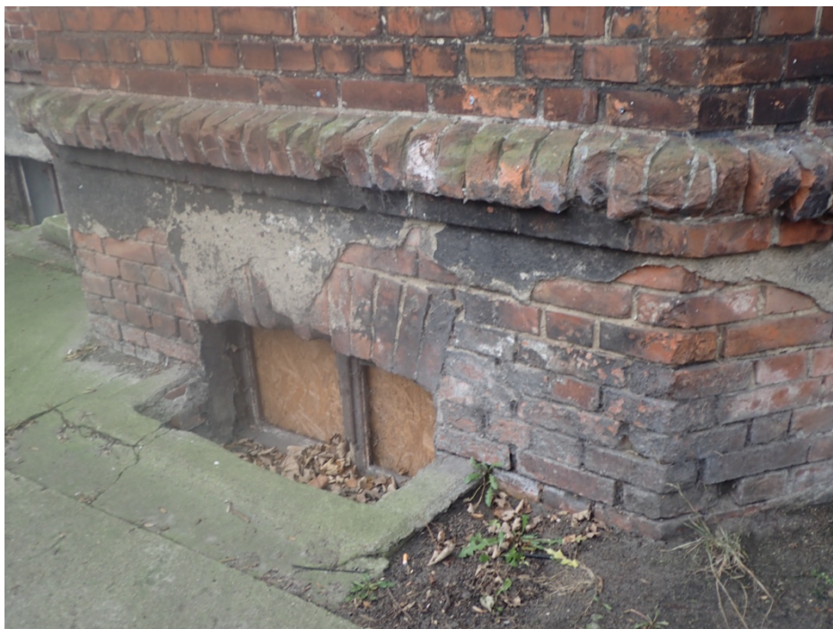
Fot. 42. Elewacja tylna, widoczne odparzenia tynków cokołu oraz zniszczenia cegieł gzymsu kordonowego. Otoczenie obiektu porośnięte trawami, wtórna, spękana wylewka pokryta mikroorganizmami.
