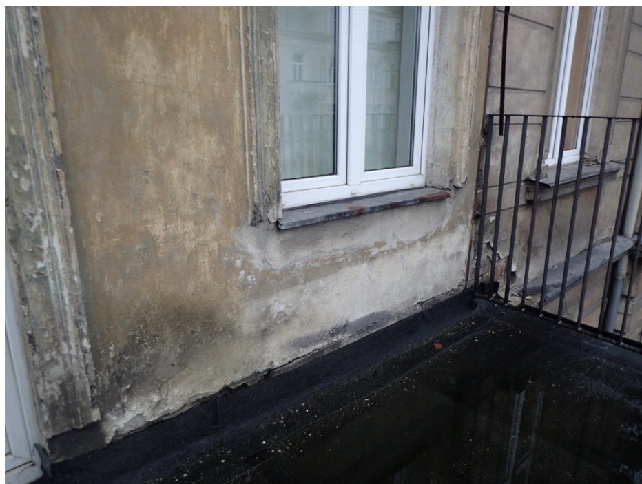
Fot. 18. Elewacja frontowa, izolacja bitumiczna stropu loggii parteru (obecnie balkon). Zalegająca i odbita woda opadowa powoduje zawilgocenie murów i rozwój mikroorganizmów.
