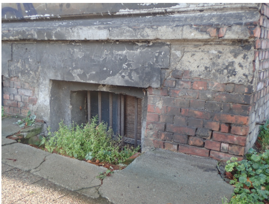
Fot. 26. Elewacja frontowa, widoczna daleko posunięta dezintegracja murów. Wtórna wylewka cementowa jest spękana i porośnięta zielenią.
