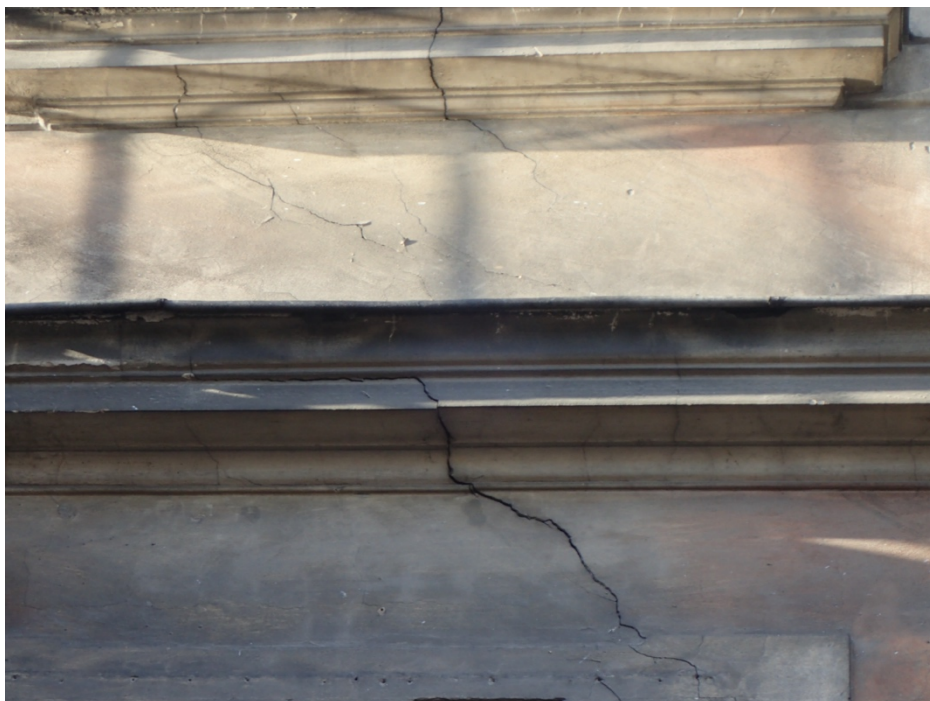
Fot. 12. Elewacja frontowa, widoczne liczne spękania tynków.
