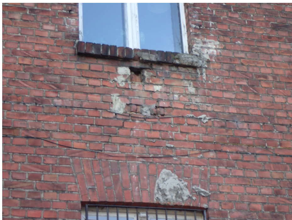
Fot. 36. Elewacja tylna, widoczne zniszczenia elewacji, w tym parapetów oraz zachłapania zaprawą cementową.
