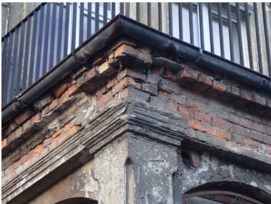
Fot. 20. Elewacja frontowa, zniszczenia murów loggii na skutek penetracji wód opadowych.
