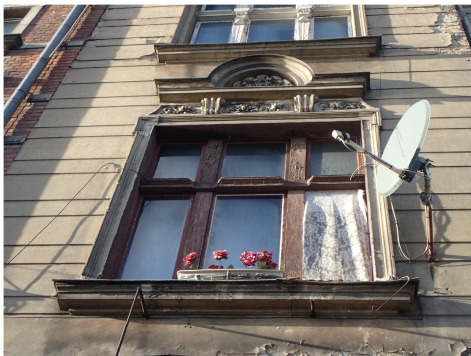
Fot. 6. Elewacja frontowa, okno trójdzielne I piętra. Zachowane ślemię, pozostałe elementy konstrukcyjne pozbawione dekoracji. Drewno zdegradowane.
