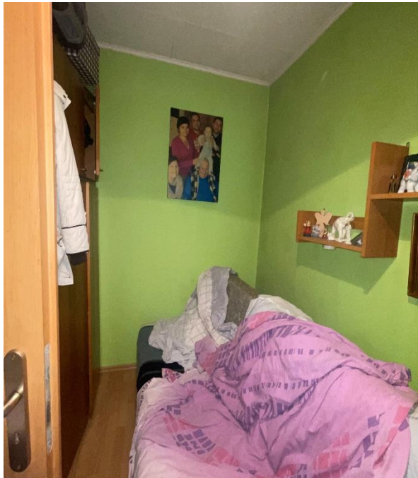
zdjęcie (zasoby własne) nr 26 – pokój 1.04 – widok na ścianę wewnętrzną dzielącą lokale mieszkalne.
