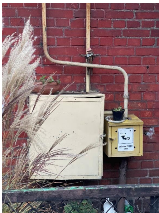
zdjęcie (zasoby własne) nr 42 – elewacja wschodnia. Licznik gazu oraz główny zawór gazu.
