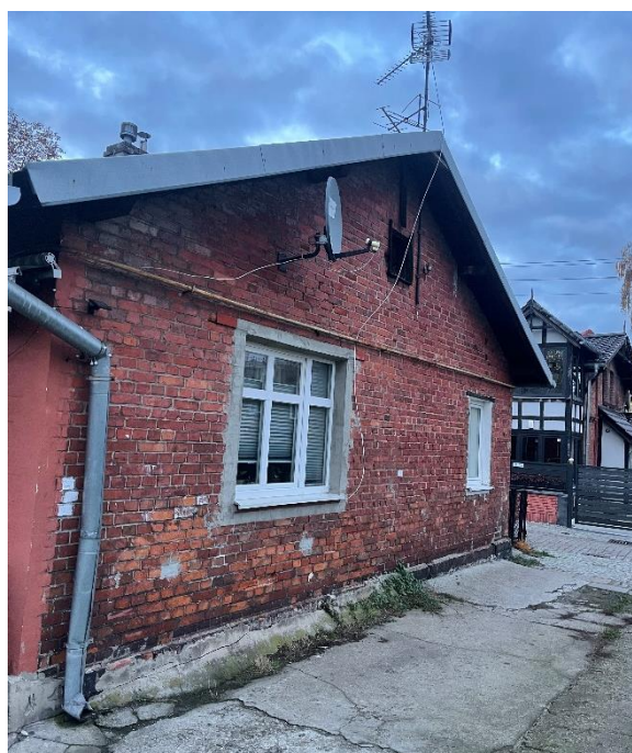
zdjęcie (zasoby własne) nr 22 – elewacja południowa – zabrudzenie, przebarwienia cegieł.
