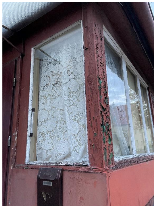
zdjęcie (zasoby własne) nr 38 – stan zachowania drewnianych okien w dobudówce os strony wschodniej.
