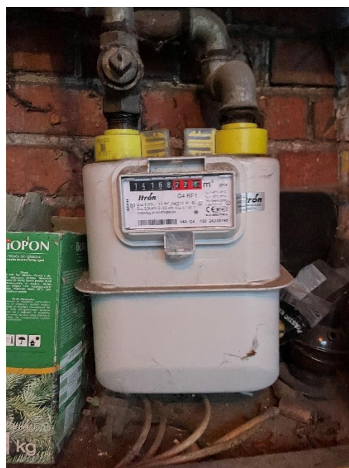
zdjęcie (zasoby własne) nr 43 – elewacja zachodnia – licznik gazu.
