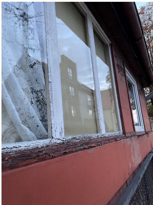
zdjęcie (zasoby własne) nr 37 – stan zachowania drewnianych okien w dobudówce os strony wschodniej.
