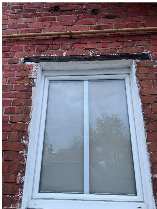
zdjęcie (zasoby własne) nr 19 – drewniane nadproże, niewielka rysa nad oknem.
