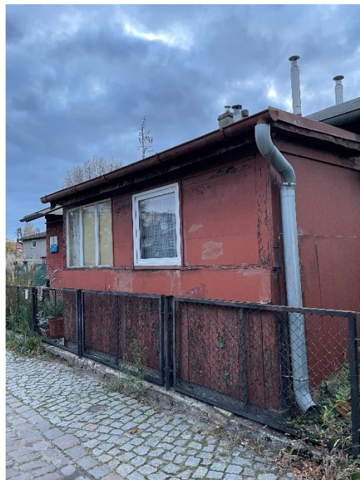
zdjęcie (zasoby własne) nr 18 – dobudówka w elewacji wschodniej – niejednolity materiał wykończeniowy ścian.
