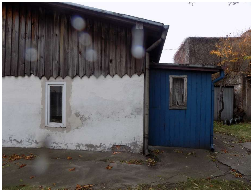
zdjęcie (zasoby własne) nr 41 – widok na okno wtórne z PCV oraz okno drewniane dobudówki – w średnim stanie technicznym.
