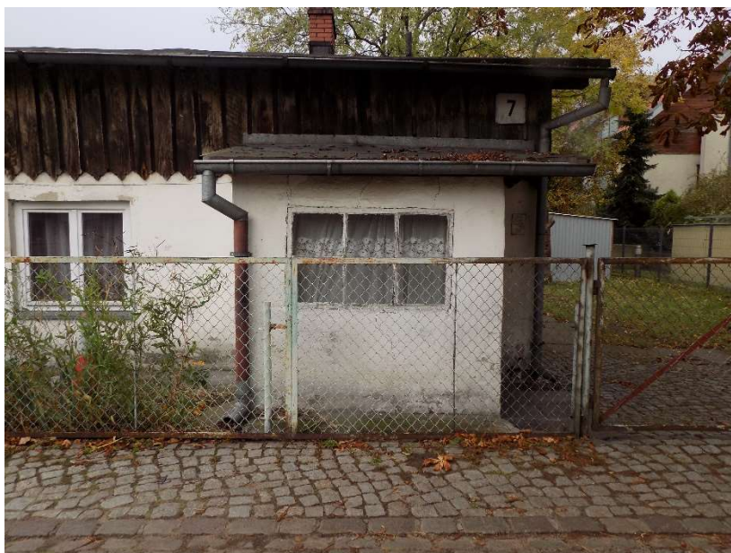
zdjęcie (zasoby własne) nr 42 – stan zachowania drewnianych okien w dobudówce od strony wschodniej.
