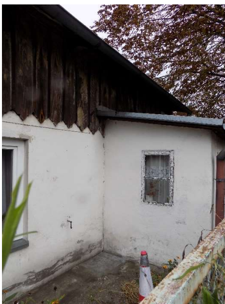
zdjęcie (zasoby własne) nr 43 – stan zachowania drewnianych okien w dobudówce od strony wschodniej.
