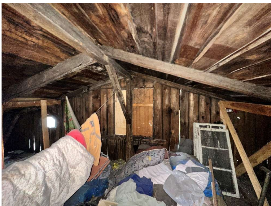
zdjęcie (zasoby własne) nr 40 – więźba dachowa – widoczny stan deskowania.
