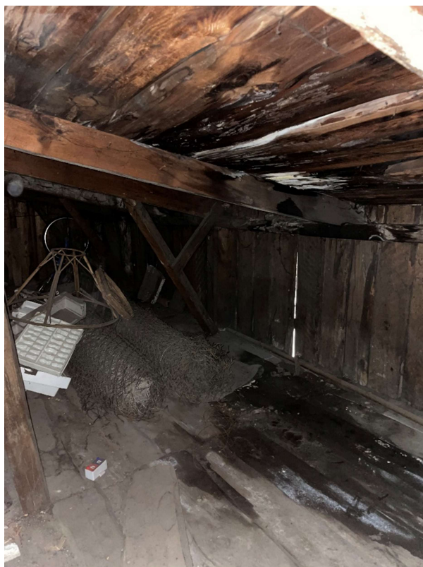
zdjęcie (zasoby własne) nr 27 – zalanie stropu poddasza nieużytkowego.
