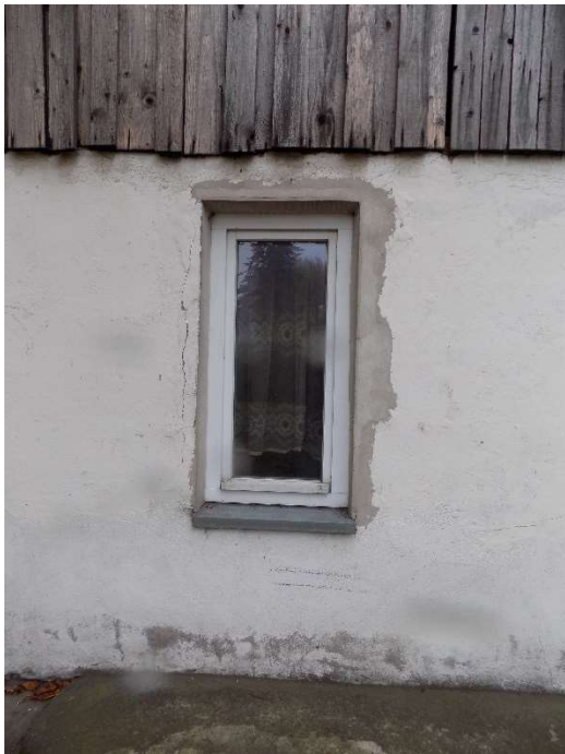
zdjęcie (zasoby własne) nr 19 – elewacja północna – rysa przy oknie. Widoczny brak rzeźbiarskich zakończeń okładziny drewnianej.
