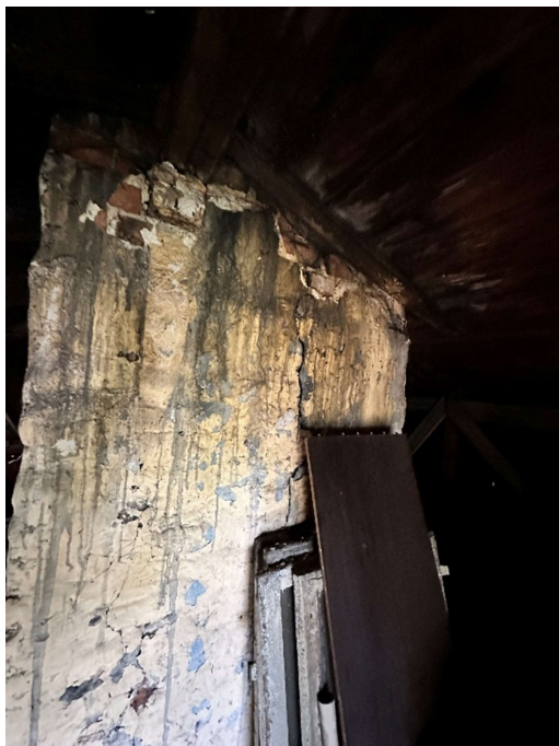
zdjęcie (zasoby własne) nr 33 – więźba dachowa – widok na zniszczenia wyprawy komina spowodowane nieszczelnościami przekrycia dachowego.
