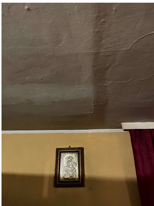
zdjęcie (zasoby własne) nr 31 – pokój 1.06 – widoczne rysy na suficie.
