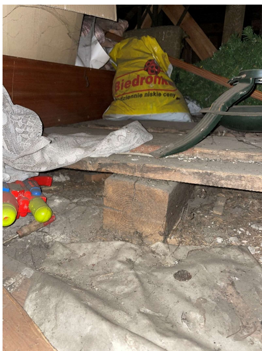
zdjęcie (zasoby własne) nr 28 – odkrywka O7 stropu międzykondygnacyjnego. Uskok w wysokości stropu – strop podniesiony.
