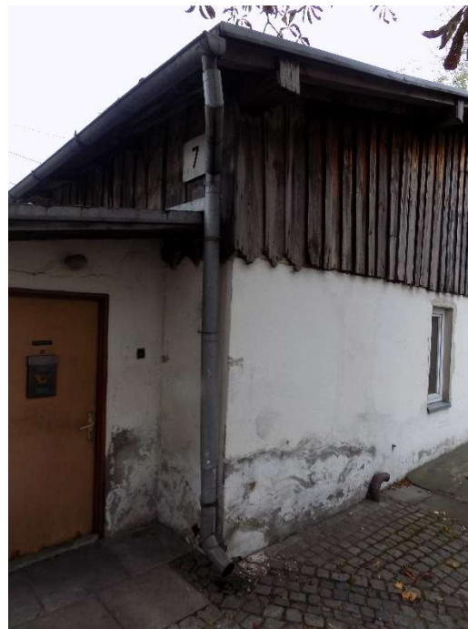
zdjęcie (zasoby własne) nr 18 – silne zabrudzenie, zawilgocenie ścian przyziemia.
