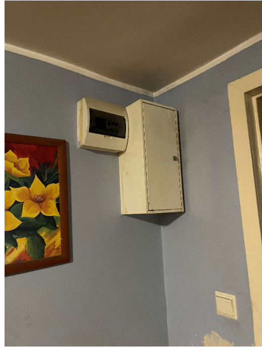
zdjęcie (zasoby własne) nr 47 – kuchnia 1.03 - rozdzielnia i licznik energii elektrycznej.
