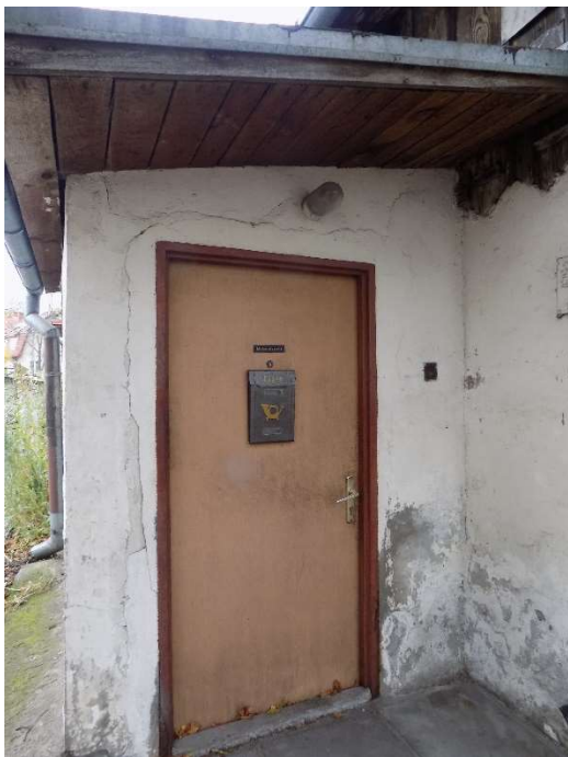
zdjęcie (zasoby własne) nr 17 – dobudówka w elewacji wschodniej – rysy ściany przy drzwiach.
