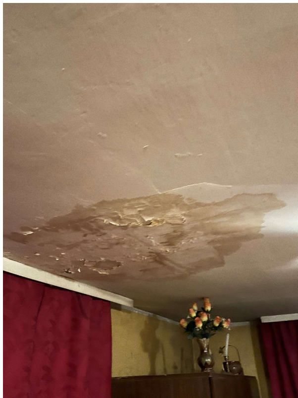
zdjęcie (zasoby własne) nr 30 – pokój 1.06 - uszkodzenie spowodowane długotrwałym zalewaniem stropu.
