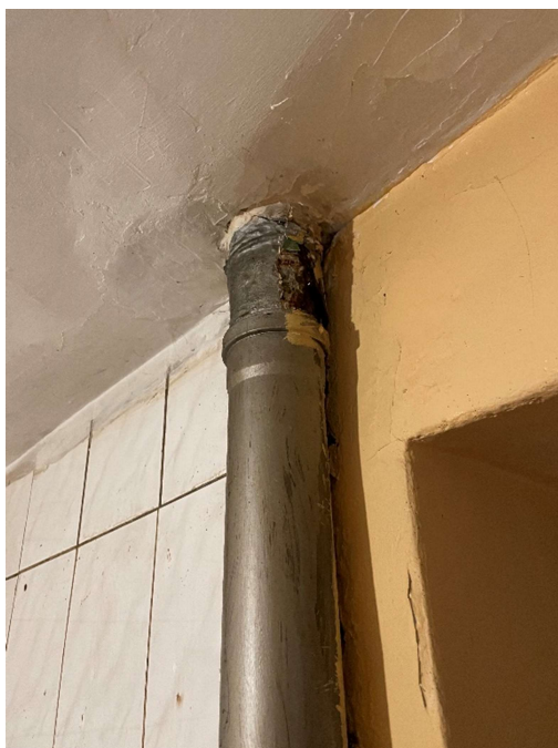
zdjęcie (zasoby własne) nr 45 – pion odpowietrzający kanalizację – widoczne ślady korozji.
