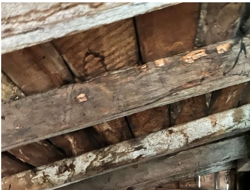
zdjęcie (zasoby własne) nr 37 – więźba dachowa – złaewane krokwie.
