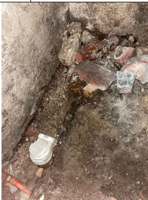
zdjęcie (zasoby własne) nr 44 – podpiwniczenie, licznik wody.
