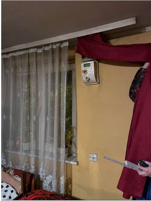
zdjęcie (zasoby własne) nr 46 – pokój 1.06– widoczna rozdzielnia elektryczna.
