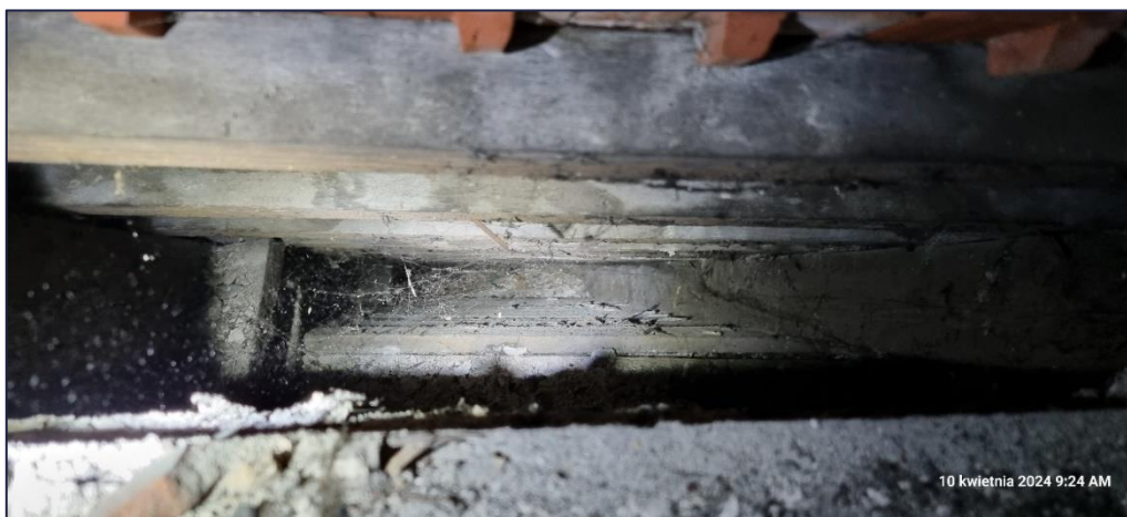
Foto 103. Widok stanu technicznego konstrukcji więźby dachowej; Wizja wykonana z przestrzeni części nieużytkowej poddasza (strych) – odkrywka OW-1;
