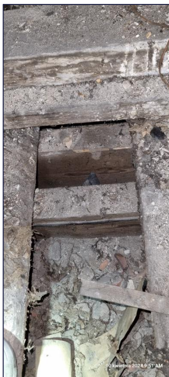
Foto 122. Widok stanu technicznego poszycia stropu nad poddaszem użytkowym; Widok deskowania górnego pułapu - powały na kleszczach i jętkach dachowych; Wizja wykonana z przestrzeni części nieużytkowej poddasza (strych) - odkrywka OW-1;
