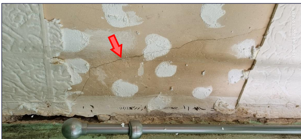
Foto 50. Widok stanu technicznego konstrukcji stropu nad parterem w miejscu oparcia belki na ścianie południowej budynku – odkrywka OS-1; Uszkodzenia przegród / elementów budynku zaznaczono kolorem czerwonym;
