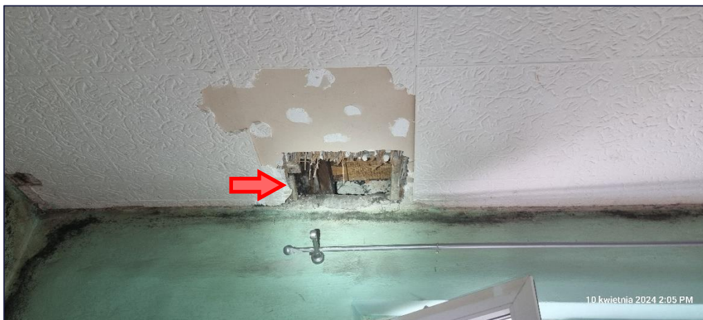
Foto 51. Widok stanu technicznego konstrukcji stropu nad parterem w miejscu oparcia belki na ścianie południowej budynku - odkrywka OS-1; Uszkodzenia przegród / elementów budynku zaznaczono kolorem czerwonym;
