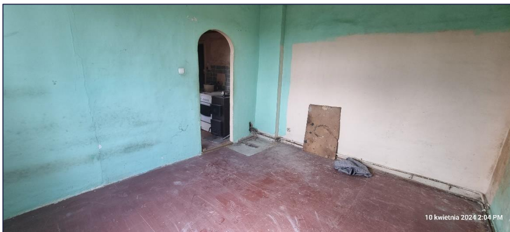
Foto 43. Widok stanu technicznego przegród budowlanych z pomieszczenia M2.04;
