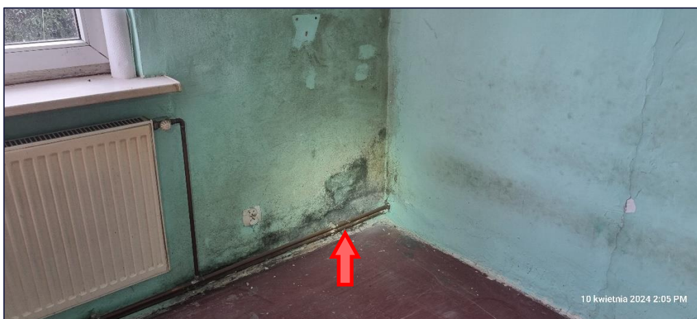
Foto 64. Widok stanu technicznego przegród budowlanych z pomieszczenia M2.04; Uszkodzenia przegród / elementów budynku zaznaczono kolorem czerwonym;
