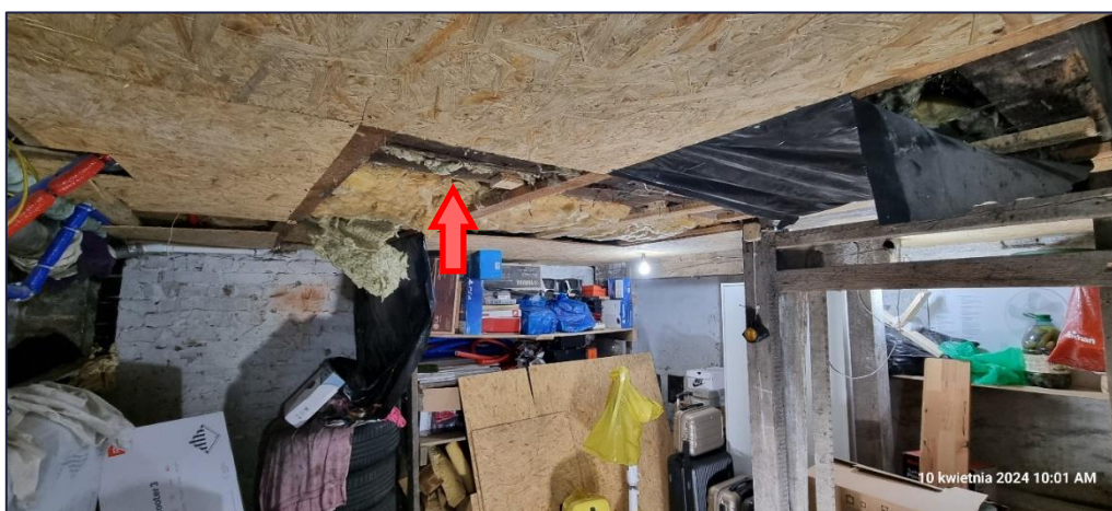
Foto 10. Widok stanu technicznego konstrukcji stropu nad piwnicą; Odkrywką przepony poziomej OS-1; Uszkodzenia przegród / elementów budynku zaznaczono kolorem czerwonym;
