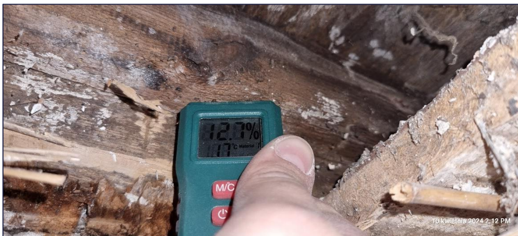
Foto 76. Widok stanu technicznego konstrukcji stropu nad parterem w miejscu oparcia belki na ścianie południowej budynku; Pomiar wilgotności belki drewnianej – pomiar PW-5;
