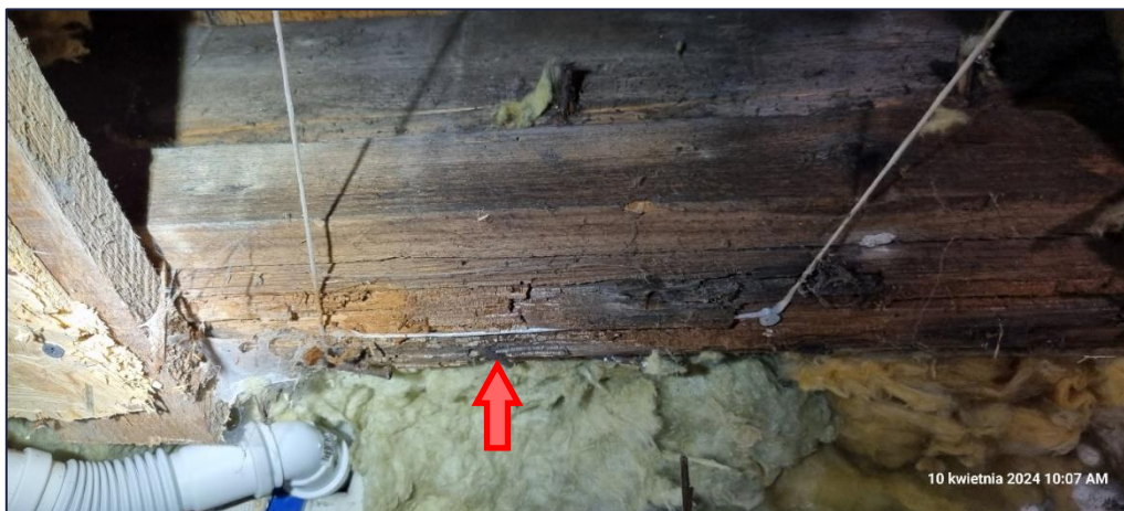
Foto 22. Widok stanu technicznego konstrukcji stropu nad piwnicą; Odkrywką przepony poziomej OS-1; Uszkodzenia przegród / elementów budynku zaznaczono kolorem czerwonym;
