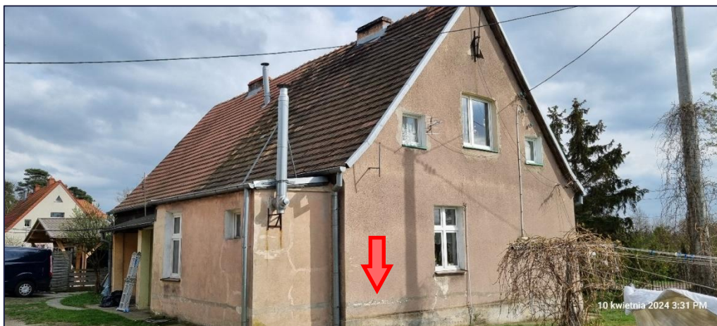
Foto 5. Widok stanu technicznego elewacji północnej i zachodniej budynku; Na zdjęciu widoczna część bliźniaka – budynek 12B; Na elewacji budynku widoczne pozostałości po wykonaniu ciśnieniowej izolacji poziomej ściany budynku;
