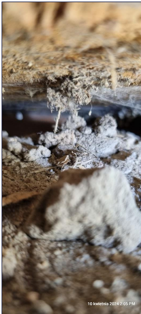
Foto 46. Widok stanu technicznego posadzki na gruncie w pomieszczeniu M2.04; Odkrywka posadzki na gruncie – odkrywka OP-1;
