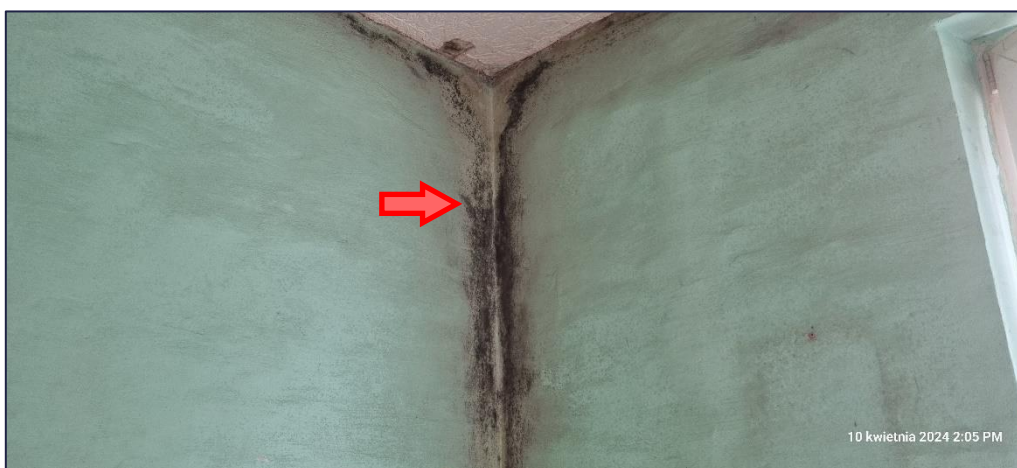
Foto 49. Widok stanu technicznego przegród budowlanych z pomieszczenia M2.04; Uszkodzenia przegród / elementów budynku zaznaczono kolorem czerwonym;
