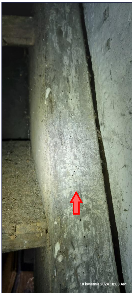
Foto 35. Widok stanu technicznego konstrukcji schodów drabiniastych; Uszkodzenia przegród / elementów budynku zaznaczono kolorem czerwonym;
