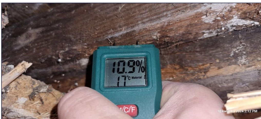
Foto 75. Widok stanu technicznego konstrukcji stropu nad parterem w miejscu oparcia belki na ścianie południowej budynku; Pomiar wilgotności belki drewnianej – pomiar PW-5;
