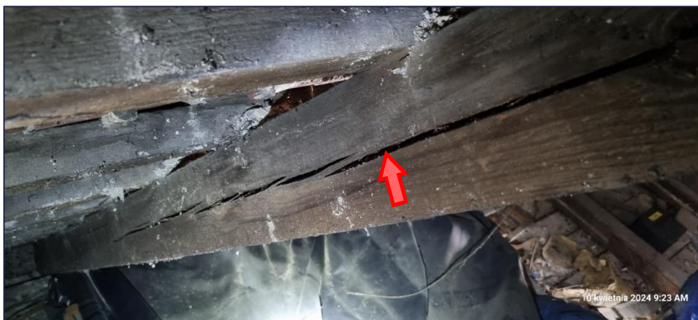
Foto 94. Widok stanu technicznego konstrukcji więźby dachowej; Uszkodzenia przegród / elementów budynku zaznaczono kolorem czerwonym; Wizja wykonana z przestrzeni części nieużytkowej poddasza (strych) – odkrywka OW-1;
