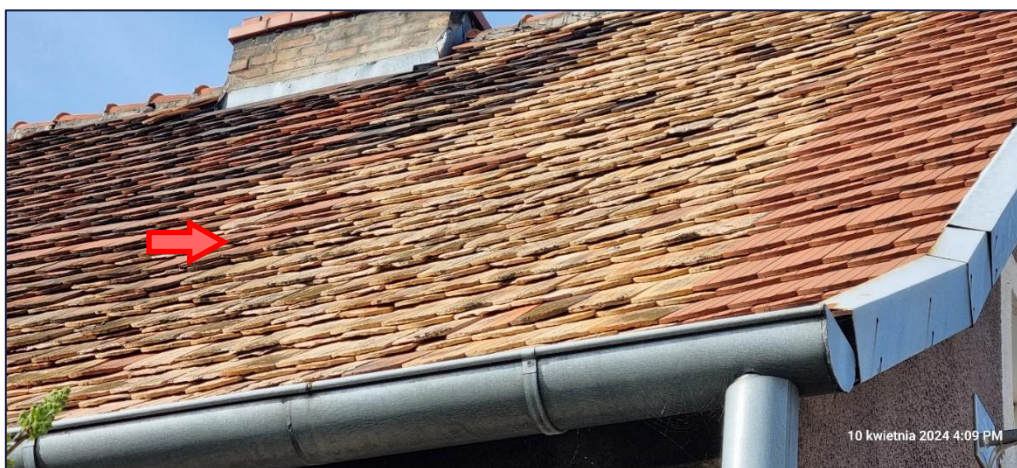
Foto 4. Widok stanu technicznego pokrycia południowej połaci dachu; Uszkodzenia przegród / elementów budynku zaznaczono kolorem czerwonym;
