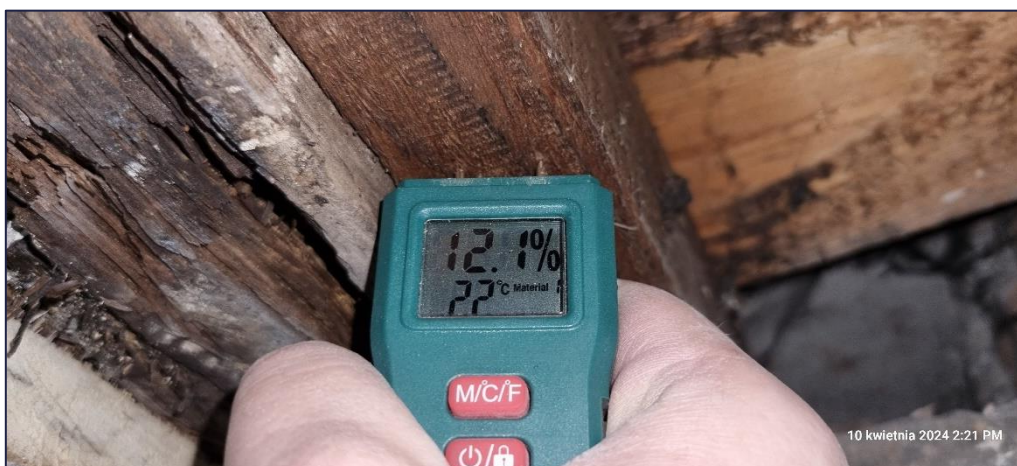
Foto 60. Widok stanu technicznego konstrukcji stropu nad parterem w miejscu oparcia belki na ścianie południowej budynku; Pomiar wilgotności belki drewnianej – pomiar PW-4;
