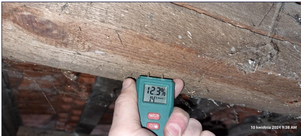
Foto 113. Widok stanu technicznego konstrukcji więźby dachowej; Pomiar wilgotności krokwii dachowych; Wizja wykonana z przestrzeni części nieużytkowej poddasza (strych) – odkrywka OW-1;
