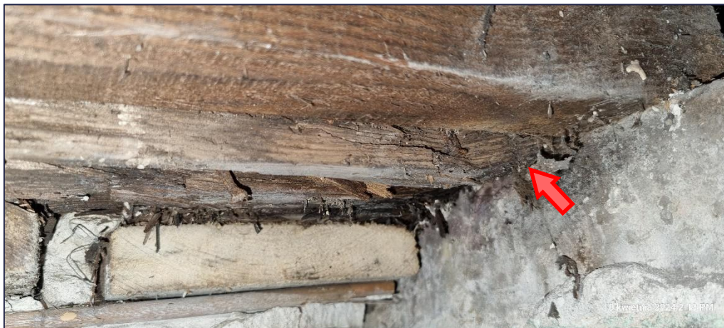
Foto 54. Widok stanu technicznego konstrukcji stropu nad parterem w miejscu oparcia belki na ścianie południowej budynku – odkrywka OS-1; Uszkodzenia przegród / elementów budynku zaznaczono kolorem czerwonym;
