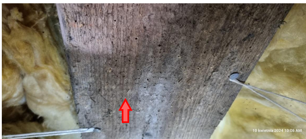
Foto 20. Widok stanu technicznego konstrukcji stropu nad piwnicą; Odkrywa przepony poziomej OS-1; Uszkodzenia przegród / elementów budynku zaznaczono kolorem czerwonym;
