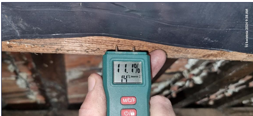
Foto 111. Widok stanu technicznego konstrukcji więźby dachowej; Pomiar wilgotności krokwi dachowych; Wizja wykonana z przestrzeni części nieużytkowej poddasza (strych) – odkrywka OW-1;
