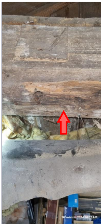
Foto 15. Widok stanu technicznego konstrukcji stropu nad piwnicą; Odkrywka przepony poziomej OS-1; Uszkodzenia przegród / elementów budynku zaznaczono kolorem czerwonym;
