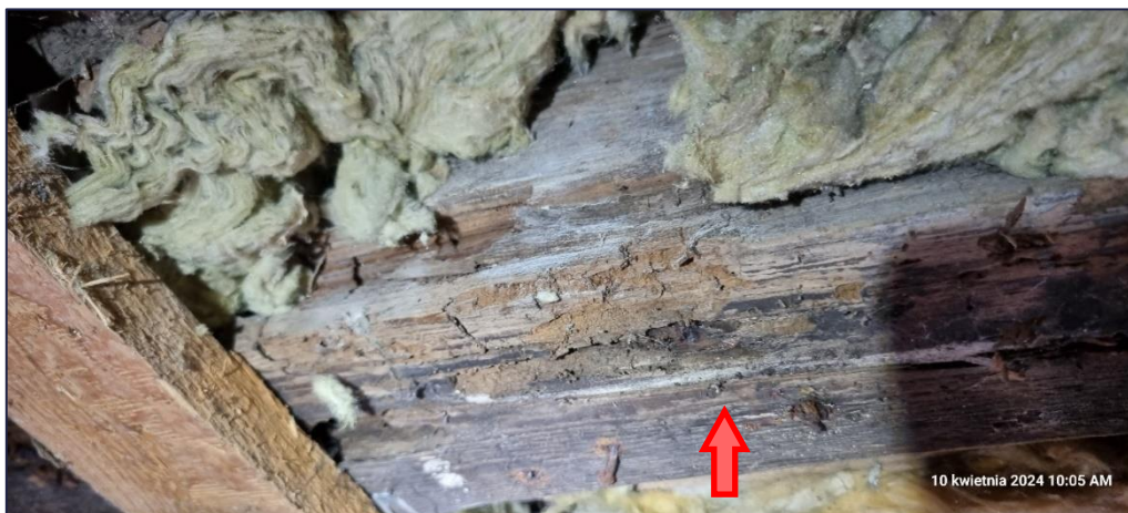
Foto 19. Widok stanu technicznego konstrukcji stropu nad piwnicą; Odkrywa przepony poziomej OS-1; Uszkodzenia przegród / elementów budynku zaznaczono kolorem czerwonym;
