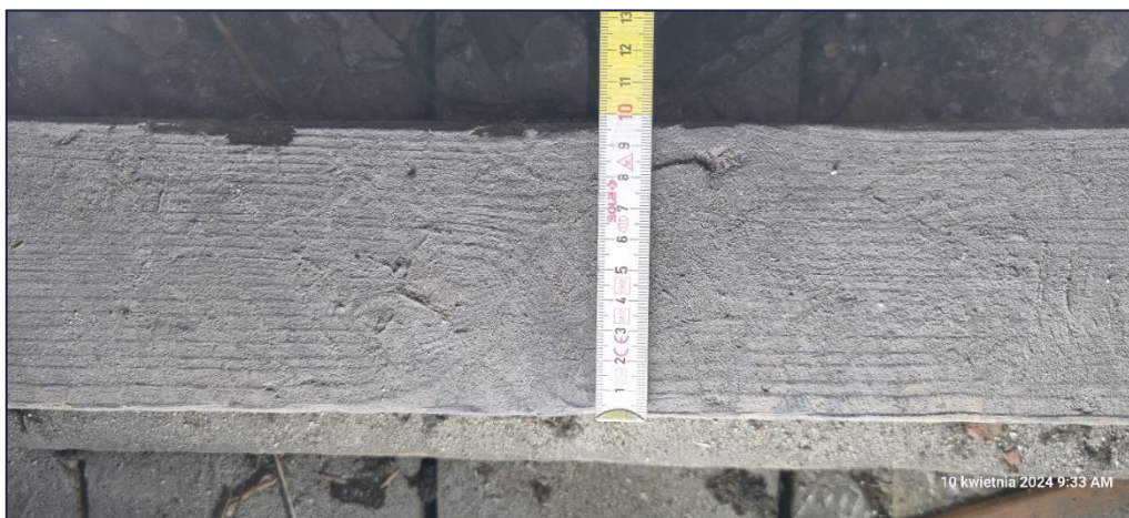
Foto 118. Widok stanu technicznego konstrukcji więźby dachowej; Pomiar szerokości dodatkowej jętki nad stropem; Wizja wykonana z przestrzeni części nieużytkowej poddasza (strych) – odkrywka OW-1;
