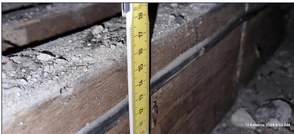
Foto 124. Widok stanu technicznego kleszczy więzara płatwiowo-kleszczowego; Pomiar wysokości kleszczy; Wizja wykonana z przestrzeni części nieużytkowej poddasza (strych) – odkrywka OW-1;
