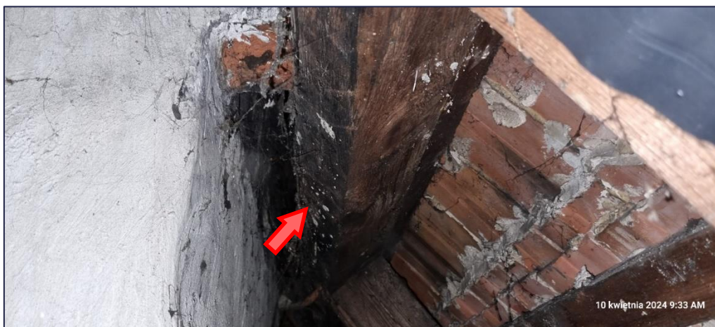
Foto 102. Widok stanu technicznego konstrukcji więźby dachowej; Uszkodzenia przegród / elementów budynku zaznaczono kolorem czerwonym; Wizja wykonana z przestrzeni części nieużytkowej poddasza (strych) – odkrywka OW-1;
