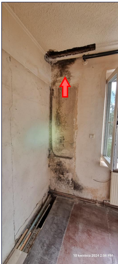
Foto 65. Widok stanu technicznego przegród budowlanych z pomieszczenia M2.03; Uszkodzenia przegród / elementów budynku zaznaczono kolorem czerwonym;
