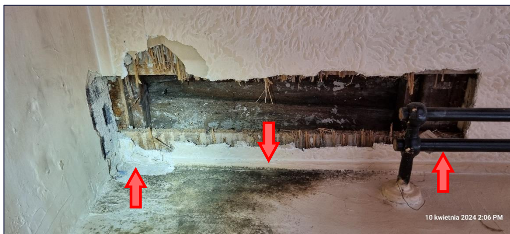
Foto 66. Widok stanu technicznego konstrukcji stropu nad parterem w miejscu oparcia belki na ścianie południowej budynku – odkrywka OS-2; Uszkodzenia przegród / elementów budynku zaznaczono kolorem czerwonym;
