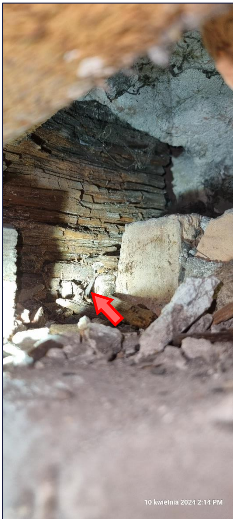
Foto 57. Widok stanu technicznego konstrukcji stropu nad parterem w miejscu oparcia belki na ścianie południowej budynku – odkrywka OS-1; Uszkodzenia przegród / elementów budynku zaznaczono kolorem czerwonym;
