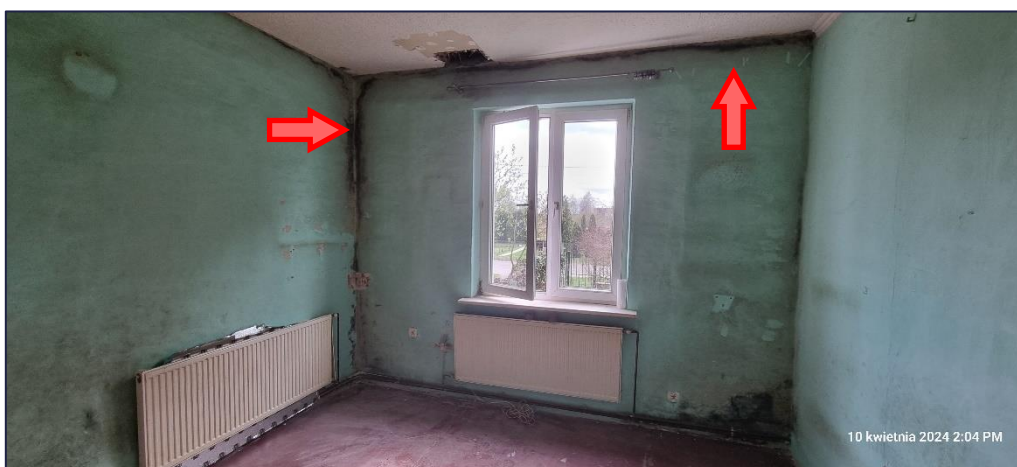
Foto 42. Widok stanu technicznego przegród budowlanych z pomieszczenia M2.04; Uszkodzenia przegród / elementów budynku zaznaczono kolorem czerwonym;
