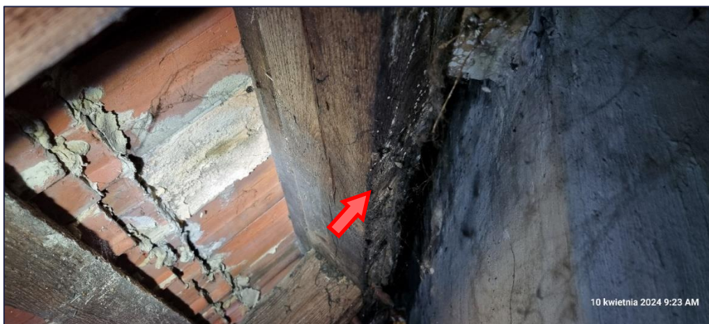
Foto 99. Widok stanu technicznego konstrukcji więźby dachowej; Uszkodzenia przegród / elementów budynku zaznaczono kolorem czerwonym; Wizja wykonana z przestrzeni części nieużytkowej poddasza (strych) – odkrywka OW-1;
