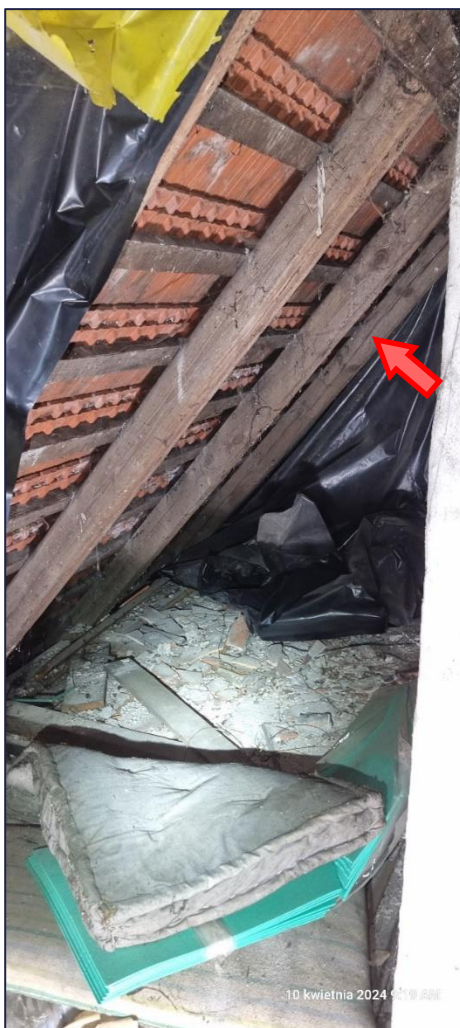
Foto 83. Widok stanu technicznego konstrukcji więźby dachowej; Uszkodzenia przegród / elementów budynku zaznaczono kolorem czerwonym; Wizja wykonana z przestrzeni części nieużytkowej poddasza (strych) – odkrywka OW-1;
