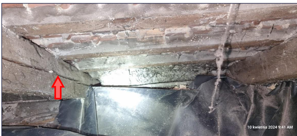
Foto 106. Widok stanu technicznego konstrukcji więźby dachowej; Uszkodzenia przegród / elementów budynku zaznaczono kolorem czerwonym; Wizja wykonana z przestrzeni części nieużytkowej poddasza (strych) – odkrywka OW-1;
