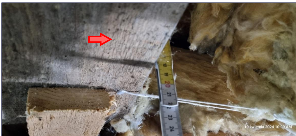
Foto 28. Widok stanu technicznego konstrukcji stropu nad piwnicą; Odkrywka przepony poziomej OS-1; Pomiar wysokości belki; Uszkodzenia przegród / elementów budynku zaznaczono kolorem czerwonym;
