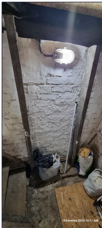
Foto 33. Widok stanu technicznego konstrukcji stropu nad piwnicą; Widok konstrukcji podpierającej główne elementy nośne stropu;
