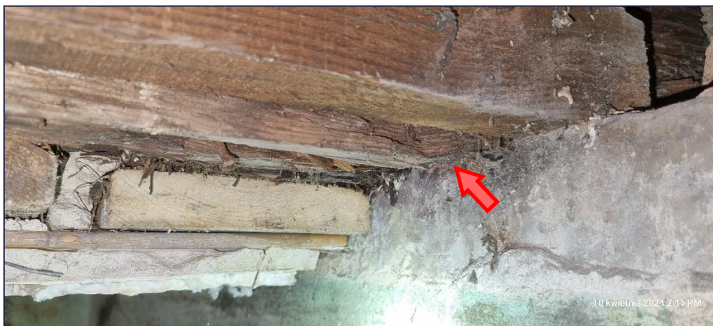
Foto 58. Widok stanu technicznego konstrukcji stropu nad parterem w miejscu oparcia belki na ścianie południowej budynku – odkrywka OS-1; Uszkodzenia przegród / elementów budynku zaznaczono kolorem czerwonym;
