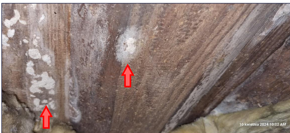
Foto 13. Widok stanu technicznego konstrukcji stropu nad piwnicą; Odkrywka przepony poziomej OS-1; Uszkodzenia przegród / elementów budynku zaznaczono kolorem czerwonym;
