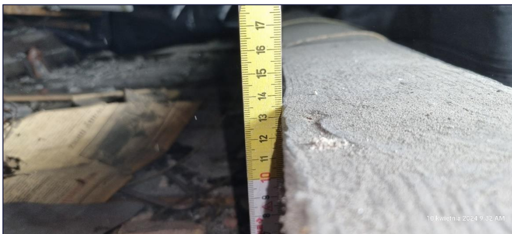
Foto 117. Widok stanu technicznego konstrukcji więźby dachowej; Pomiar wysokości dodatkowej jętki nad stropem; Wizja wykonana z przestrzeni części nieużytkowej poddasza (strych) – odkrywka OW-1;
