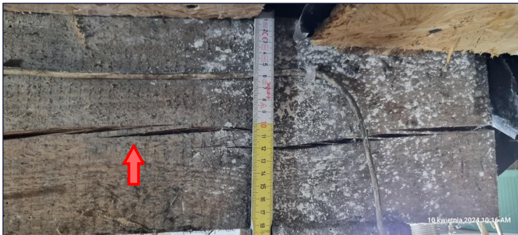
Foto 37. Widok konstrukcji podpierającej główne elementy nośne stropu; Pomiar wysokości rygla ramy drewnianej; Uszkodzenia przegród / elementów budynku zaznaczono kolorem czerwonym;
