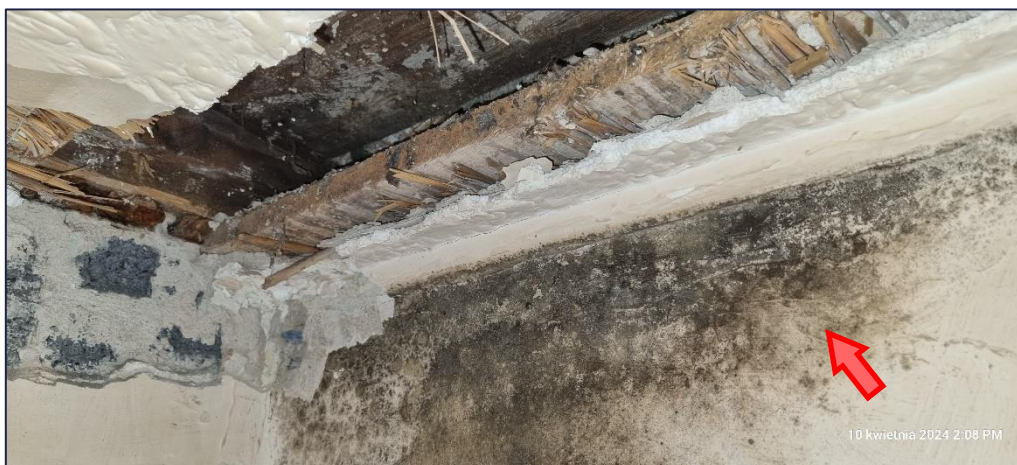
Foto 69. Widok stanu technicznego konstrukcji stropu nad parterem w miejscu oparcia belki na ścianie południowej budynku – odkrywka OS-2; Uszkodzenia przegród / elementów budynku zaznaczono kolorem czerwonym;
