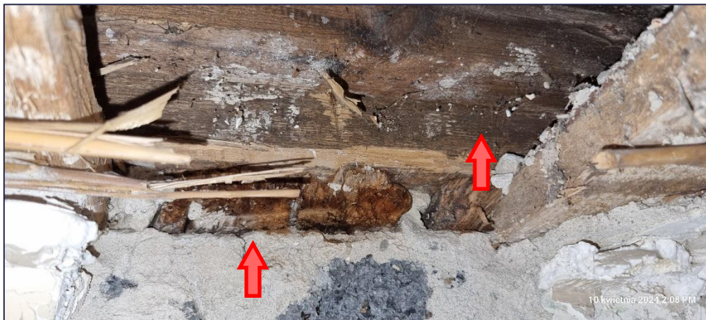
Foto 67. Widok stanu technicznego konstrukcji stropu nad parterem w miejscu oparcia belki na ścianie południowej budynku – odkrywka OS-2; Uszkodzenia przegród / elementów budynku zaznaczono kolorem czerwonym;
