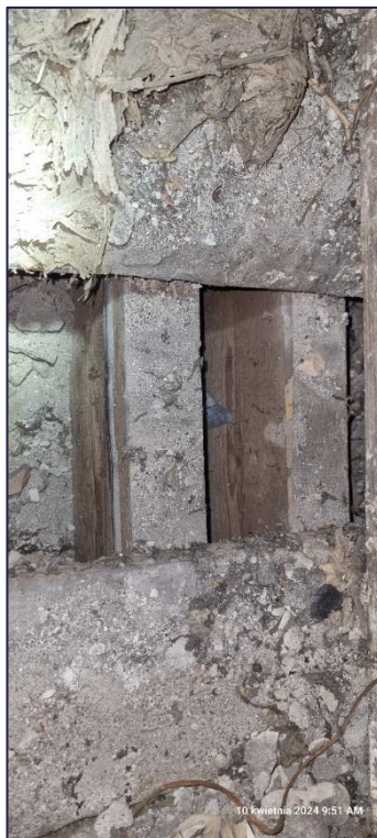
Foto 121. Widok stanu technicznego poszycia stropu nad poddaszem użytkowym; Widok deskowania górnego pułapu - powały na kleszczach i jętkach dachowych; Wizja wykonana z przestrzeni części nieużytkowej poddasza (strych) - odkrywka OW-1;
