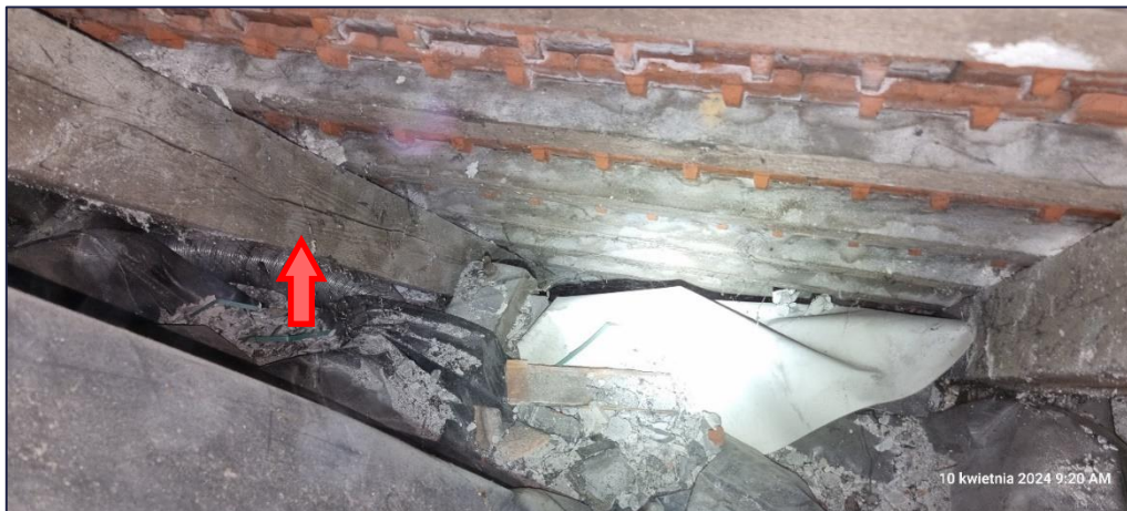
Foto 86. Widok stanu technicznego konstrukcji więźby dachowej; Uszkodzenia przegród / elementów budynku zaznaczono kolorem czerwonym; Wizja wykonana z przestrzeni części nieużytkowej poddasza (strych) – odkrywka OW-1;
