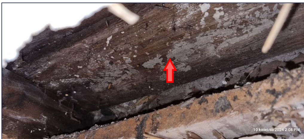
Foto 68. Widok stanu technicznego konstrukcji stropu nad parterem w miejscu oparcia belki na ścianie południowej budynku – odkrywka OS-2; Uszkodzenia przegród / elementów budynku zaznaczono kolorem czerwonym;
