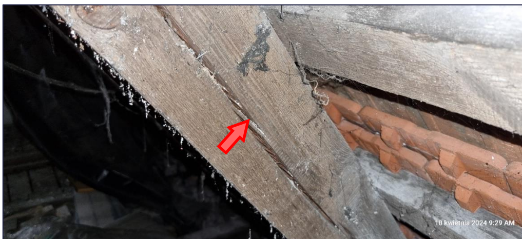
Foto 96. Widok stanu technicznego konstrukcji więźby dachowej; Uszkodzenia przegród / elementów budynku zaznaczono kolorem czerwonym; Wizja wykonana z przestrzeni części nieużytkowej poddasza (strych) – odkrywka OW-1;
