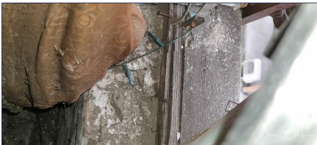
Foto 127. Widok stanu technicznego ściany szczytowej przy oknie; Wizja wykonana z przestrzeni części nieużytkowej poddasza (strych) – odkrywka OW-1;
