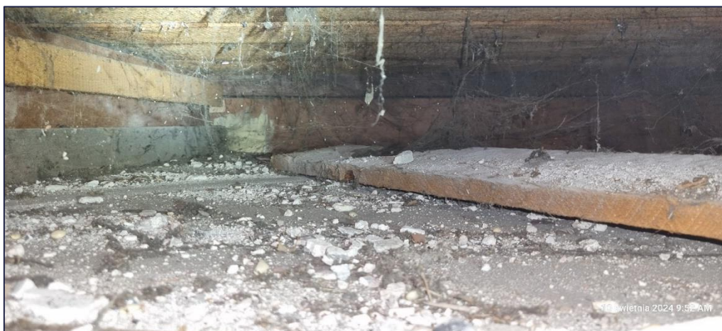
Foto 125. Widok stanu technicznego przestrzeni stropu nad poddaszem użytkowym; Wizja wykonana z przestrzeni części nieużytkowej poddasza (strych) – odkrywka OW-1;
