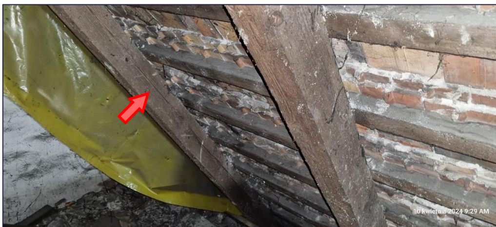
Foto 97. Widok stanu technicznego konstrukcji więźby dachowej; Uszkodzenia przegród / elementów budynku zaznaczono kolorem czerwonym; Wizja wykonana z przestrzeni części nieużytkowej poddasza (strych) – odkrywka OW-1;
