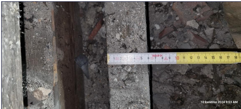
Foto 123. Widok stanu technicznego kleszczy więzara płatwiowo-kleszczowego; Pomiar szerokości kleszczy; Wizja wykonana z przestrzeni części nieużytkowej poddasza (strych) – odkrywka OW-1;
