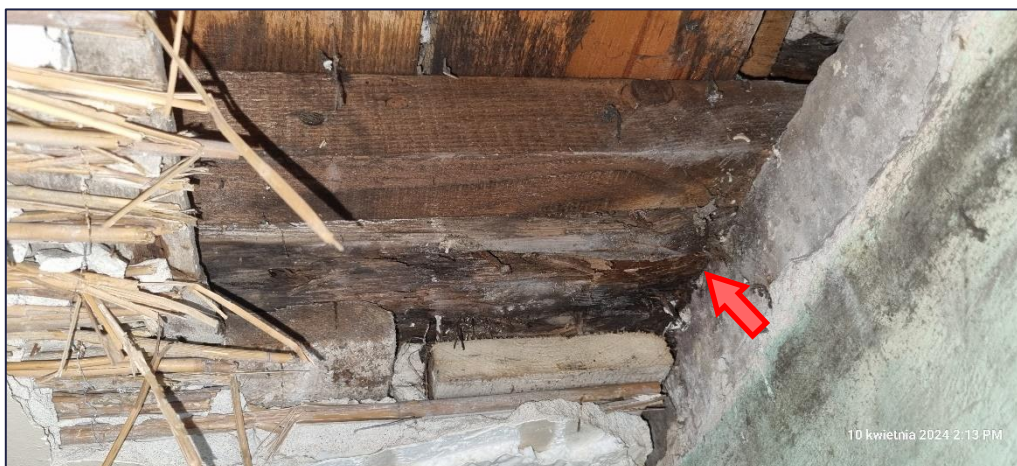
Foto 52. Widok stanu technicznego konstrukcji stropu nad parterem w miejscu oparcia belki na ścianie południowej budynku - odkrywka OS-1; Uszkodzenia przegród / elementów budynku zaznaczono kolorem czerwonym;
