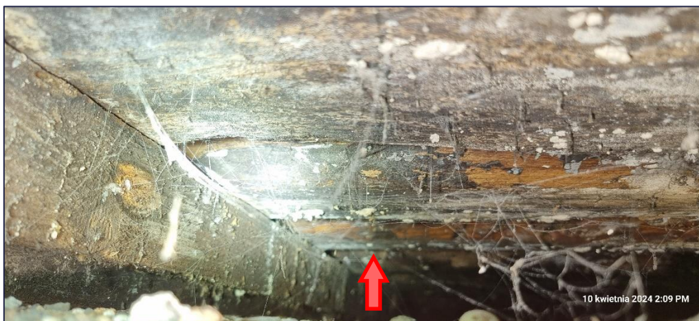
Foto 72. Widok stanu technicznego przestrzeni stropu nad parterem – odkrywka OS-2; Uszkodzenia przegród / elementów budynku zaznaczono kolorem czerwonym;
