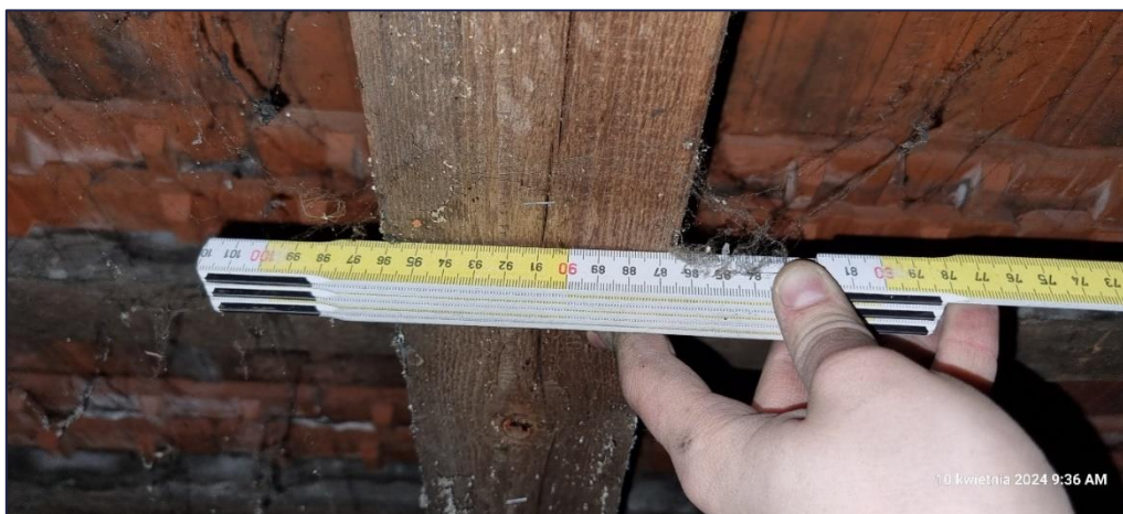
Foto 114. Widok stanu technicznego konstrukcji więźby dachowej; Pomiar rozpiętości między więzarami; Wizja wykonana z przestrzeni części nieużytkowej poddasza (strych) – odkrywka OW-1;
