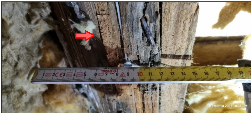
Foto 27. Widok stanu technicznego konstrukcji stropu nad piwnicą; Odkrywka przepony poziomej OS-1; Pomiar szerokości belki; Uszkodzenia przegród / elementów budynku zaznaczono kolorem czerwonym;
