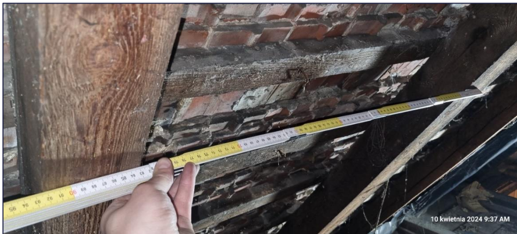
Foto 110. Widok stanu technicznego konstrukcji więźby dachowej; Pomiar rozpiętości między więzarami; Wizja wykonana z przestrzeni części nieużytkowej poddasza (strych) – odkrywka OW-1;
