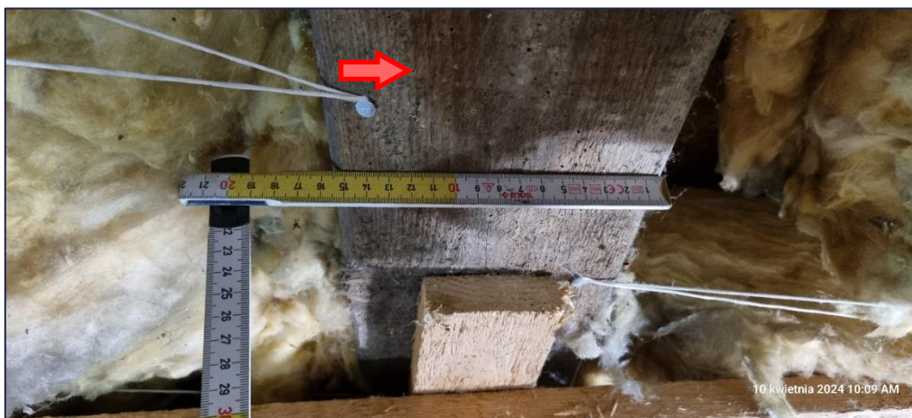
Foto 29. Widok stanu technicznego konstrukcji stropu nad piwnicą; Odkrywka przepony poziomej OS-1; Pomiar szerokości belki; Uszkodzenia przegród / elementów budynku zaznaczono kolorem czerwonym;
