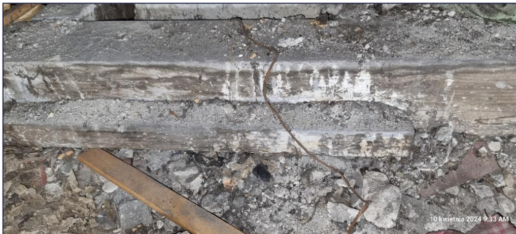
Foto 126. Widok stanu technicznego konstrukcji stropu nad poddaszem użytkowym; Wizja wykonana z przestrzeni części nieużytkowej poddasza (strych) – odkrywka OW-1;
