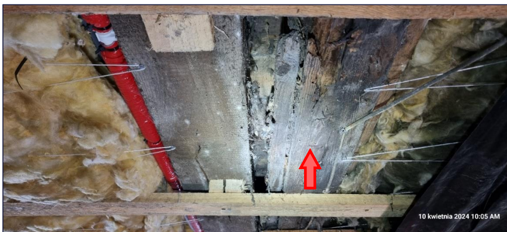
Foto 17. Widok stanu technicznego konstrukcji stropu nad piwnicą; Odkrywka przepony poziomej OS-1; Uszkodzenia przegród / elementów budynku zaznaczono kolorem czerwonym;
