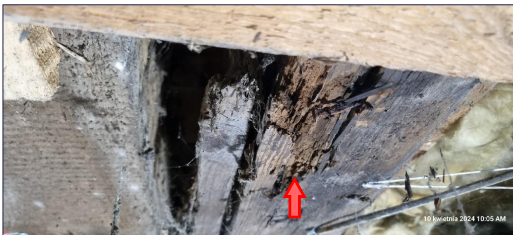
Foto 18. Widok stanu technicznego konstrukcji stropu nad piwnicą; Odkrywka przepony poziomej OS-1; Uszkodzenia przegród / elementów budynku zaznaczono kolorem czerwonym;
