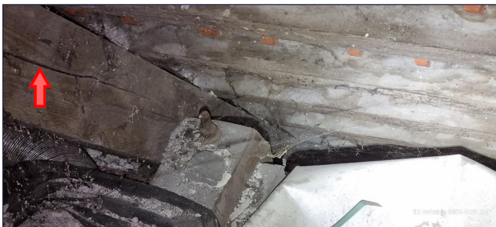
Foto 87. Widok stanu technicznego konstrukcji więźby dachowej; Uszkodzenia przegród / elementów budynku zaznaczono kolorem czerwonym; Wizja wykonana z przestrzeni części nieużytkowej poddasza (strych) – odkrywka OW-1;
