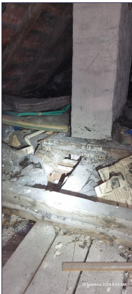
Foto 120. Widok stanu technicznego poszycia stropu nad poddaszem użytkowym; Widok deskowania górnego pułapu – powały na kleszczach i jętkach dachowych; Wizja wykonana z przestrzeni części nieużytkowej poddasza (strych) – odkrywka OW-1;
