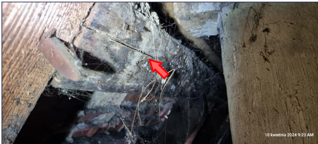
Foto 98. Widok stanu technicznego konstrukcji więźby dachowej; Uszkodzenia przegród / elementów budynku zaznaczono kolorem czerwonym; Wizja wykonana z przestrzeni części nieużytkowej poddasza (strych) – odkrywka OW-1;
