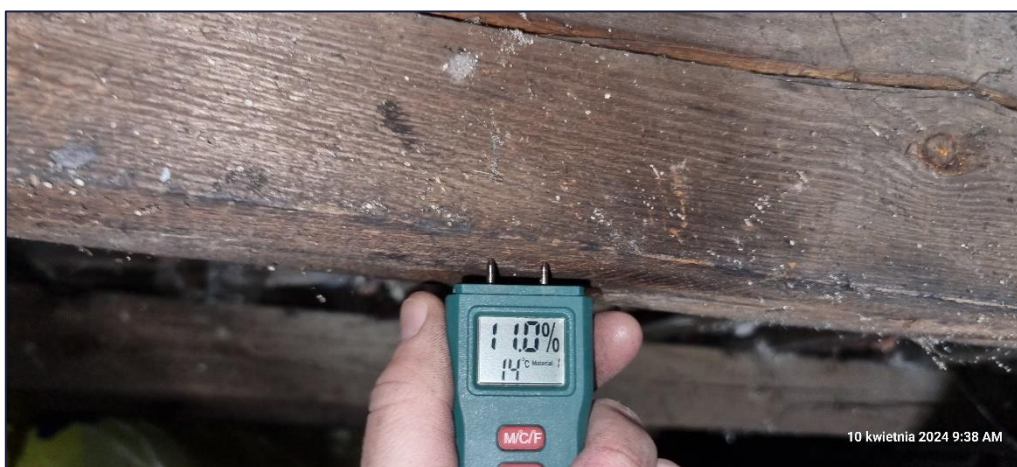
Foto 112. Widok stanu technicznego konstrukcji więźby dachowej; Pomiar wilgotności krokwi dachowych; Wizja wykonana z przestrzeni części nieużytkowej poddasza (strych) – odkrywka OW-1;
