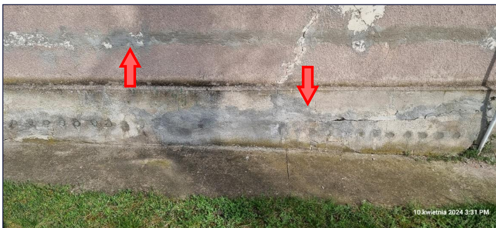
Foto 7. Widok stanu technicznego cokołu elewacji zachodniej budynku; Na zdjęciu widoczna część bliźniaka – budynek 12B; Na elewacji budynku widoczne pozostałości po wykonaniu ciśnieniowej izolacji poziomej ściany budynku;
