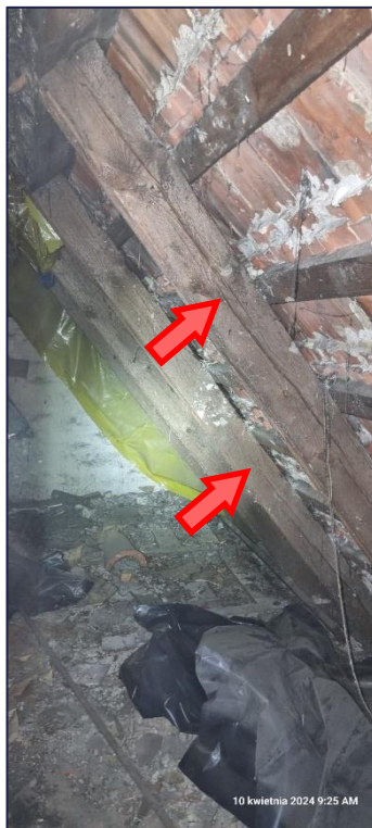
Foto 84. Widok stanu technicznego konstrukcji więźby dachowej; Uszkodzenia przegród / elementów budynku zaznaczono kolorem czerwonym; Wizja wykonana z przestrzeni części nieużytkowej poddasza (strych) – odkrywka OW-1;
