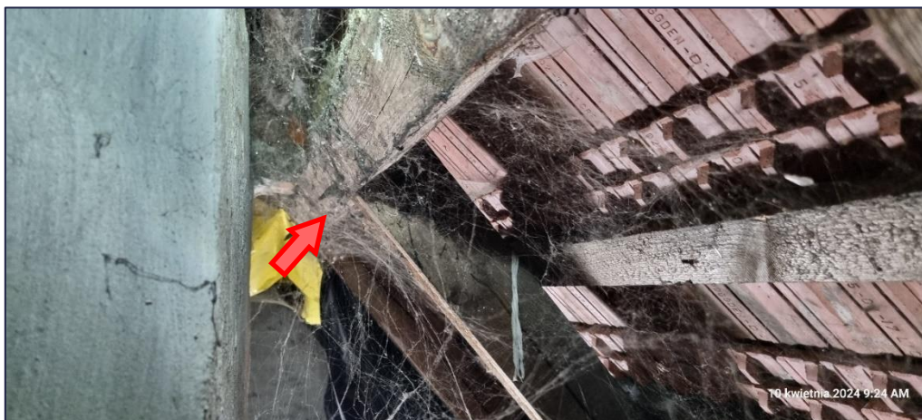
Foto 101. Widok stanu technicznego konstrukcji więźby dachowej; Uszkodzenia przegród / elementów budynku zaznaczono kolorem czerwonym; Wizja wykonana z przestrzeni części nieużytkowej poddasza (strych) – odkrywka OW-1;
