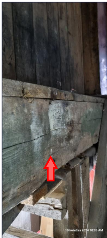
Foto 14. Widok stanu technicznego konstrukcji stropu nad piwnicą; Odkrywka przepony poziomej OS-1; Uszkodzenia przegród / elementów budynku zaznaczono kolorem czerwonym;
