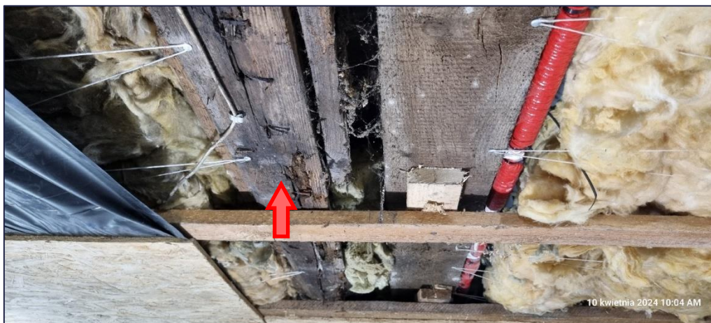
Foto 16. Widok stanu technicznego konstrukcji stropu nad piwnicą; Odkrywka przepony poziomej OS-1; Uszkodzenia przegród / elementów budynku zaznaczono kolorem czerwonym;
