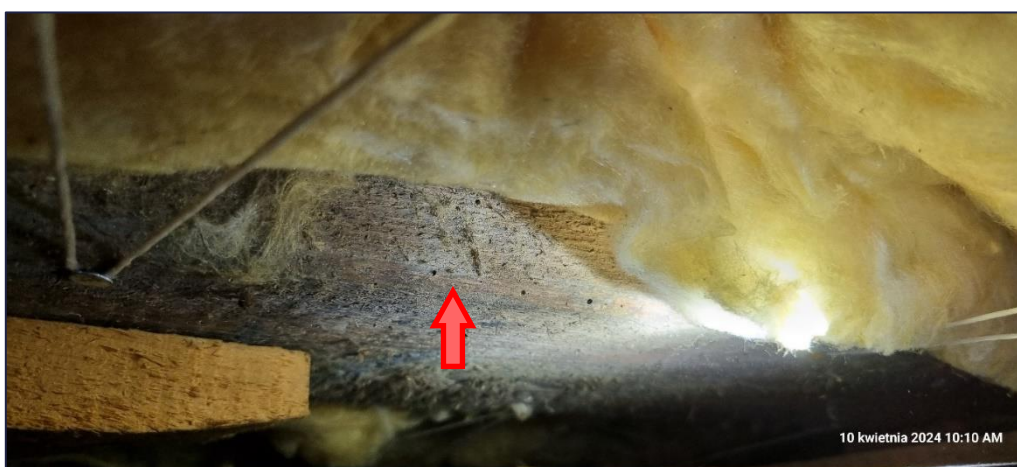
Foto 21. Widok stanu technicznego konstrukcji stropu nad piwnicą; Odkrywa przepony poziomej OS-1; Uszkodzenia przegród / elementów budynku zaznaczono kolorem czerwonym;
