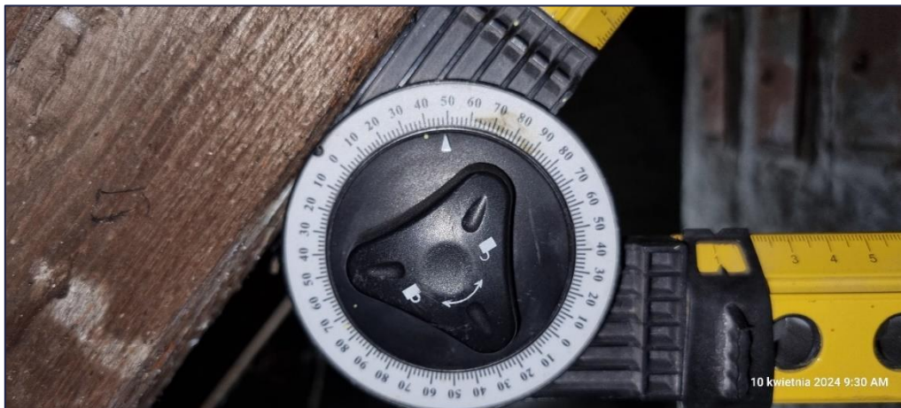
Foto 107. Widok stanu technicznego konstrukcji więźby dachowej; Pomiar nachylenia połaci dachu; Wizja wykonana z przestrzeni części nieużytkowej poddasza (strych) – odkrywka OW-1;
