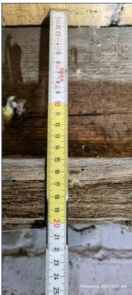
Foto 26. Widok stanu technicznego konstrukcji stropu nad piwnicą; Odkrywką przepony poziomej OS-1; Pomiar wysokości belki;
