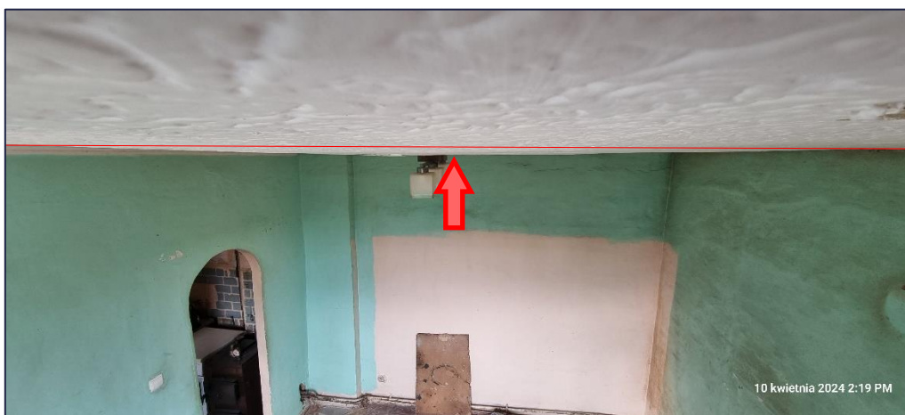
Foto 62. Widok stanu technicznego stropu nad parterem z pomieszczenia M2.04; Widok ugięcia stropu; Linia czerwona wskazuje prawidłową płaszczyznę stropu; Uszkodzenia przegród / elementów budynku zaznaczono kolorem czerwonym;
