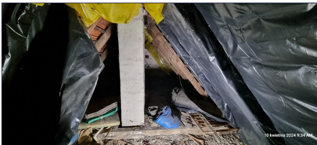
Foto 80. Widok stanu technicznego konstrukcji więźby dachowej; Wizja wykonana z przestrzeni części nieużytkowej poddasza (strych) – odkrywka OW-1;
