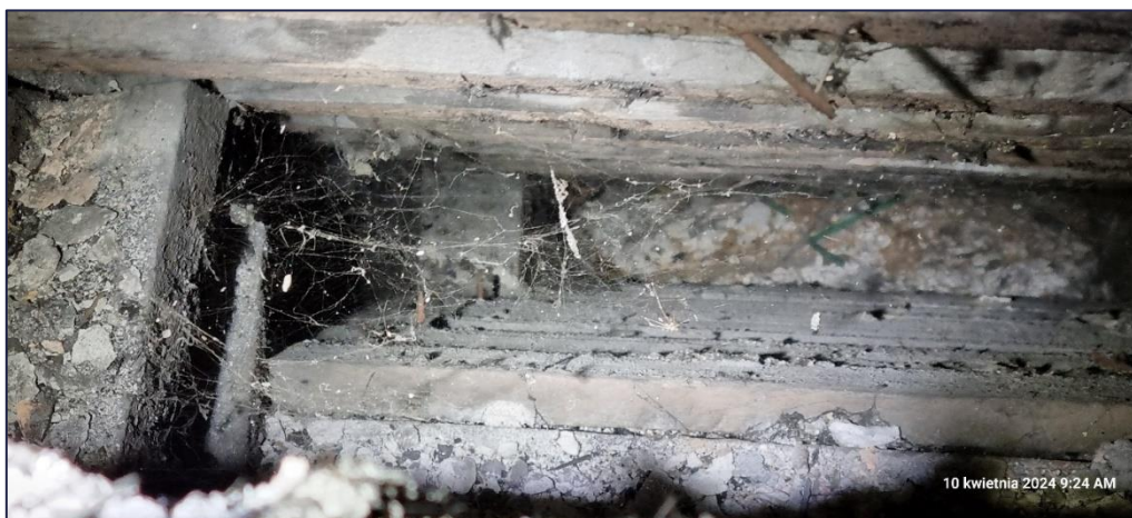
Foto 105. Widok stanu technicznego konstrukcji więźby dachowej; Wizja wykonana z przestrzeni części nieużytkowej poddasza (strych) – odkrywka OW-1;
