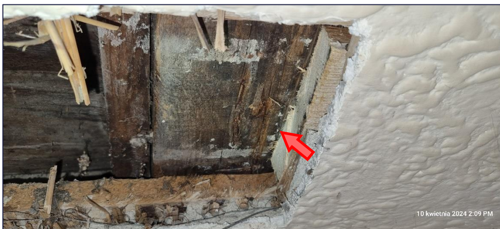
Foto 71. Widok stanu technicznego konstrukcji stropu nad parterem w miejscu oparcia belki na ścianie południowej budynku – odkrywka OS-2; Uszkodzenia przegród / elementów budynku zaznaczono kolorem czerwonym;
