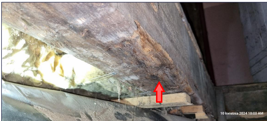
Foto 11. Widok stanu technicznego konstrukcji stropu nad piwnicą; Odkrywka przepony poziomej OS-1; Uszkodzenia przegród / elementów budynku zaznaczono kolorem czerwonym;
