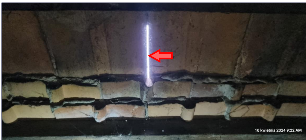
Foto 91. Widok stanu technicznego pokrycia dachu; Uszkodzenia przegród / elementów budynku zaznaczono kolorem czerwonym; Wizja wykonana z przestrzeni części nieużytkowej poddasza (strych) – odkrywka OW-1;
