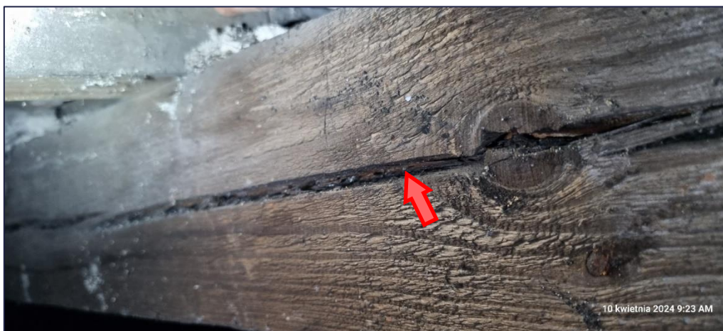
Foto 93. Widok stanu technicznego konstrukcji więźby dachowej; Uszkodzenia przegród / elementów budynku zaznaczono kolorem czerwonym; Wizja wykonana z przestrzeni części nieużytkowej poddasza (strych) – odkrywka OW-1;
