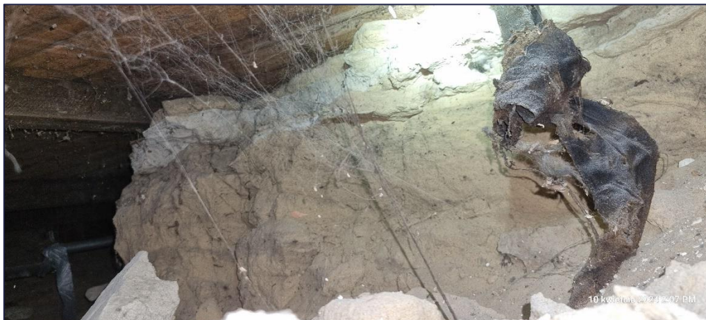
Foto 79. Widok stanu technicznego posadzki na gruncie w pomieszczeniu M2.03; Odkrywka posadzki na gruncie – odkrywka OP-2;
