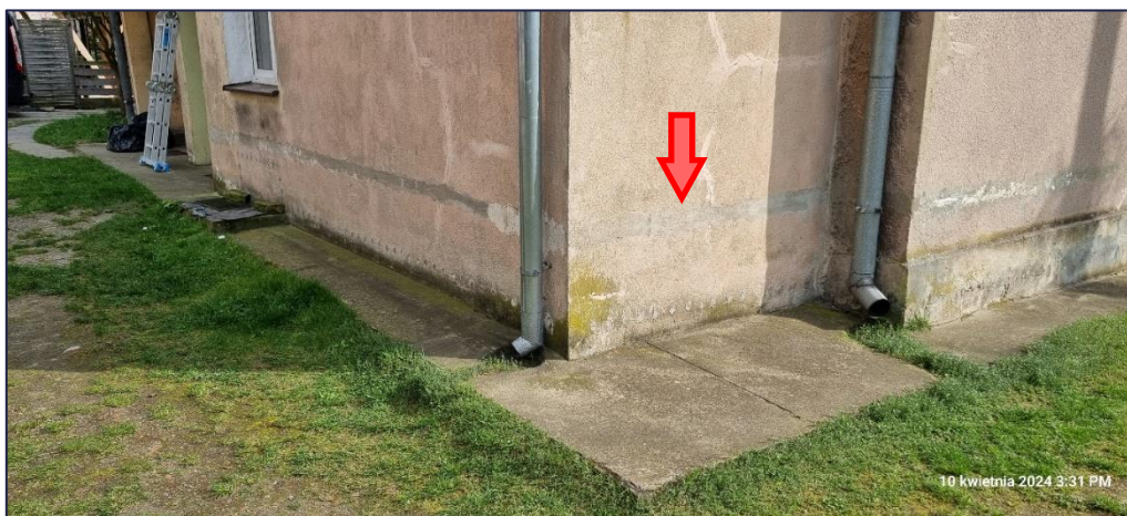
Foto 6. Widok stanu technicznego elewacji północnej i zachodniej budynku; Na zdjęciu widoczna część bliźniaka – budynek 12B; Na elewacji budynku widoczne pozostałości po wykonaniu ciśnieniowej izolacji poziomej ściany budynku;
