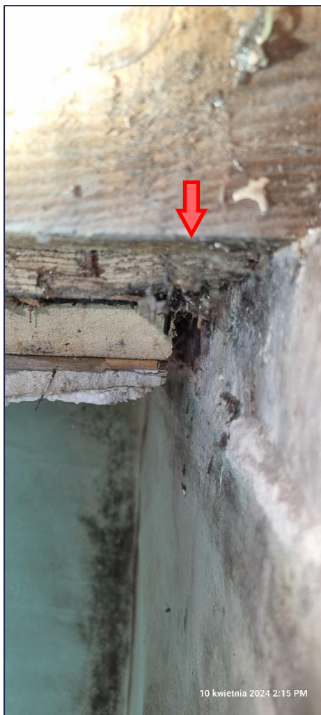
Foto 59. Widok stanu technicznego konstrukcji stropu nad parterem w miejscu oparcia belki na ścianie południowej budynku – odkrywka OS-1; Uszkodzenia przegród / elementów budynku zaznaczono kolorem czerwonym;
