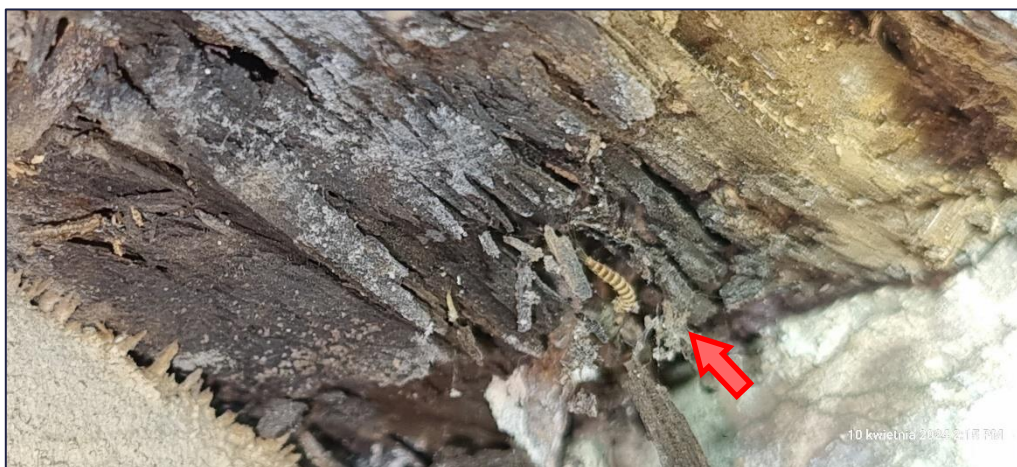
Foto 56. Widok stanu technicznego konstrukcji stropu nad parterem w miejscu oparcia belki na ścianie południowej budynku – odkrywka OS-1; Uszkodzenia przegród / elementów budynku zaznaczono kolorem czerwonym;
