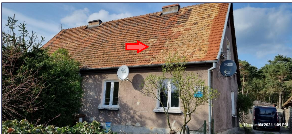
Foto 3. Widok stanu technicznego elewacji południowej budynku; Uszkodzenia przegród / elementów budynku zaznaczono kolorem czerwonym;
