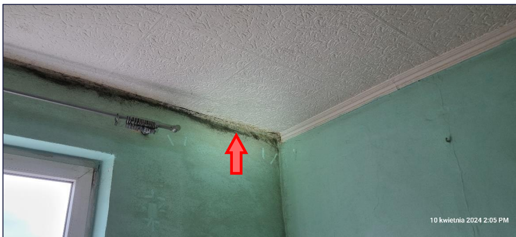
Foto 63. Widok stanu technicznego przegród budowlanych z pomieszczenia M2.04; Uszkodzenia przegród / elementów budynku zaznaczono kolorem czerwonym;
