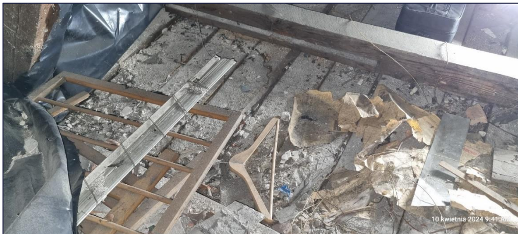
Foto 119. Widok stanu technicznego poszycia stropu nad poddaszem użytkowym; Widok deskowania górnego pułapu – powały na kleszczach i jętkach dachowych; Wizja wykonana z przestrzeni części nieużytkowej poddasza (strych) – odkrywka OW-1;
