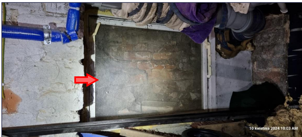
Foto 40. Widok stanu technicznego muru oporowego doświetla piwnicznego; Uszkodzenia przegród / elementów budynku zaznaczono kolorem czerwonym;
