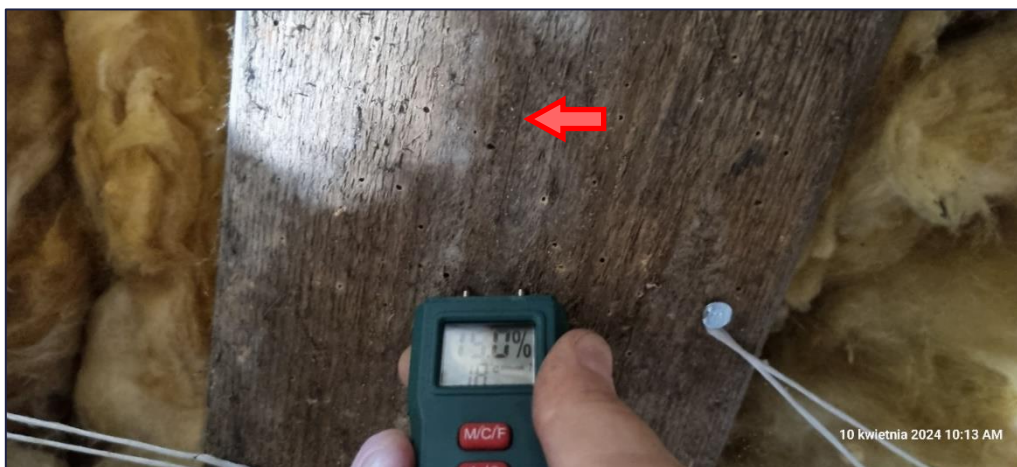
Foto 32. Widok stanu technicznego konstrukcji stropu nad piwnicą; Pomiar wilgotności elementów – pomiar PW-1; Uszkodzenia przegród / elementów budynku zaznaczono kolorem czerwonym;
