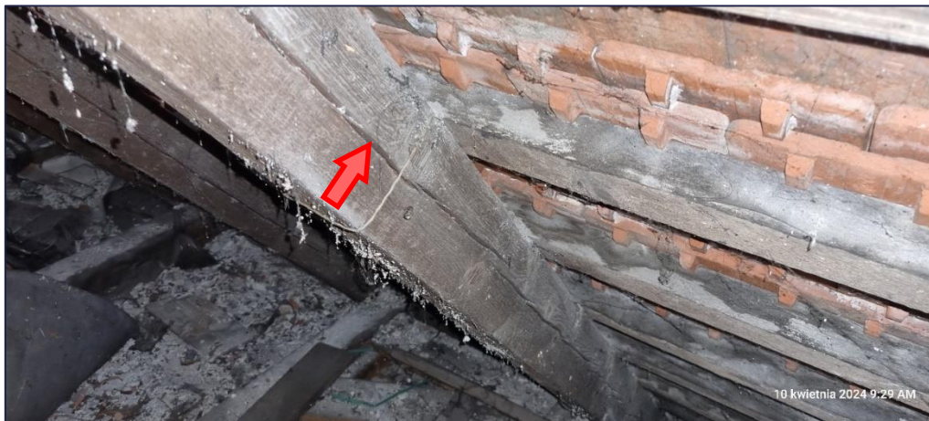
Foto 95. Widok stanu technicznego konstrukcji więźby dachowej; Uszkodzenia przegród / elementów budynku zaznaczono kolorem czerwonym; Wizja wykonana z przestrzeni części nieużytkowej poddasza (strych) – odkrywka OW-1;
