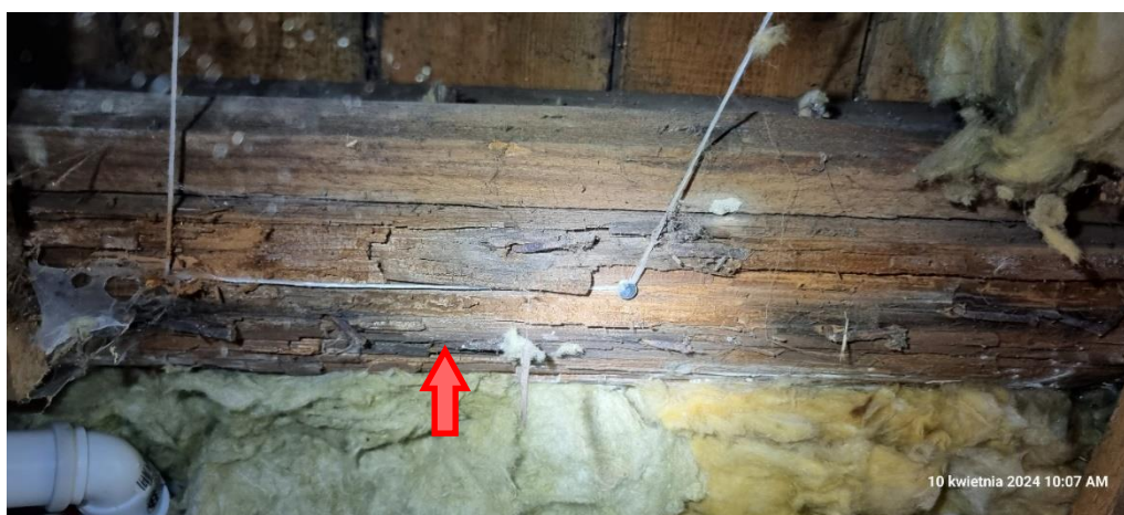
Foto 23. Widok stanu technicznego konstrukcji stropu nad piwnicą; Odkrywką przepony poziomej OS-1; Uszkodzenia przegród / elementów budynku zaznaczono kolorem czerwonym;
