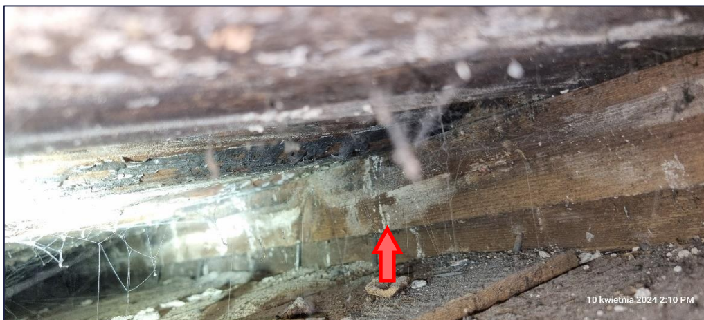
Foto 73. Widok stanu technicznego przestrzeni stropu nad parterem – odkrywka OS-2; Uszkodzenia przegród / elementów budynku zaznaczono kolorem czerwonym;
