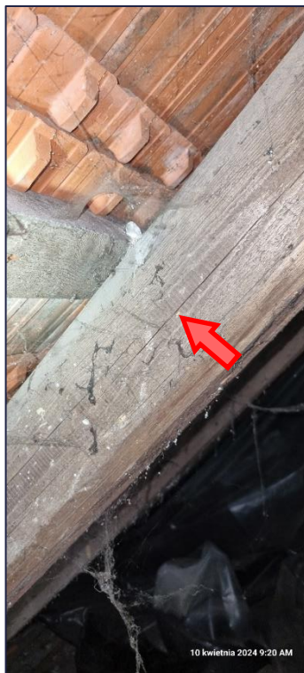
Foto 85. Widok stanu technicznego konstrukcji więźby dachowej; Uszkodzenia przegród / elementów budynku zaznaczono kolorem czerwonym; Wizja wykonana z przestrzeni części nieużytkowej poddasza (strych) – odkrywka OW-1;
