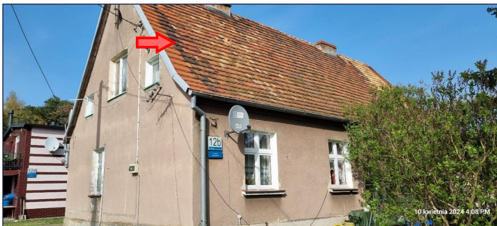
Foto 8. Widok stanu technicznego południowej elewacji i połaci dachu; Na zdjęciu widoczna część bliźniaka – budynek 12B; Uszkodzenia przegród / elementów budynku zaznaczono kolorem czerwonym;
