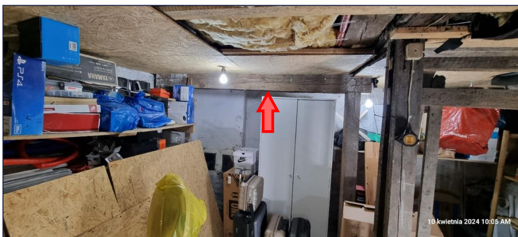
Foto 36. Widok stanu technicznego konstrukcji stropu nad piwnicą; Widok konstrukcji podpierającej główne elementy nośne stropu; Uszkodzenia przegród / elementów budynku zaznaczono kolorem czerwonym;
