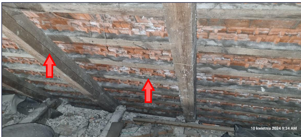
Foto 82. Widok stanu technicznego konstrukcji więźby dachowej; Uszkodzenia przegród / elementów budynku zaznaczono kolorem czerwonym; Wizja wykonana z przestrzeni części nieużytkowej poddasza (strych) – odkrywka OW-1;
