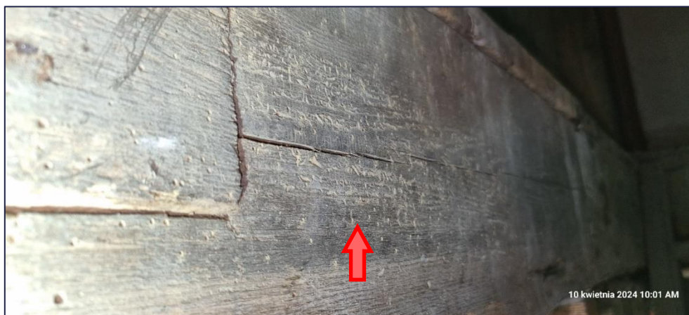
Foto 12. Widok stanu technicznego konstrukcji stropu nad piwnicą; Odkrywka przepony poziomej OS-1; Uszkodzenia przegród / elementów budynku zaznaczono kolorem czerwonym;
