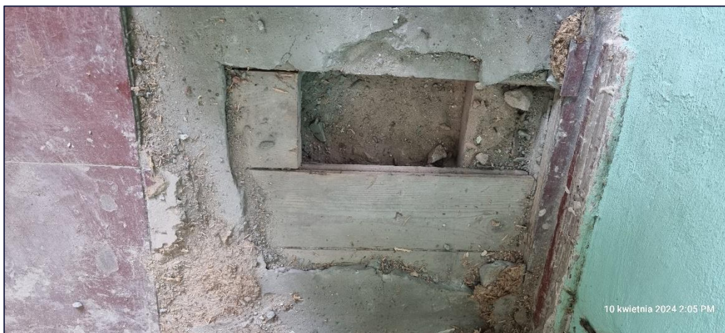
Foto 47. Widok stanu technicznego posadzki na gruncie w pomieszczeniu M2.04; Odkrywka posadzki na gruncie – odkrywka OP-1;
