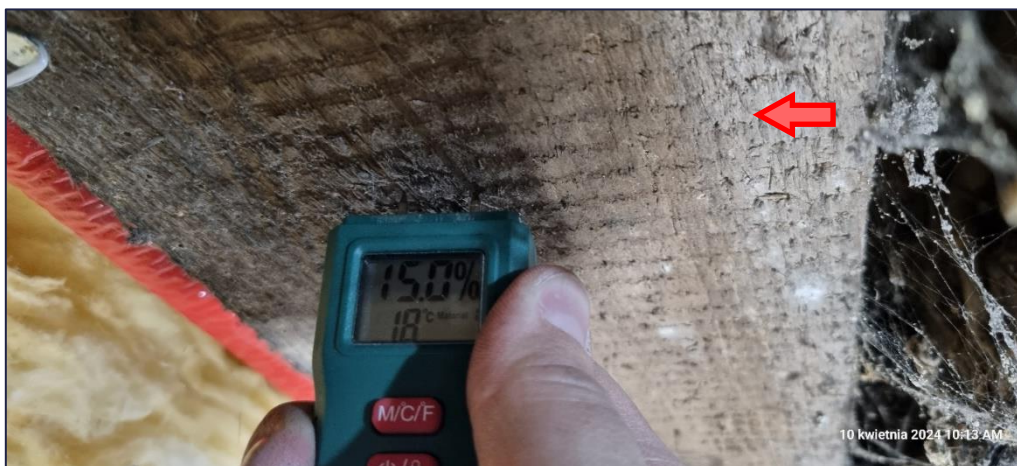
Foto 31. Widok stanu technicznego konstrukcji stropu nad piwnicą; Pomiar wilgotności elementów – pomiar PW-1; Uszkodzenia przegród / elementów budynku zaznaczono kolorem czerwonym;
