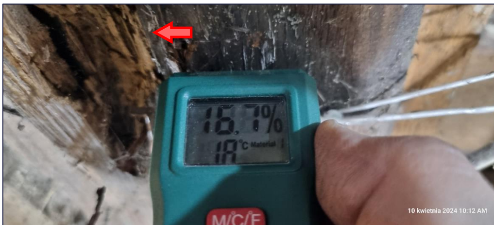
Foto 30. Widok stanu technicznego konstrukcji stropu nad piwnicą; Pomiar wilgotności elementów – pomiar PW-1; Uszkodzenia przegród / elementów budynku zaznaczono kolorem czerwonym;
