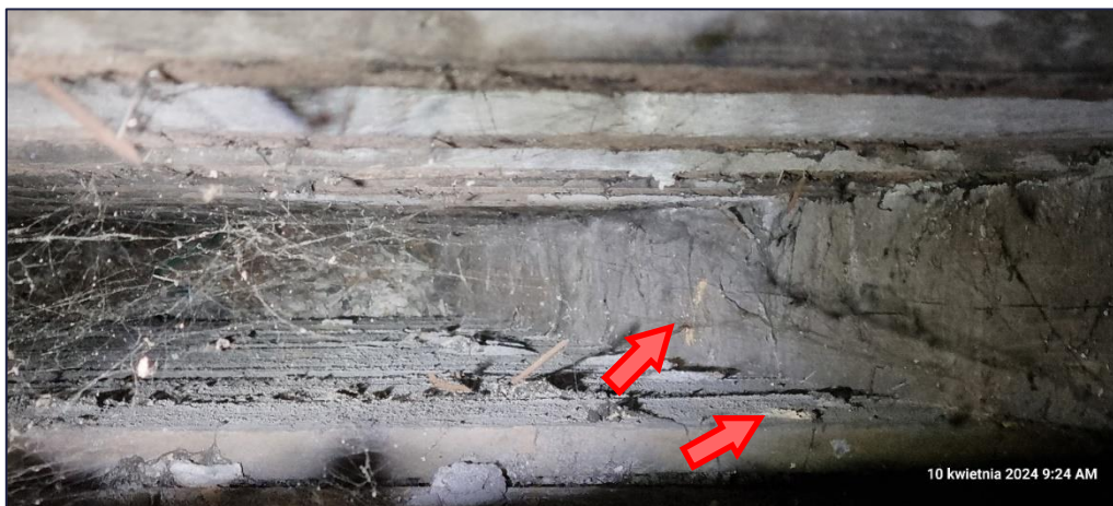
Foto 104. Widok stanu technicznego konstrukcji więźby dachowej; Uszkodzenia przegród / elementów budynku zaznaczono kolorem czerwonym; Wizja wykonana z przestrzeni części nieużytkowej poddasza (strych) – odkrywka OW-1;
