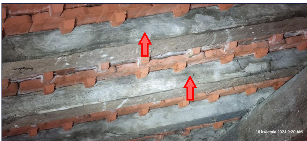
Foto 88. Widok stanu technicznego konstrukcji więźby dachowej; Uszkodzenia przegród / elementów budynku zaznaczono kolorem czerwonym; Wizja wykonana z przestrzeni części nieużytkowej poddasza (strych) – odkrywka OW-1;
