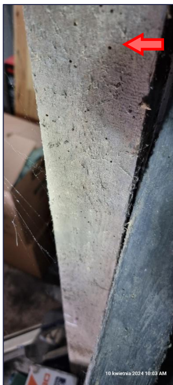
Foto 34. Widok stanu technicznego konstrukcji stropu nad piwnicą; Widok konstrukcji podpierającej główne elementy nośne stropu; Uszkodzenia przegród / elementów budynku zaznaczono kolorem czerwonym;
