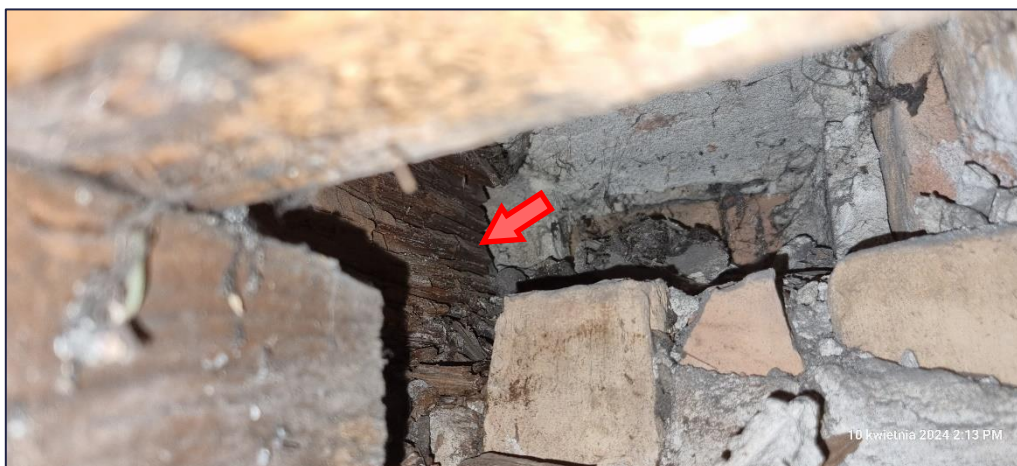
Foto 55. Widok stanu technicznego konstrukcji stropu nad parterem w miejscu oparcia belki na ścianie południowej budynku – odkrywka OS-1; Uszkodzenia przegród / elementów budynku zaznaczono kolorem czerwonym;
