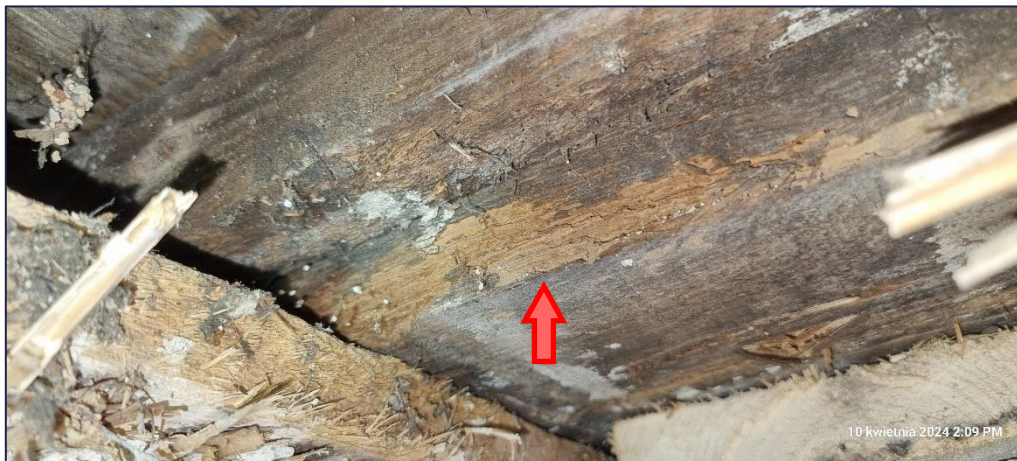
Foto 70. Widok stanu technicznego konstrukcji stropu nad parterem w miejscu oparcia belki na ścianie południowej budynku – odkrywka OS-2; Uszkodzenia przegród / elementów budynku zaznaczono kolorem czerwonym;
