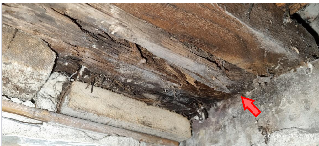
Foto 53. Widok stanu technicznego konstrukcji stropu nad parterem w miejscu oparcia belki na ścianie południowej budynku - odkrywka OS-1; Uszkodzenia przegród / elementów budynku zaznaczono kolorem czerwonym;
