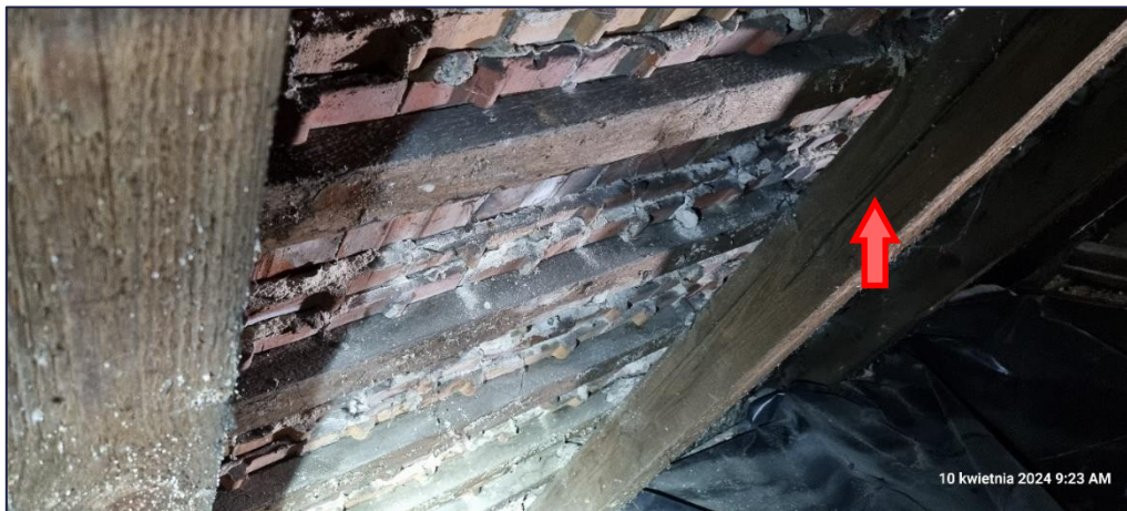
Foto 92. Widok stanu technicznego konstrukcji więźby dachowej; Uszkodzenia przegród / elementów budynku zaznaczono kolorem czerwonym; Wizja wykonana z przestrzeni części nieużytkowej poddasza (strych) – odkrywka OW-1;
