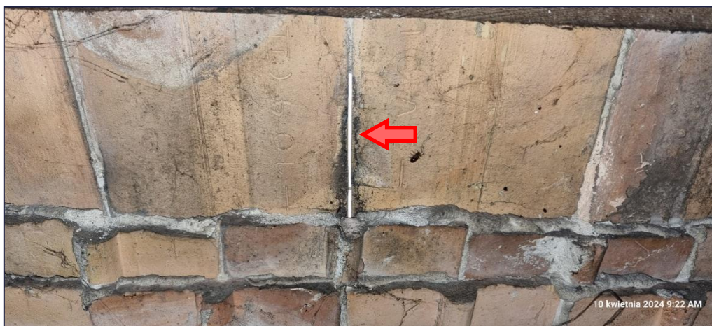
Foto 90. Widok stanu technicznego pokrycia dachu; Uszkodzenia przegród / elementów budynku zaznaczono kolorem czerwonym; Wizja wykonana z przestrzeni części nieużytkowej poddasza (strych) – odkrywka OW-1;
