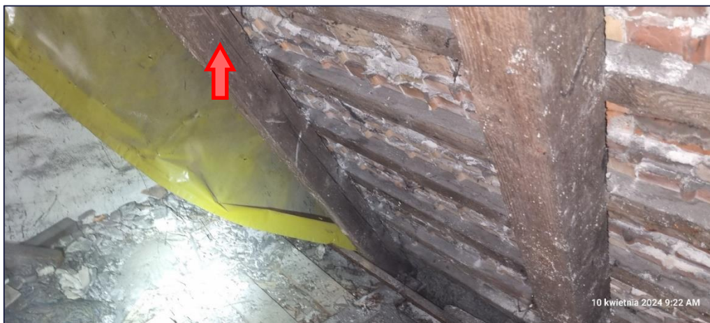
Foto 89. Widok stanu technicznego konstrukcji więźby dachowej; Uszkodzenia przegród / elementów budynku zaznaczono kolorem czerwonym; Wizja wykonana z przestrzeni części nieużytkowej poddasza (strych) – odkrywka OW-1;
