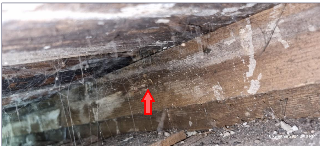
Foto 74. Widok stanu technicznego przestrzeni stropu nad parterem – odkrywka OS-2; Uszkodzenia przegród / elementów budynku zaznaczono kolorem czerwonym;
