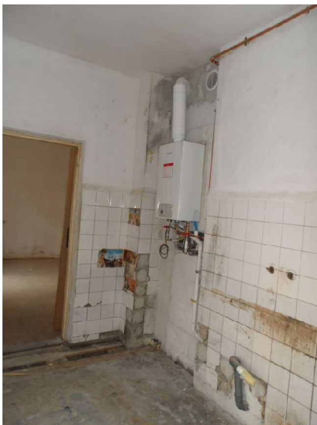
Kuchnia – piec gazowy do wymiany, widoczne po lewej stronie drzwi do pokoju – do zamurowania
