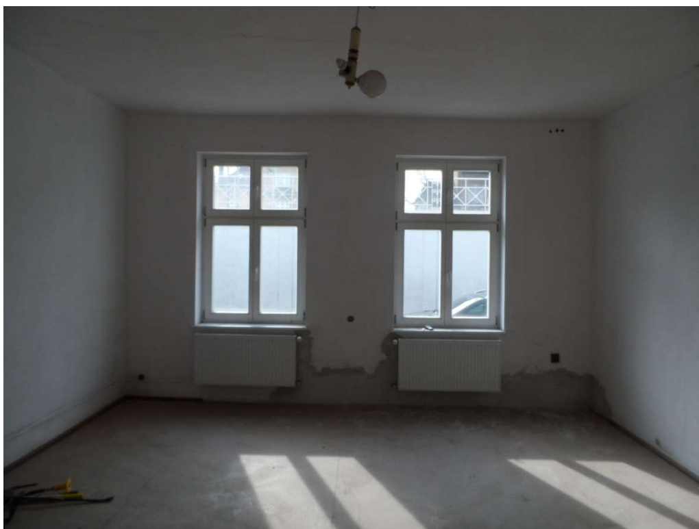
Pokój (I-05) – ściana „okienna” do ocieplenia od wewnątrz
