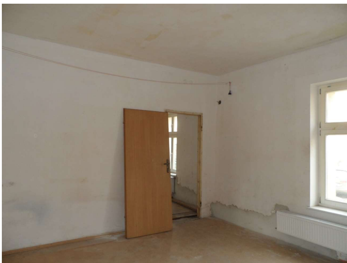
Pokój (I-04) – widoczny otwór drzwiowy (do kuchni) – do zamurowania
