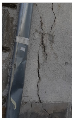
Zdj. nr 7 pęknięcia ścian zewnętrznych
