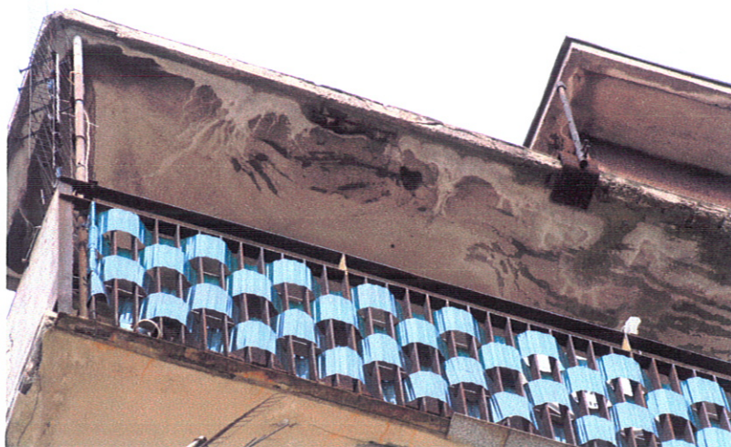
foto. 9. WIDOK PODNIEBIENIA DASZKA NA BALKONEM Widoczny brak izolacji i opierzenia
