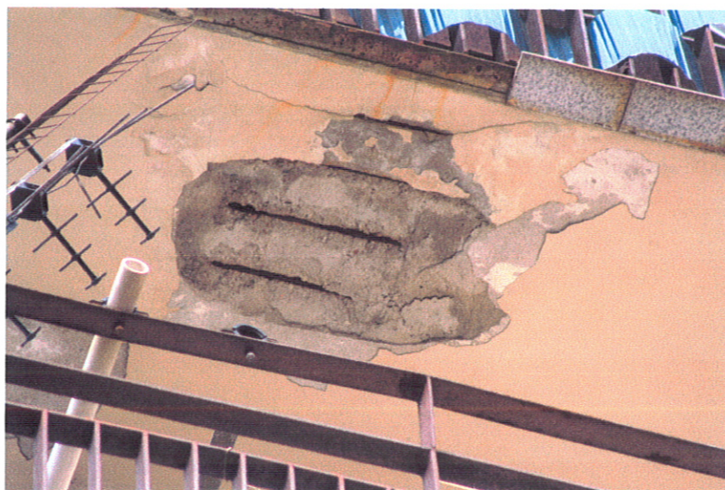
foť. 8. WIDOK PODNIEBIENIA BALKONU Uszkodzenia płyty
