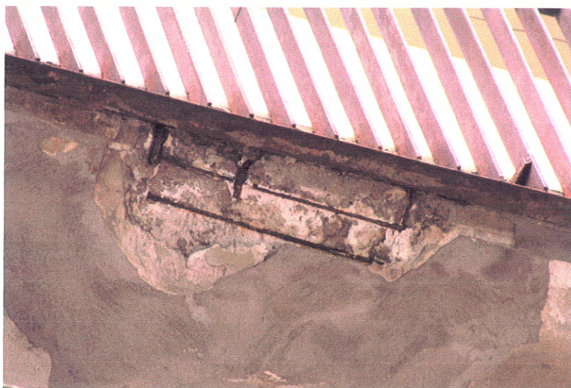
foť. 7. ZŁY STAN TECHNICZNY PODNIEBIENIA BALKONU Uszkodzenia płyty
