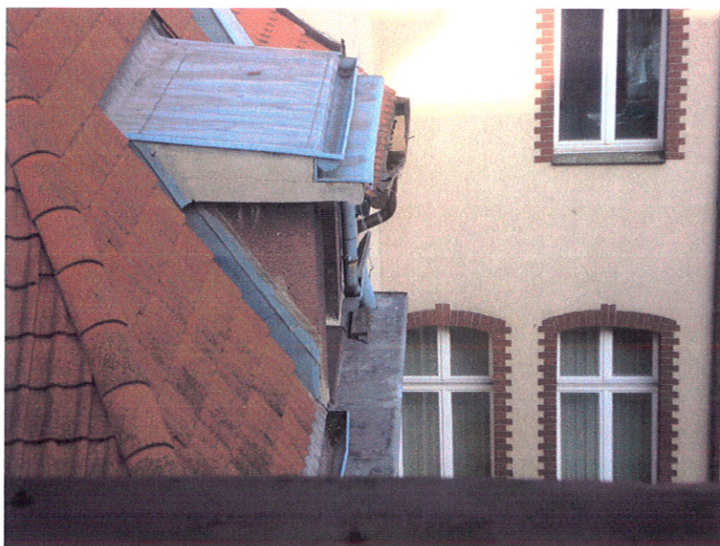
fot. 14. OPIERZENIA GZYMSU Zły stan techniczny obróbek blacharskich
