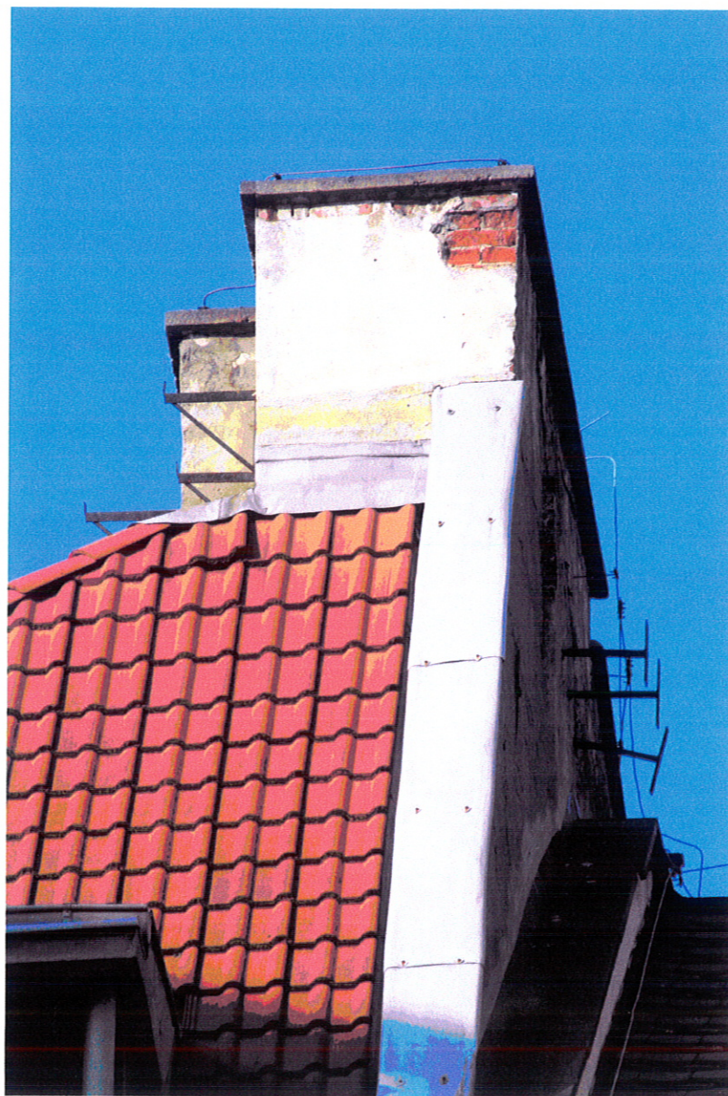
fol. 12. KOMIN ORAZ ŚCIANA PÓŁNOCNA Z WIDOKIEM NA ŚCIANĘ ATTYKOWĄ BUDYNKU SĄSIEDNIEGO Odspojony tynk komina, brak ław kominiarskich, zniszczone wsporniki ław.
