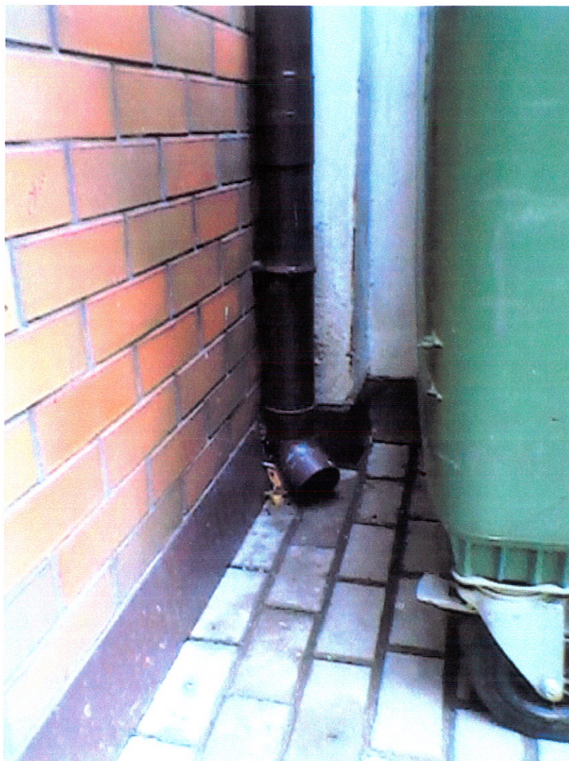
fof. 17. WYRZUT WODY Z RURY SPUSTOWEJ ŚCIANY WSCHODNIEJ NA DZIEDZINIEC CENTROMORU
