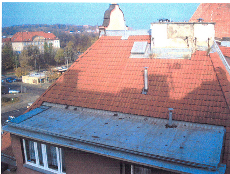
foto. 10. DACH BUDYNKU Luźne gąsio od strony ul. Okopowej
