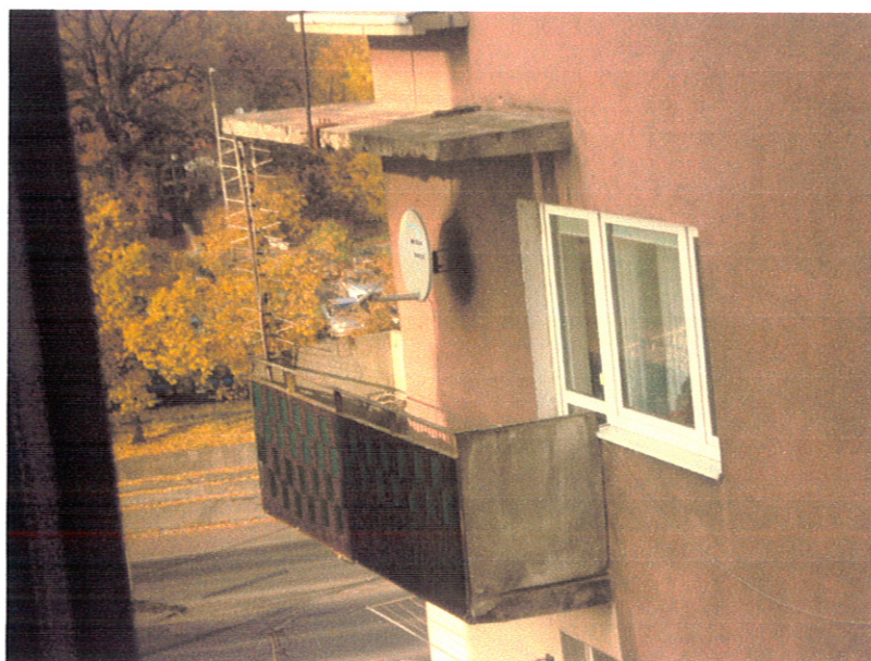
foto. 6. BALKON I DASZEK NAD NIM. Widoczny brak izolacji i opierzenia daszka
