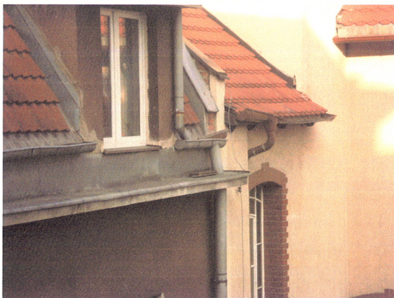
foto. 15. RYNNA I OPIERZENIE GZYMSU ŚCIANY WSCHODNIEJ
